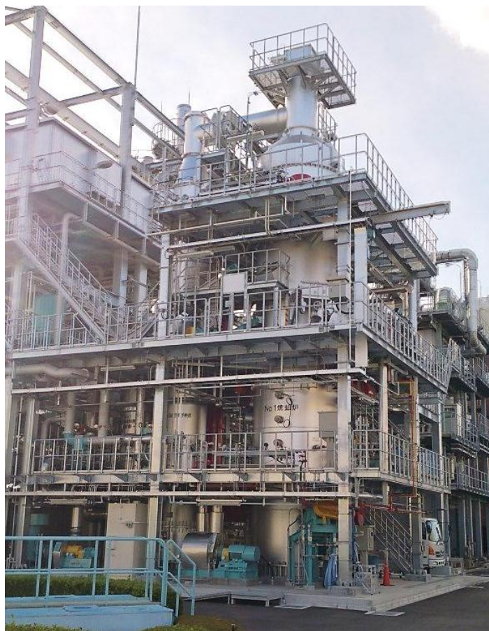
図 2-7 低空気比省エネ燃焼設備（実証設備）
