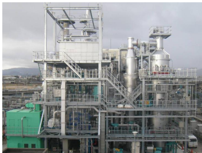
図 2-3 実証設備（25 t-wet/d 規模）外観
