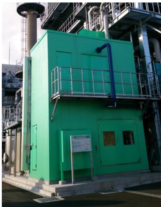
図 2-11 高効率排熱発電設備（実証設備）
