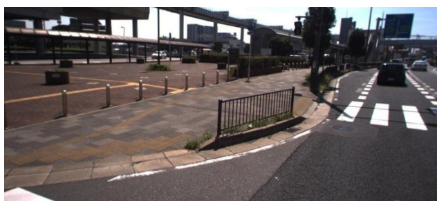
図 31 区画線が劣化している事例
