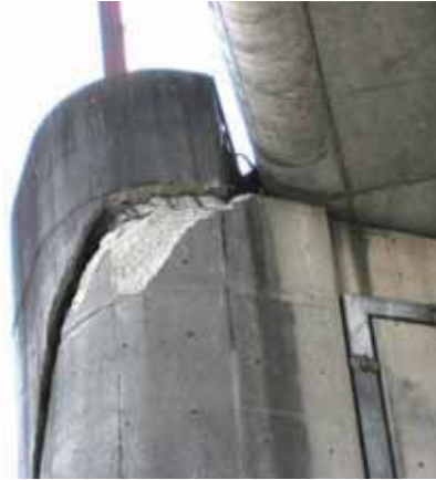
写真-4.3.8.4 ブロック取付部のせん断破壊(北西)
