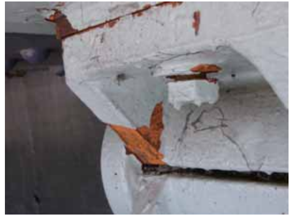
写真-4.4.13.9 左岸側橋台部支承セットボルトの抜出し
