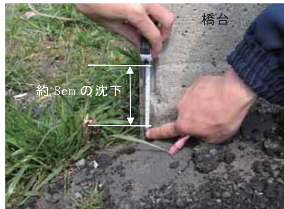
写真-4.3.6.3 橋台周辺土の沈下
