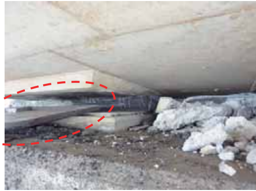
写真-4.3.14.13 A1橋台部のゴム支承の内部鋼板の飛び出し(写真提供：福島県)
