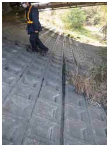
写真-4.3.10.6 橋台前面護岸の変状
