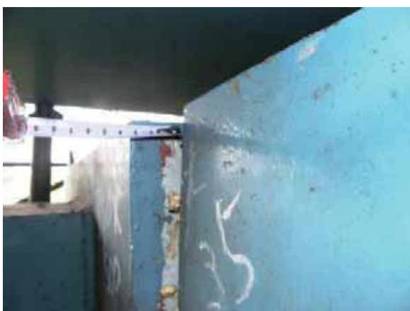
写真-4.3.15.10 落橋防止構造取り付けブラケットの前面へのずれ (A2 側)
