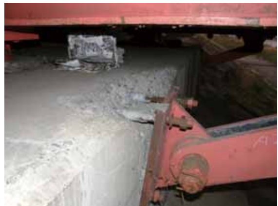
写真-4.3.17.5 アンカーの引き抜きの 状況 (A2 橋台 G2 桁)
