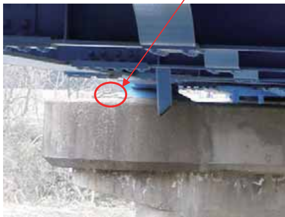
写真-4.1.8.6 P1 橋脚上の固定支承：沓座モルタルが破損
