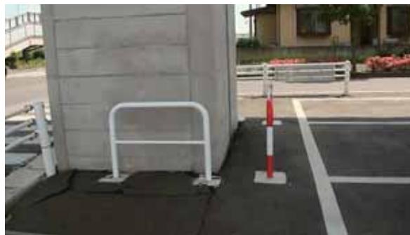
写真-4.3.14.10 P6 橋脚基部周りのアスファルトの損傷
