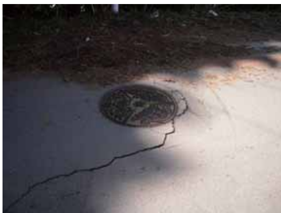
写真-4.4.4.9 右岸側のマンホールの浮き
