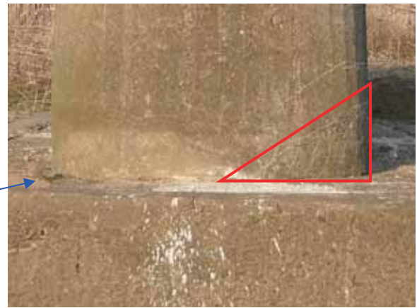
写真-4.2.11.17 P6 橋脚基部(下流側より) : P7 側のみに著しい損傷(コンクリートのひび割れ、浮き等)
