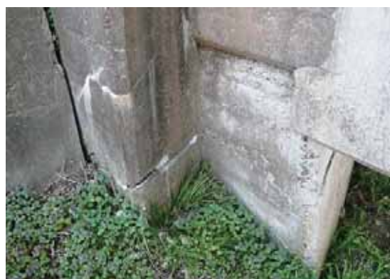
写真-4.4.17.8 橋台躯体の水平ひび割れ（左岸側橋台）
