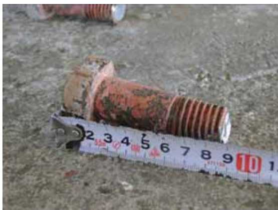
写真-4.4.3.14 破断した上沓のセットボルト
