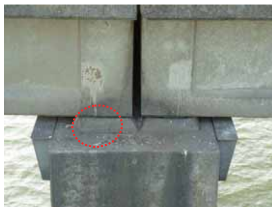
写真-4.4.32.7 橋脚上沓座モルタルのひび割れ
