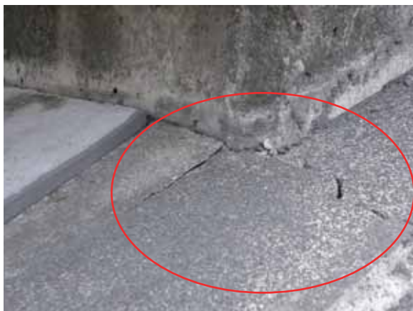
写真-4.2.12.10 A1 橋台たて壁前面角部：前面の堤体コンクリートに割れ・浮きが生じている
