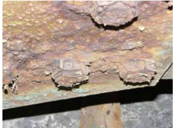
写真-4. 2. 10. 13 主桁と横鋼接合部の腐食状況
