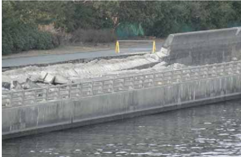
写真-4.5.4.3 花見川護岸(右岸側)の損傷状況(磯部橋の50m程度上流)
