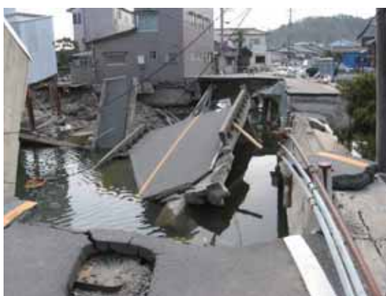
写真-4.3.5.1 崩壊した上部構造
