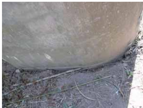
写真-4. 4. 5. 32 橋脚と地面のすき間
