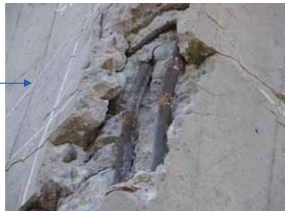
写真-4.2.11.19 P6 橋脚中間部の鉄筋露出、座屈
