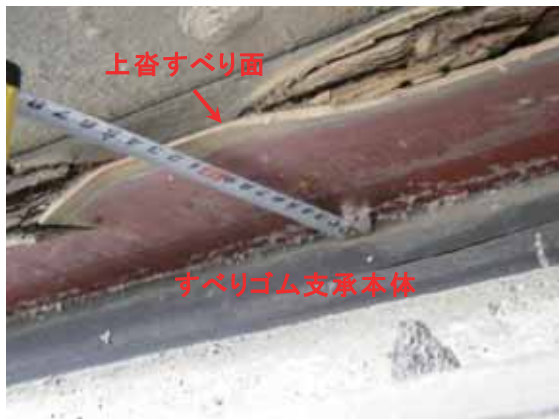
写真-4.1.9.4 左岸側橋台支承の移動の痕跡(約 1cm)
