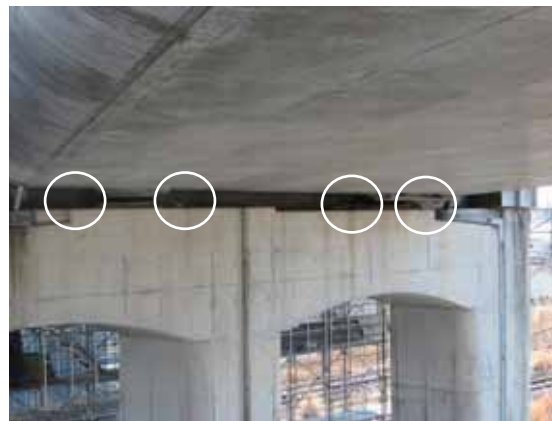
写真-4.3.8.12 サイドストッパーの破損（跨線部橋脚西側取付部）
