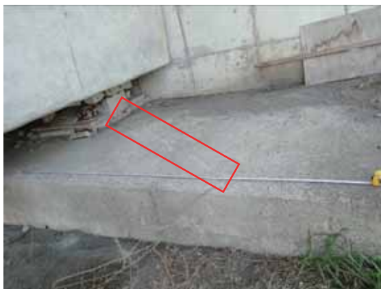
写真-4.4.3.6 A1 橋台橋座部の斜めひび割れ(幅 2mm 程度)
