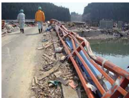
写真-4.2.2.2 高欄の変形状況
