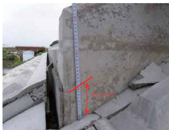
写真-4. 4. 10. 3 右岸側橋台部護岸の破損と沈下
