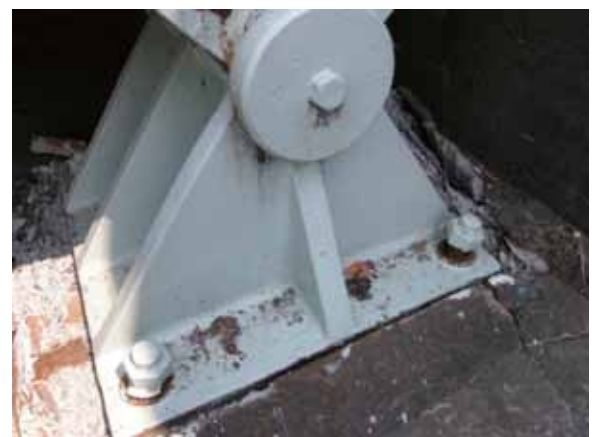
写真-4. 4. 13. 7 左岸側橋台部支承の損傷
