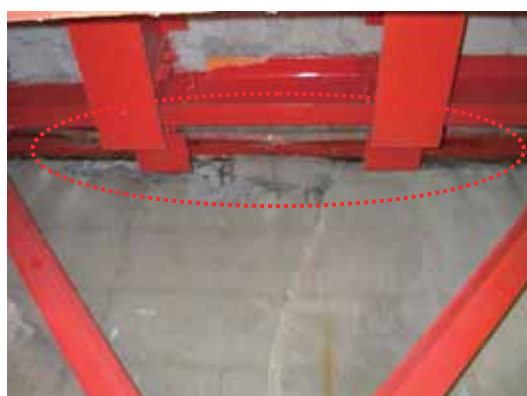
写真-4.5.1.4 A1 橋台パラペットの損傷
