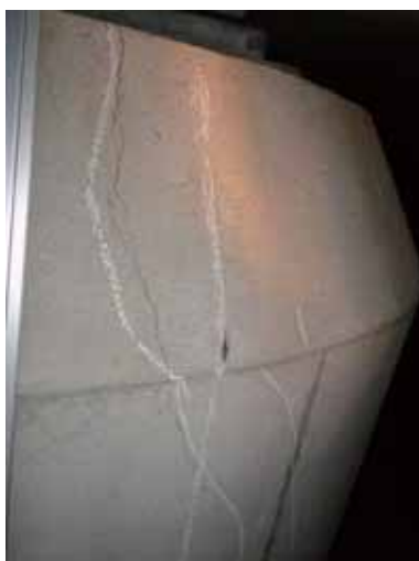
写真-4.1.10.4 P7 橋脚柱頭部側面のひび割れ
