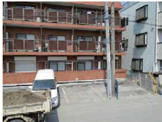
写真-4.5.7.7 低層マンションのベースコンクリートの割れ
