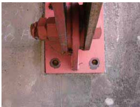
写真-4. 3. 17. 8 落橋防止構造の取付部下側アンカーボルトの破断 (A2 橋台 G3 桁)
