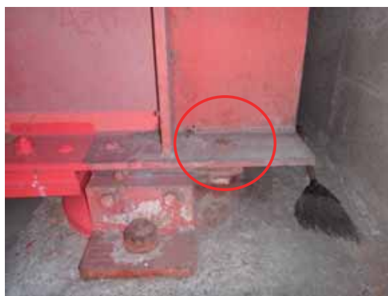
写真-4. 3. 17. 10 上沓のストッパーの破損
