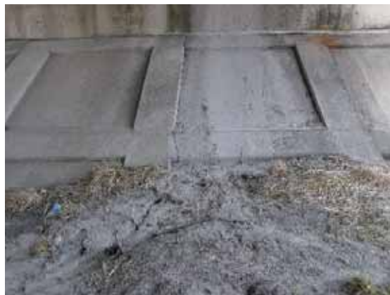
写真-4. 2. 10. 4 A1 橋台前面の地盤状況：地盤の乱れがみられる
