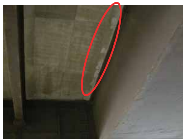
(i) 床板裏面にみられた剥離
