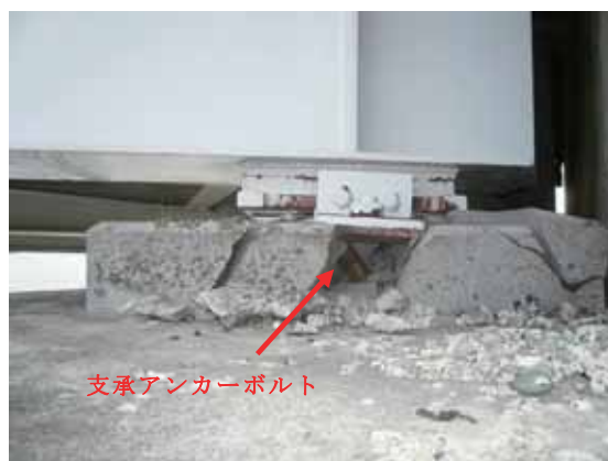
写真-4.4.30.5 支承アンカーボルトの 破断 (P29 起点側-北側)
