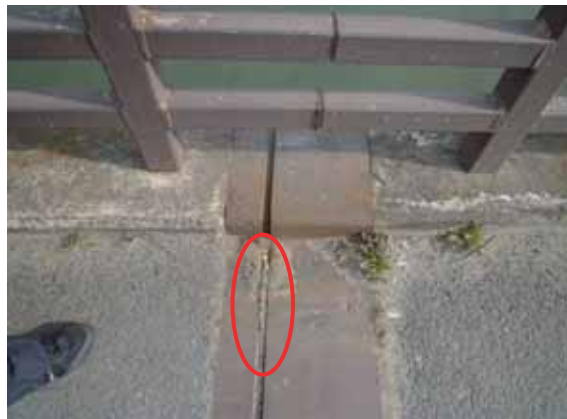
写真-4. 2. 10. 17 伸縮装置路肩部 (P3)
