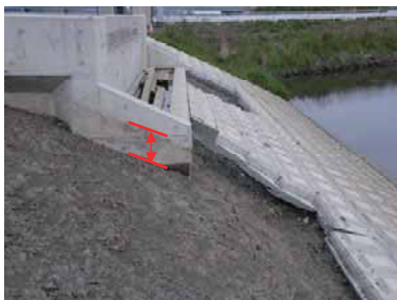
写真-4. 4. 10. 6 左岸側橋台部護岸の沈下と撤去状況
