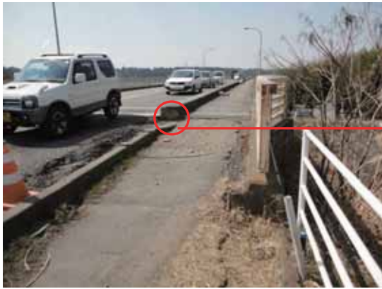
写真-4.4.6.8 A1 橋台背面の段差
