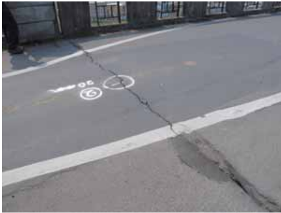
写真-4.4.26.10 左岸側橋台背面のひび割れ
