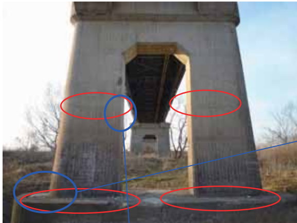
写真-4.2.11.16 P6 橋脚の損傷(P7 側より)
