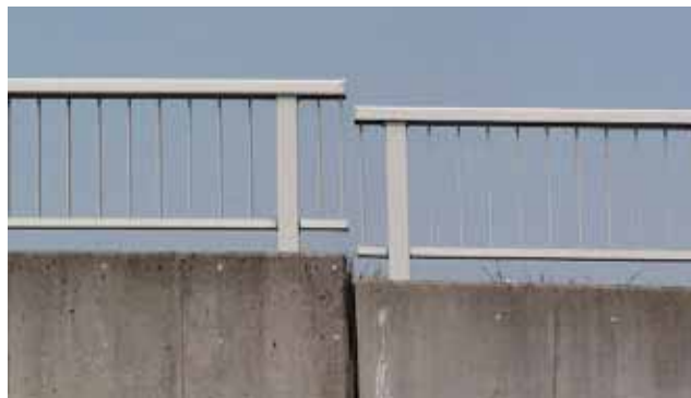
写真-4.5.7.2 高欄の段差(左岸側橋台、右側がアプローチ部)
