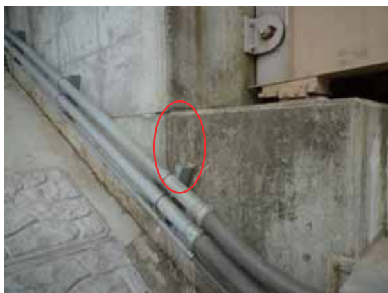
写真-4.2.13.12 A1 橋台ひび割れ(側面)
