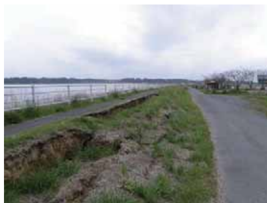
写真-4. 4. 14. 22 湖岸堤防の沈下(地割れ)
