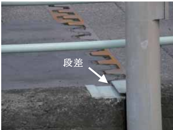
写真-4.4.13.16 ジョイント部の段差
