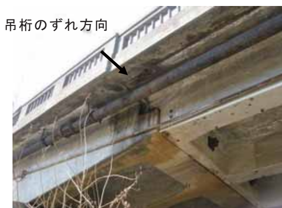
写真-4. 3. 12. 5 吊桁の橋軸直角方向ずれ（南側）
