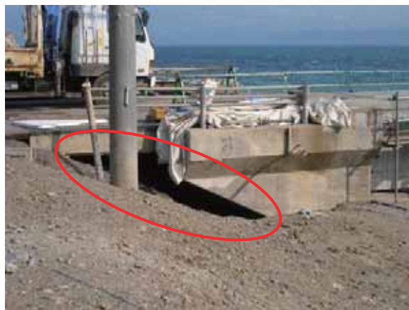
写真-4.1.17.4 A2 橋台背面土の流出
