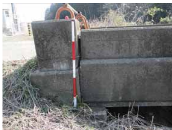
写真-4.4.4.11 左岸側橋台の傾斜
