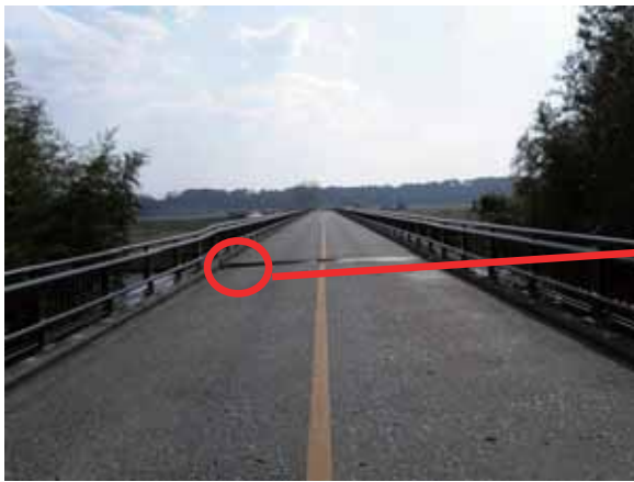
写真-4.4.5.8 橋面における P6 橋脚上部 の段差
