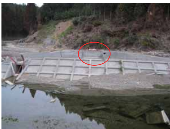
写真-4.2.4.2 揚屋橋が架かっていた橋台部
