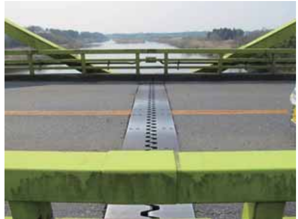
写真-4.4.28.3 3径間目の伸縮装置における 水平方向のずれ
