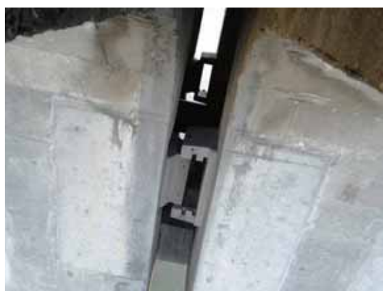
写真-4.1.11.4 中央ヒンジ部支承：かけ違い部の支承のかかり長が 40mm 程度
