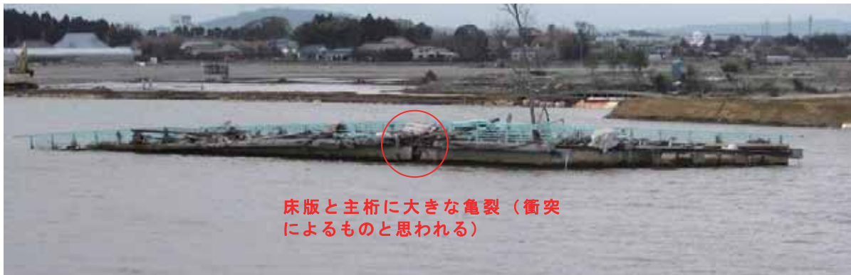
写真-4.2.6.4 流出した上部構造の状況
