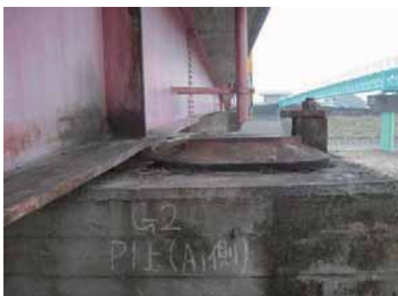
写真-4.2.18.4 P1 橋脚上の支承の破壊 (資料提供：仙台市)
