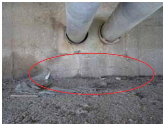
写真-4. 2. 13. 21 パラペットのひび割れ、 浮き
