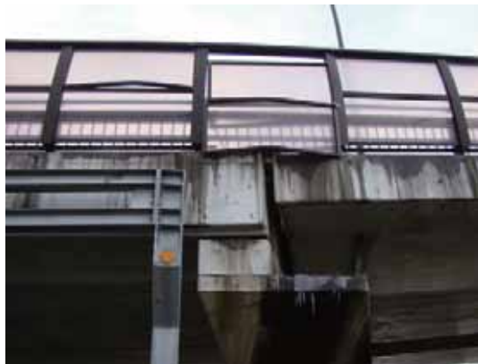
写真-4.2.8.2 遮音壁パネル損傷(伸縮部)
