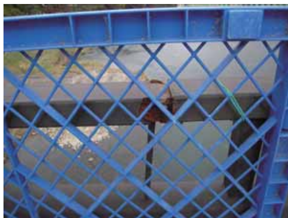
写真-4.3.15.5 高欄の損傷
