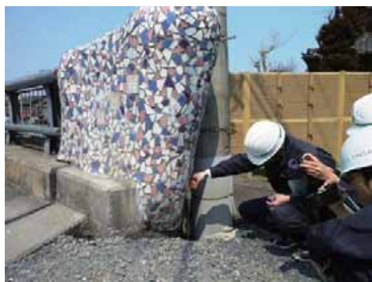
写真-4.4.22.3 橋台背面部の段差 (左岸側)
