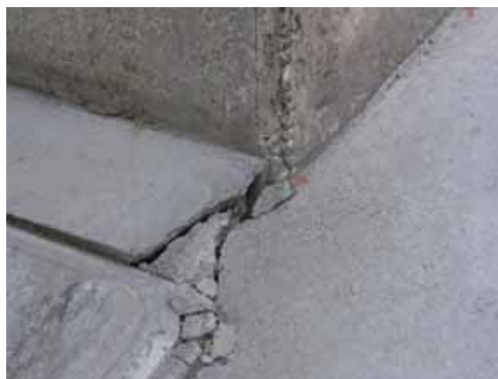
写真-4. 2. 13. 25 A2 橋台たて壁前面角部 (拡大)
