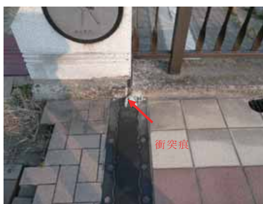
写真-4.4.32.13 側道橋橋台と地覆部の 衝突痕(潮来市側)
