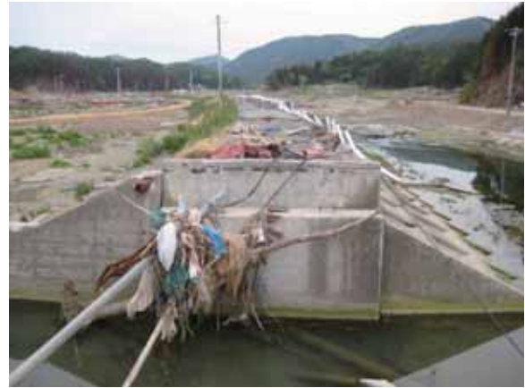
写真-4.2.4.5 大倉橋が架かっていた橋 台部
