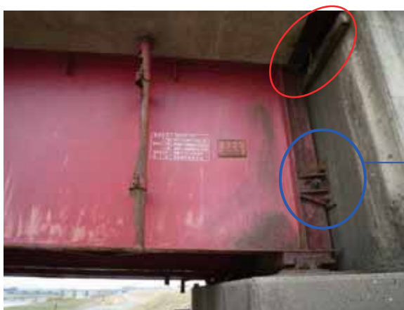
写真-4.2.12.8 A1 橋台側桁端部：床版付近で伸縮装置の排水管が少し主桁に押しつぶされている
