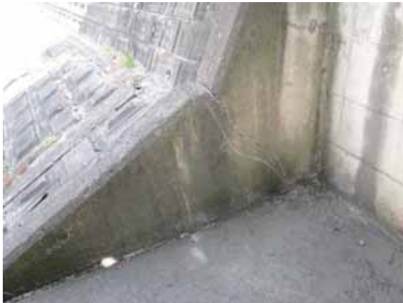
写真-4.4.7.3 橋台横の擁壁のひび割れ
