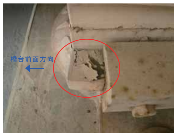
写真-4.2.13.11 A1 橋台支承前側ストッパーの変形
