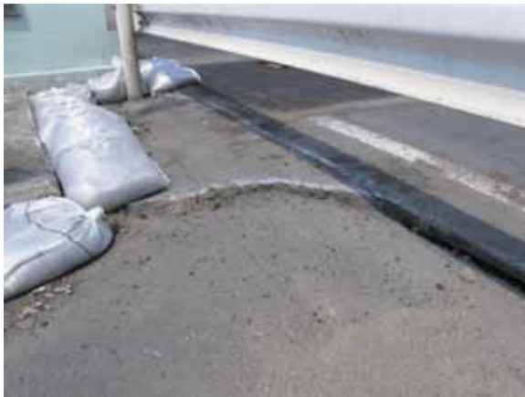
写真-4. 4. 13. 2 左岸側橋台背面の沈下
