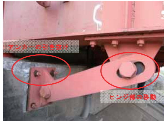
写真-4.3.17.3 落橋防止構造の損傷 (A2 橋台 G1 桁)
