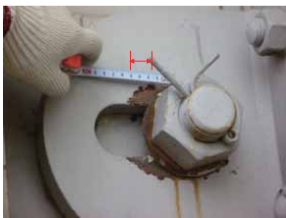
写真-4.2.13.10 桁～パラペット連結構造の擦過痕(約 20mm)
