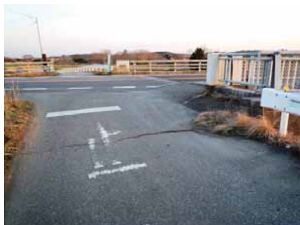
写真-4.4.24.4 舗装の損傷状況(A2)
