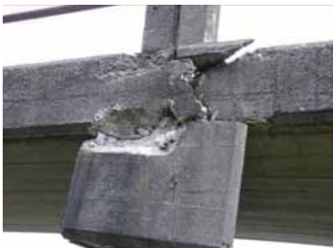
写真-4. 4. 14. 13 桁端部及び橋座部のコン クリートの損傷(右岸側橋脚上流側)
