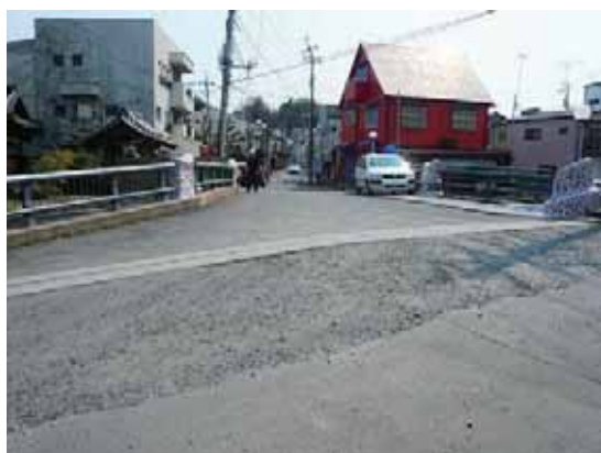
写真-4.4.22.2 橋台背面部の段差 (右岸側)
