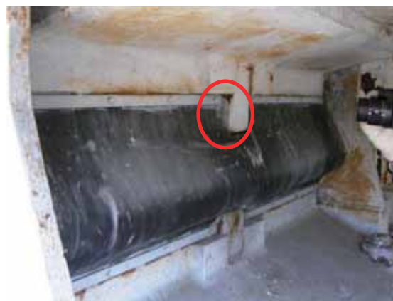
写真-4. 1. 12. 9 P5 橋脚上の支承：ローラーのずれ、上沓側の爪の塗膜剥がれが確認
