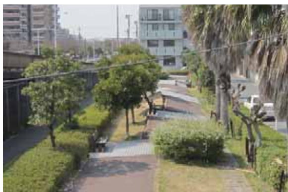
写真-4.5.6.3 歩道の盛り上がり (右岸側アプローチ部付近)
