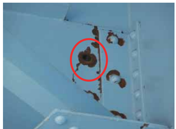
写真-4.4.5.21 横桁～主桁結合部の損傷 (P4) : リベットの脱落、塗膜のはがれ
