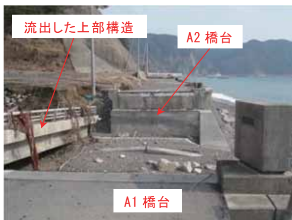
写真-4.1.17.1 被災時の状況 (岩手県提供)
