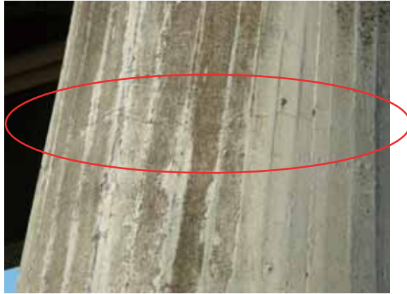
写真-4. 2. 11. 22 P3 橋脚中間部のひび割れ(下流側より)
