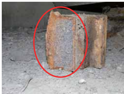
写真-4.4.11.5 支承移動制限装置の破断面
