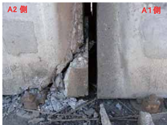
写真-4.1.13.2 P3 橋脚 G5 桁端部の損傷： 桁端部及び杓座モルタルの損壊等
