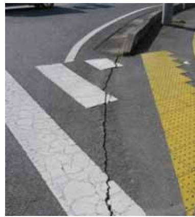
写真-4.3.10.5 橋台周辺舗装のき裂
