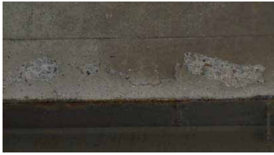
(j) 床板裏側の剥離部拡大写真
