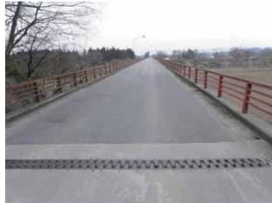
写真-4.1.9.5 左岸橋台上の路面状況
