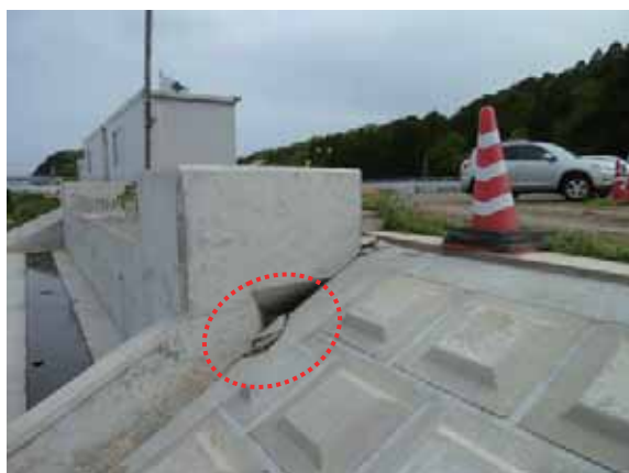
写真-4. 4. 10. 4 右岸側橋台部護岸の破損
