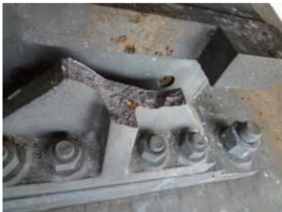
写真-4.1.7.4 A2 橋台鋼製支承のサイドブロック破断状況
