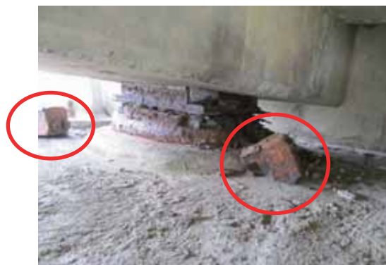
写真-4.4.11.4 支承部損傷状況(左岸側)
