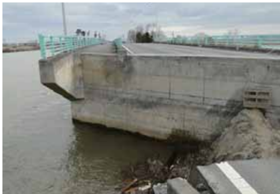
写真-4.2.6.5 左岸側橋台背面盛土の流出状況(橋台背面より)
