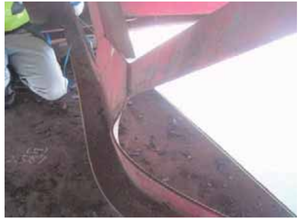
写真-4.2.18.11 P3 橋脚上の対傾構の変形 (資料提供：仙台市)
