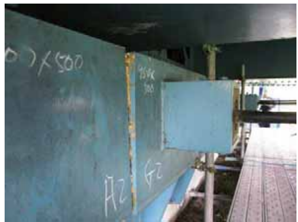
写真-4.3.15.9 落橋防止構造取り付けブラケットのずれ (A2 側)
