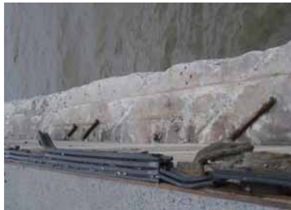
写真-4.2.6.10 流出した上部構造の アンカーバーの変形状況
