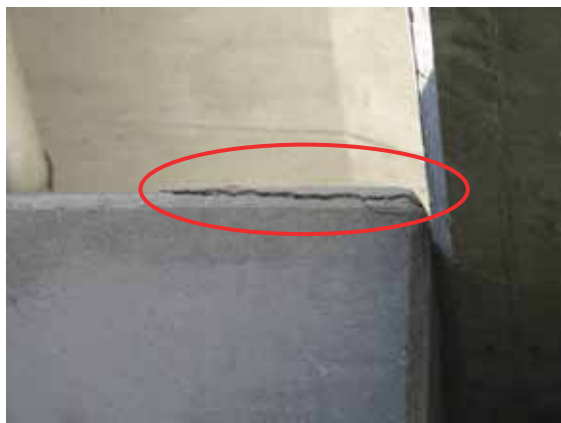
写真-4. 1. 11. 6 P6 橋脚上のコンクリート ブロック上面のひび割れ
