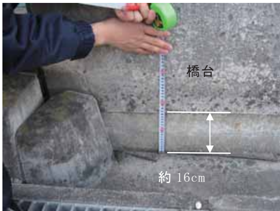
写真-4. 3. 8. 17 西側橋台周辺地盤の沈下
