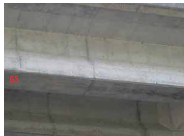
写真-4.1.19.6 4径間目G3桁のひび割れ
