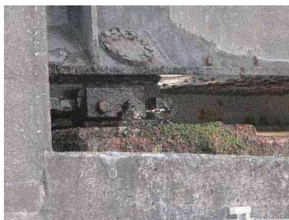
(d) 支承の腐蝕状況
