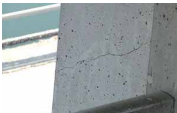
写真-4.5.6.9 樋門の門柱のひび割れ
