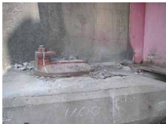
写真-4.2.18.3 A1 橋台上の支承の破壊 (資料提供：仙台市)
