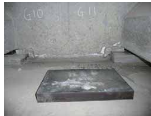
写真-4.3.14.16 抜け出したパッド型ゴム支承(P4橋脚上)(写真提供：福島県)
