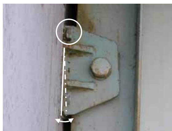
写真-4.2.10.9 A1橋台と桁の連結構造： アンカーボルトが抜出し、下側に開き
