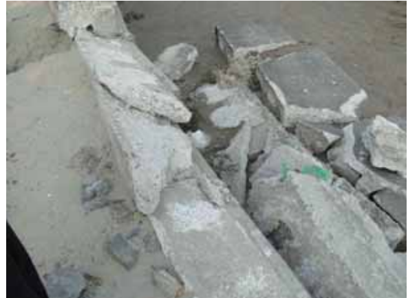
(b) 倒壊したコンクリート壁
