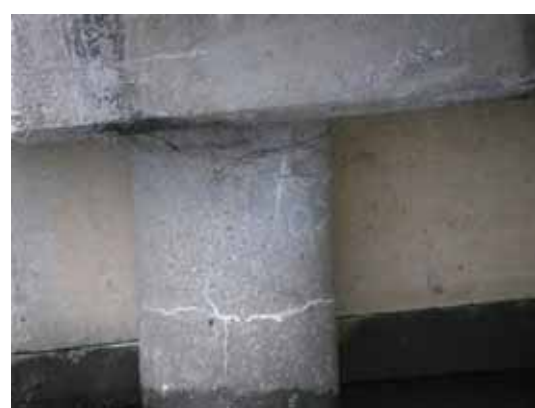
写真-4. 4. 14. 26 杭頭部のひび割れ
