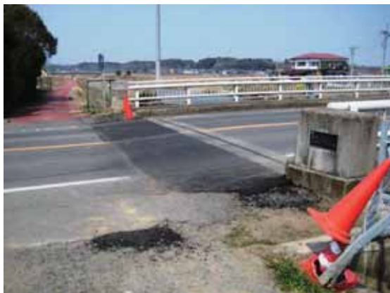
写真-4. 4. 20. 2 橋台背面の段差(右岸側)
