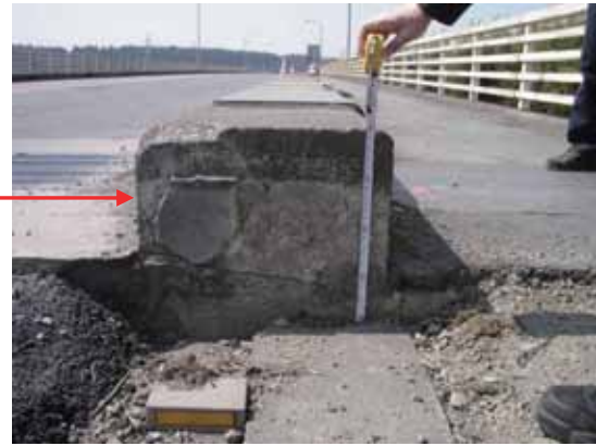
写真-4.4.6.9 A1 橋台背面の段差(拡大)
