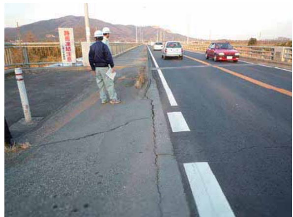
写真-4.4.24.3 舗装の損傷状況(A1)
