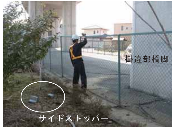
写真-4.3.8.11 破損し落下したサイドストッパー（西側取付部掛違部橋脚）
