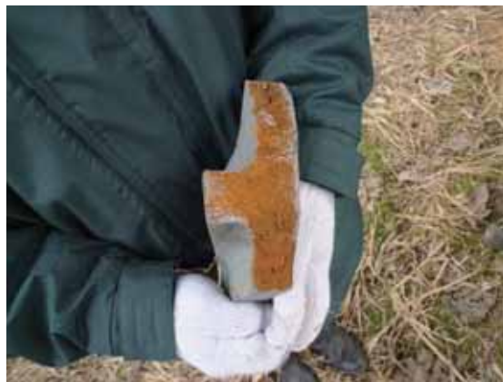
写真-4.1.7.5 サイドブロック破断面
