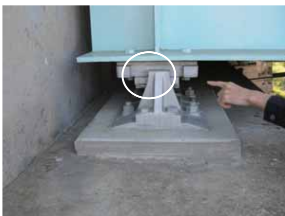
写真-4.3.10.2 橋台部支承の擦過痕
