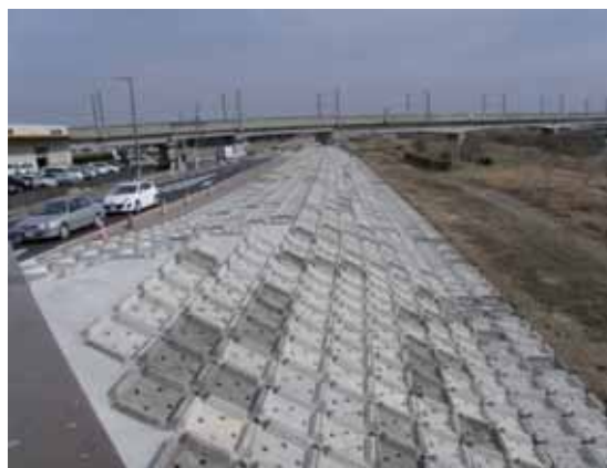
写真-4. 2. 10. 3 左岸(江合橋 A2 下流側)の 堤体状況：液状化により大きく損壊、既に 復旧工事が実施
