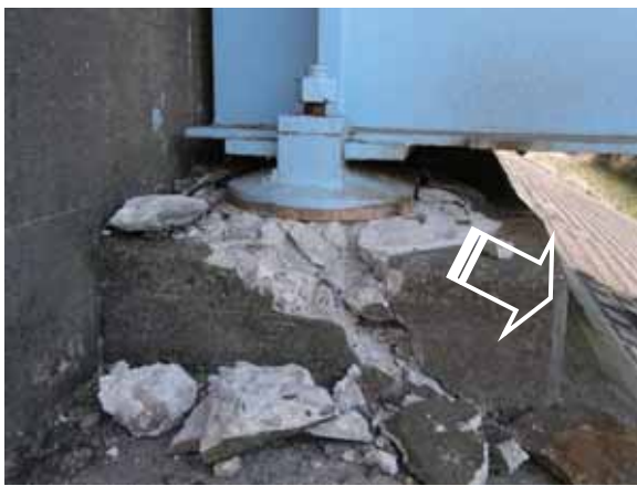
写真-4.4.5.12 A1 橋台上流側支承部側面の状況：せん断破壊面と衝突痕が確認
