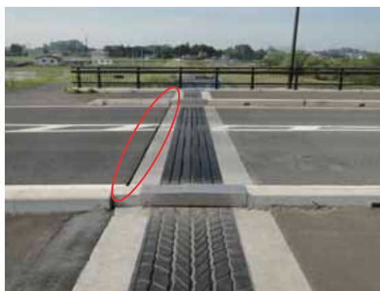
写真-4.2.9.5 橋台背面盛土の沈下による 車道部の隙間
