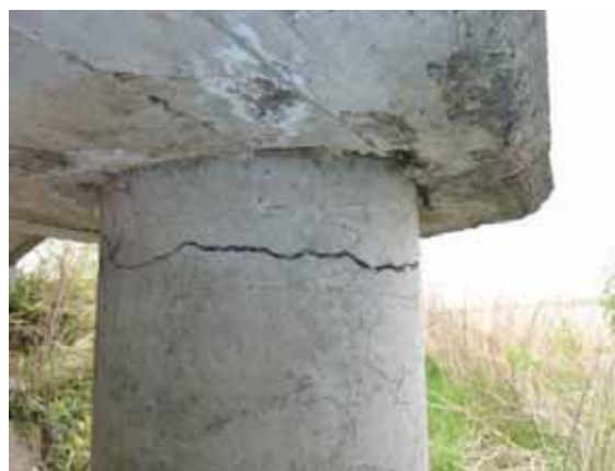
写真-4. 4. 14. 9 左岸側橋脚杭の損傷 (左写真の丸囲み部)
