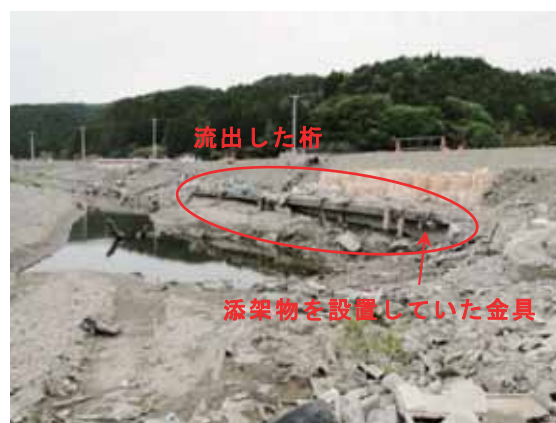
写真-4.2.3.3 桁の流出状況
