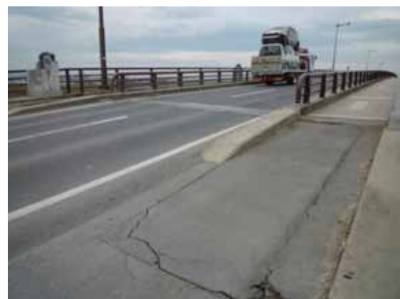
写真-4. 2. 13. 5 A2 橋台背面段差 (左岸側)
