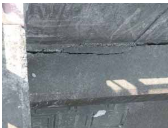
写真-4.5.8.5 取付護岸(右岸側)天端の割れ
