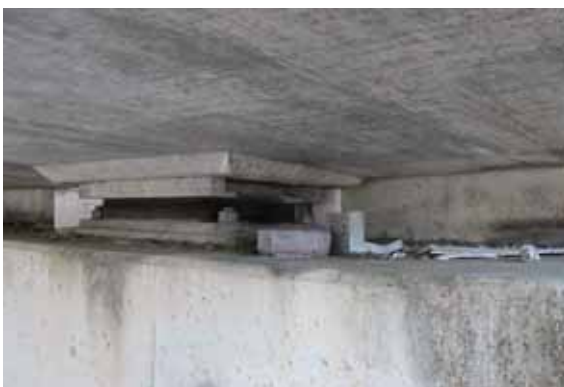
写真-4.3.8.8 サイドストッパーの破損(西側橋台)
