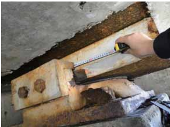
写真-4.1.12.12 A2 橋台支承の水平移動の 擦過痕(約 5cm)
