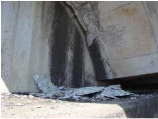
写真-4.4.1.5 桁端損傷状況 (A1)
