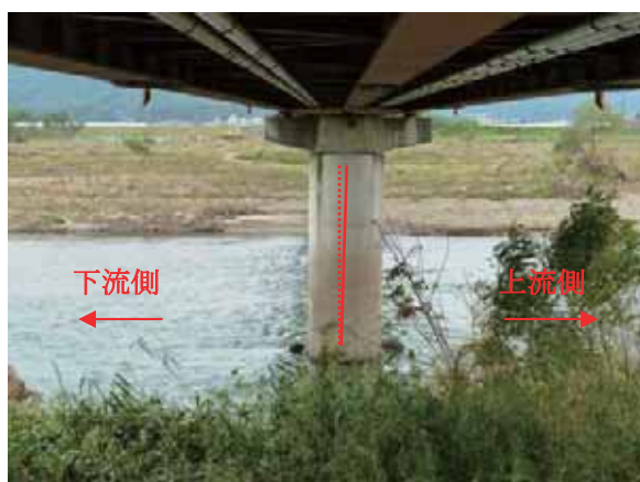
写真-4. 3. 16. 3 P1 橋脚の傾斜状況 (A1 側より)
