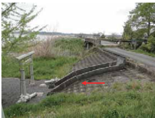
写真-4. 4. 14. 4 左岸側橋台背面盛土部の 変状
