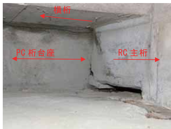
写真-4.4.4.5 RC 桁端部のひび割れ状況 (下流側)
