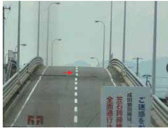
写真-4.3.14.9 A1 橋台取付部の状況(センターラインが奥側でやや右にずれている)
