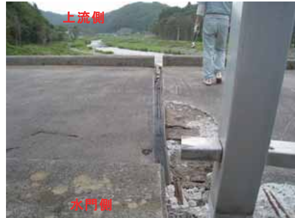
(b) 水門堰柱P2 上の伸縮装置：上流側に開きがあり、ゴムの破断を確認
