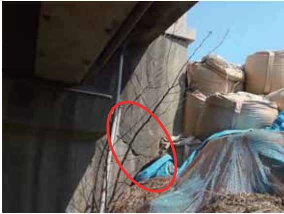
写真-4.3.12.8 左岸側橋台躯体の損傷
