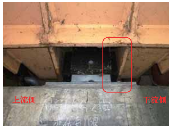
写真-4.3.16.9 変位制限構造の作動状況 (A1 側 G1～G2 間)
