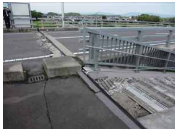
写真-4.3.14.7 跨線部(東側)での伸縮装 置の損傷(P3 橋脚上)
