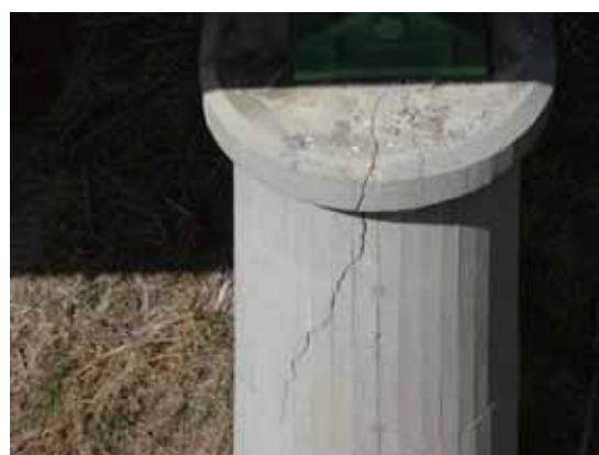
写真-4.4.2.7 P4 橋脚のひび割れ
