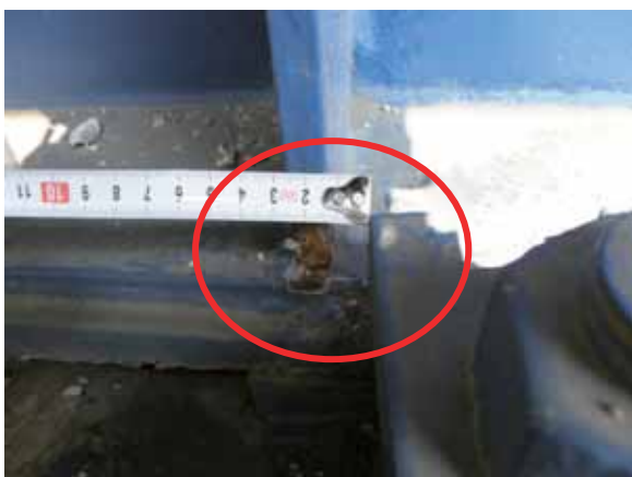
写真-4.4.13.18 右岸側橋台上桁端部の 支承上鉛直補剛材の塗膜剥がれ
