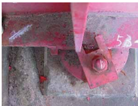
写真-4.2.18.18 側道橋の A2 橋台の支承の損傷(資料提供：仙台市)
