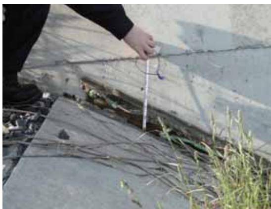
写真-4.2.9.2 橋台側面盛土の沈下 (9cm 程度)
