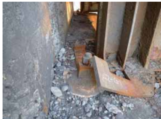
写真-4. 2. 11. 24 A2 橋台支承の破壊・桁の脱落(上流側の G1 桁)
