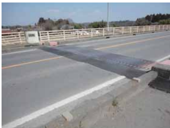
写真-4.4.6.14 A2 橋台背面の段差(補修済み)
