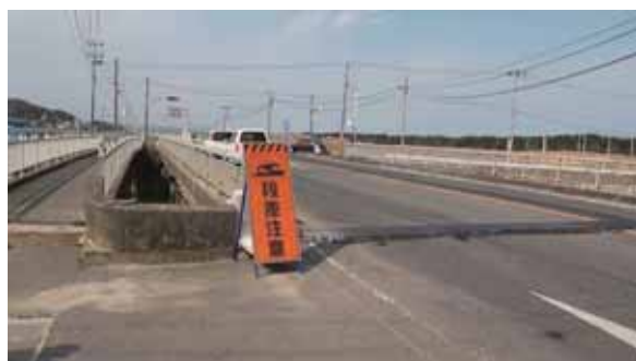
写真-4.3.3.2 南側橋台背面の沈下
