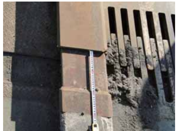
写真-4.1.12.13 A2 橋台伸縮装置の水平移 動の擦過痕(約 5cm)
