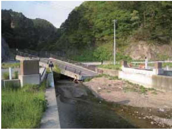
写真-4. 1. 18. 1 流出した上部構造
