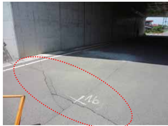
写真-4.3.13.9 カルバート付近舗装面の ひび割れ
