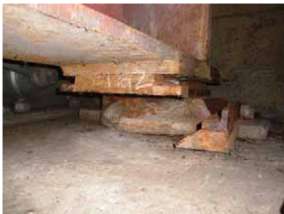
写真-4.3.16.8 支承部の損傷状況 (A1 側 G2)
