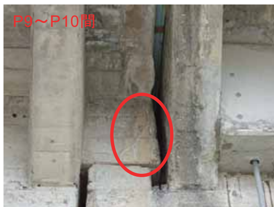
写真-4.6.1.6 P9～P10橋脚間ゲルバー固定支承部の損傷
