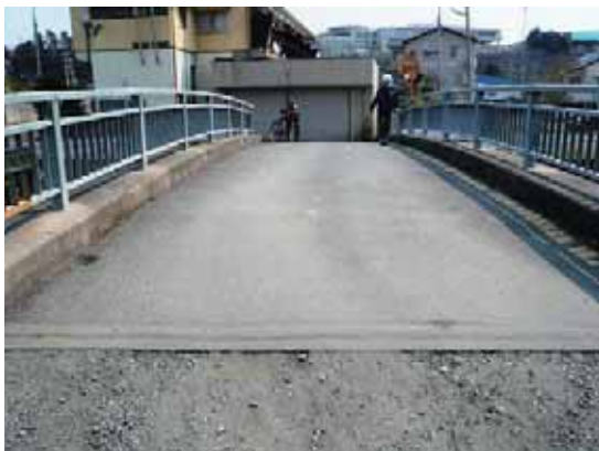
写真-4.4.21.2 橋台背面部の段差 (右岸側)
