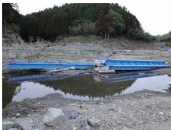
写真-4.2.4.3 流出した揚屋橋の上部構造
