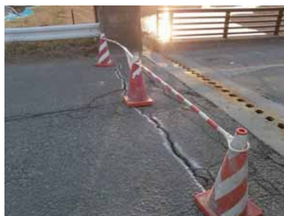
写真-4.2.11.6 橋台背面段差 (左岸 A2 側)
