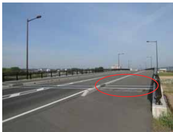
写真-4.2.9.3 橋台背面盛土の沈下による 歩道部の段差
