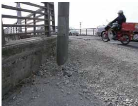
写真-4. 2. 10. 6 橋台背面段差(左岸 A2 側)
