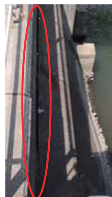
写真-4.5.8.4 橋梁取付護岸(右岸側)の目地部のあき
