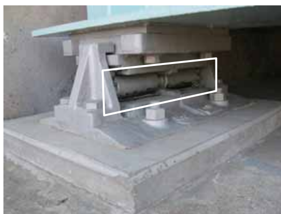
写真-4.3.10.3 支承変位による塗膜はく離
