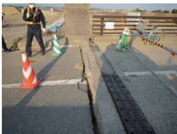
写真-4.2.11.5 橋台背面段差 (右岸 A1 側)
