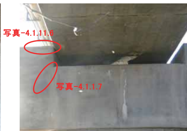
写真-4.1.11.5 P6 橋脚上のコンクリートブロック（下流側）の損傷
