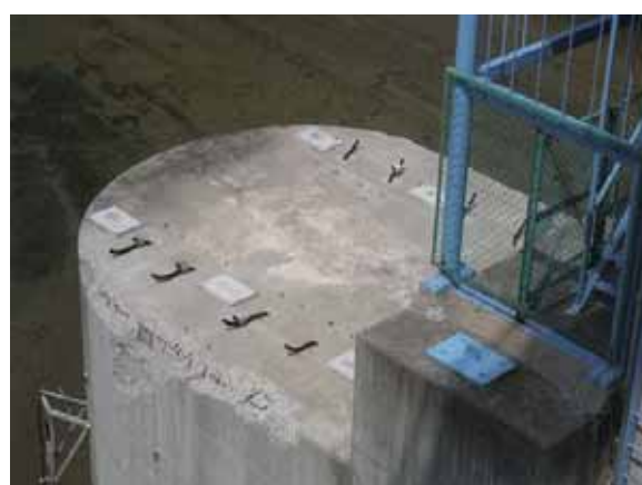
写真-4.1.19.11 水門堰柱P2 の橋座の 損傷
