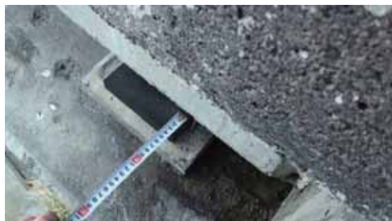
写真-4.3.3.4 ゴムパッド支承のはみ出し (北側橋台部)
