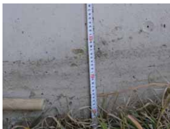
写真-4.4.6.17 P1 橋脚基部：地盤の沈下の痕跡
