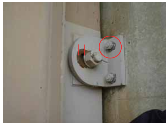
写真-4.2.13.19 桁～パラペット連結構造(下流側)：擦過痕、ボルトのゆるみ有
