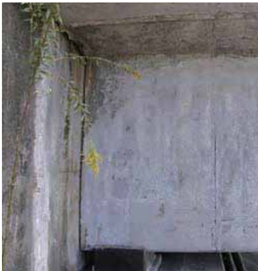
写真-4.2.14.4 A1側桁端部ひび割れ (補修後に撮影)
