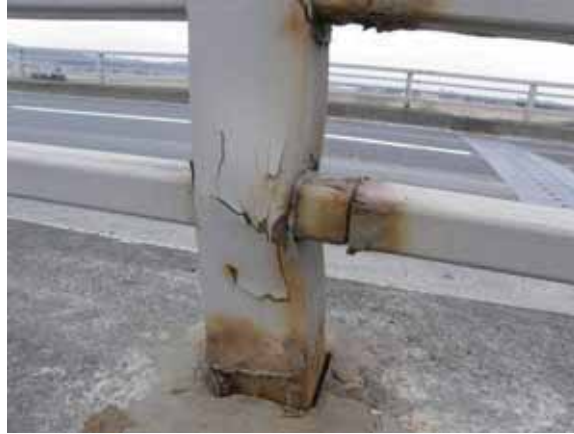
写真-4. 2. 12. 16 防護柵の変形
