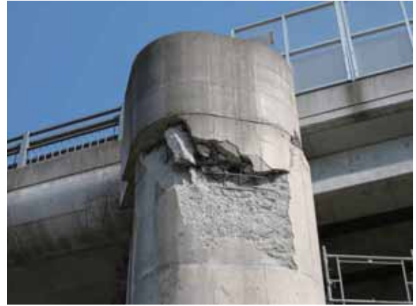
写真-4.3.8.5 ブロック取付部のせん断破壊(南西)
