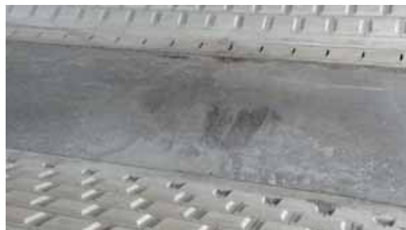
写真-4.5.6.4 左岸側橋脚背後の液状化痕 (噴砂が片づけられていた様子)
