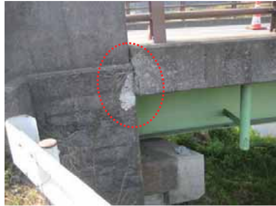
写真-4.4.17.4 桁の地覆部と橋台パラペットとの衝突によるコンクリートの欠け落ち（左岸側橋台上流側）
