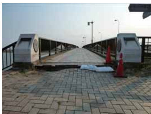
写真-4.4.32.10 側道橋橋台背面部の 段差(潮来市側)
