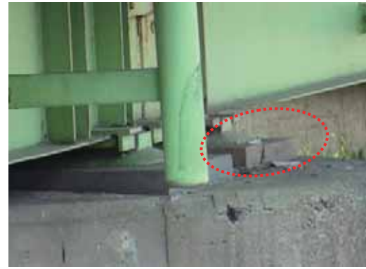
写真-4.4.17.10 固定側沓座モルタルの割れ(中間橋脚部)
