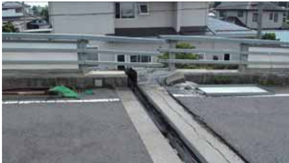
写真-4.3.14.4 A2 橋台部における損傷
