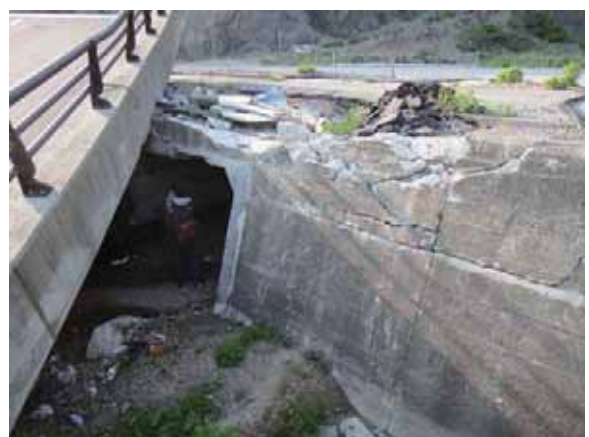
写真-4. 1. 18. 6 カルバートとの衝突
