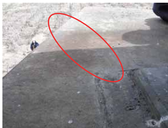
写真-4.1.7.9 P6 橋脚橋座部のひび割れ
