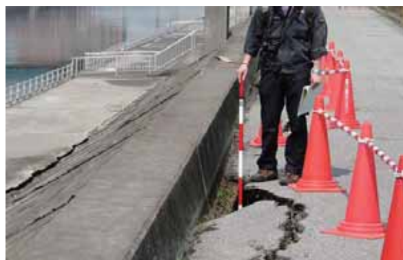
写真-4.5.6.6 左岸側護岸の変状
