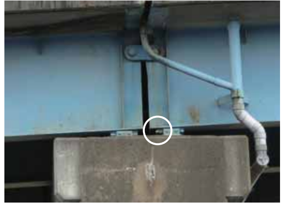
写真-4.3.7.5 橋脚部の上沓ストッパー の損傷
