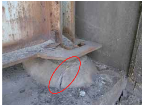
写真-4.2.11.10 A1 橋台支承(上流側)沓座の割れ
