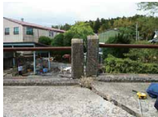
写真-4. 4. 14. 14 隣接桁間に生じた段差 (右岸側橋脚上流側)
