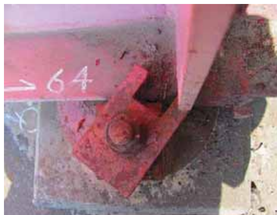
写真-4.2.18.17 側道橋の A1 橋台の支承の 損傷(資料提供：仙台市)
