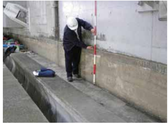
(f) 護岸の沈下(約 70cm)
