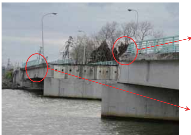
写真-4.2.6.7 上部構造が流出しなかった径間の状況(下流側側面)
