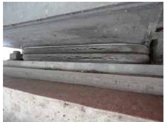
写真-4.4.6.5 ゴム支承前面のひび割れ
