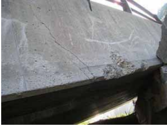
写真-4.1.18.7 陸側地覆部側面の損傷
