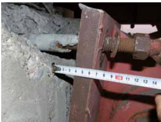
写真-4.3.17.4 アンカーの引き抜きの 状況 (A2 橋台 G1 桁)
