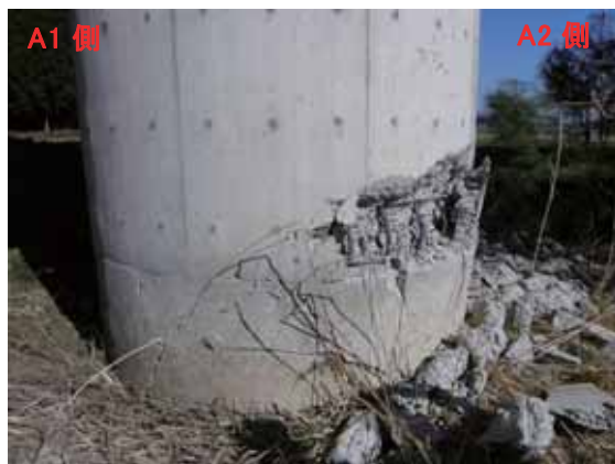
写真-4. 1. 12. 4 P7 橋脚段落し部の損傷状況（側面）
