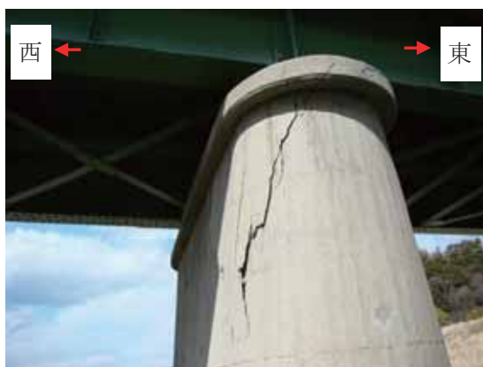
写真-4.4.2.4 P1 橋脚のひび割れ
