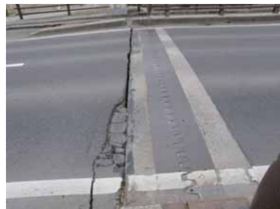
写真-4. 2. 13. 7 A2 橋台背面の舗装ひび割れ、伸縮装置遊間のつまり
