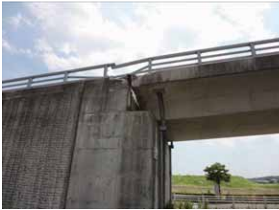
写真-4.3.14.2 橋台と桁の衝突による 損傷(東側の A1 橋台部)
