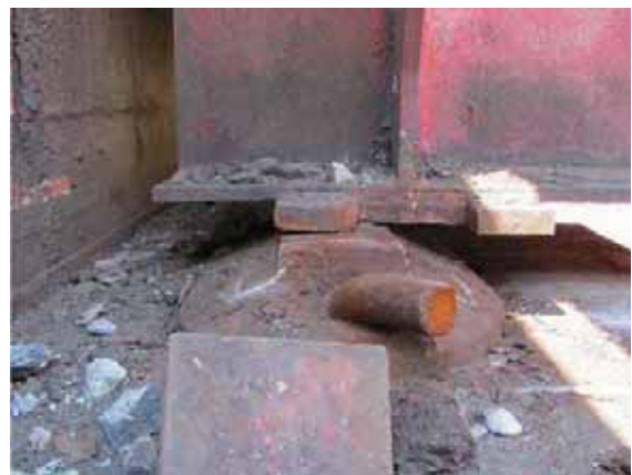
写真-4.2.18.15 A2 橋台上の支承の損傷 (資料提供：仙台市)
