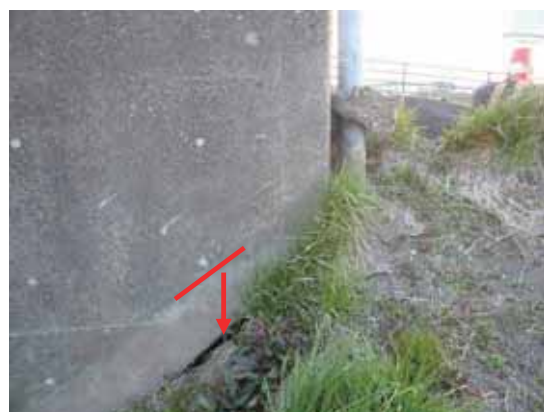
写真-4.5.11.3 稲敷市側橋台周辺土の沈下
