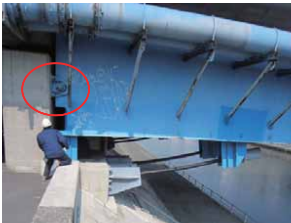
写真-4.5.5.2 変位制限構造と落橋防止構造の設置状況
