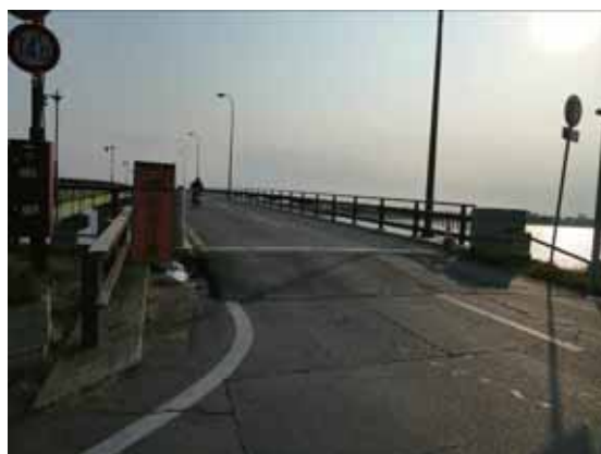
写真-4.4.32.3 橋台背面部の段差 (潮来市側)
