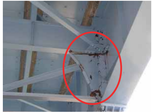
写真-4.4.5.19 ニーブレースの損傷(P4)
