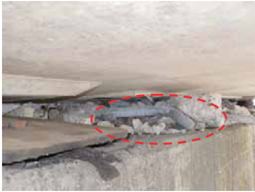
写真-4.3.14.12 A1橋台部のアンカーバーの破断(写真提供：福島県)
