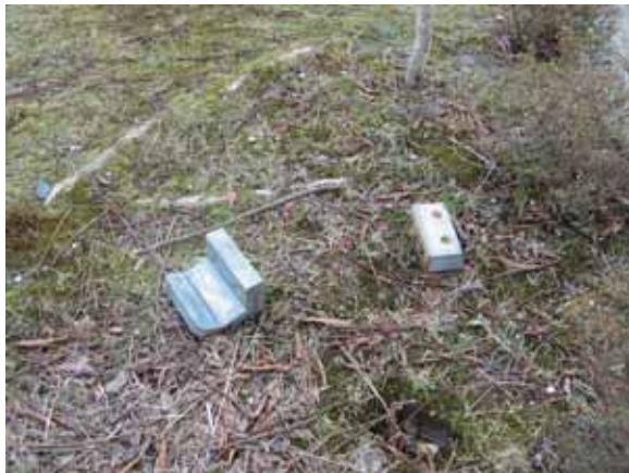
写真-4.3.8.10 破損し落下したサイドストッパー（西側取付部掛違部橋脚）
