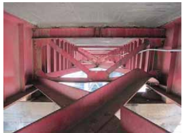
写真-4.2.18.9 P3 橋脚上の下横構の変形(資料提供：仙台市)
