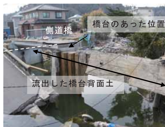
写真-4.3.5.2 流出した橋台背面土
