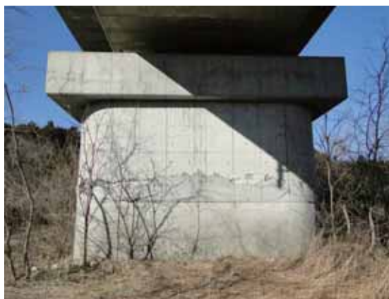
写真-4.1.12.3 P8 橋脚段落し部の損傷状況(A1 側)
