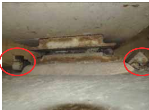
写真-4.4.11.3 支承部損傷状況(右岸側)
