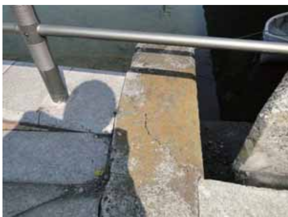
写真-4.5.10.4 橋梁取付護岸(右岸側) 天端のひび割れ
