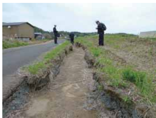
写真-4. 4. 14. 24 噴砂の状況 (東水神橋から約 200m 離れた地点)
