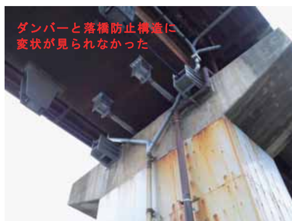
写真-4. 2. 7. 13 ダンパーと落橋防止構造
