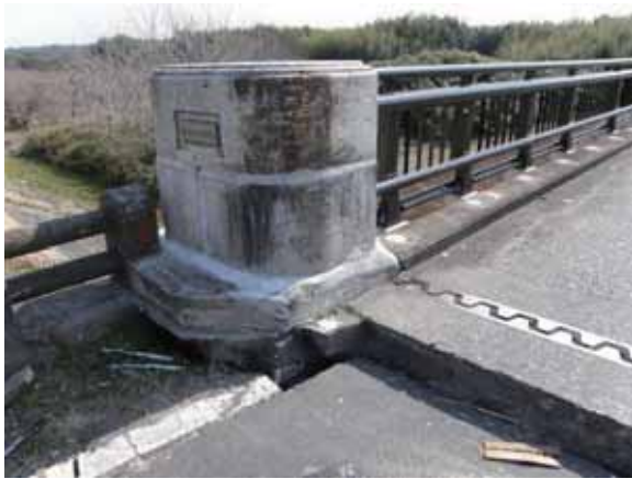
写真-4.4.5.24 A1 橋台背面の段差
