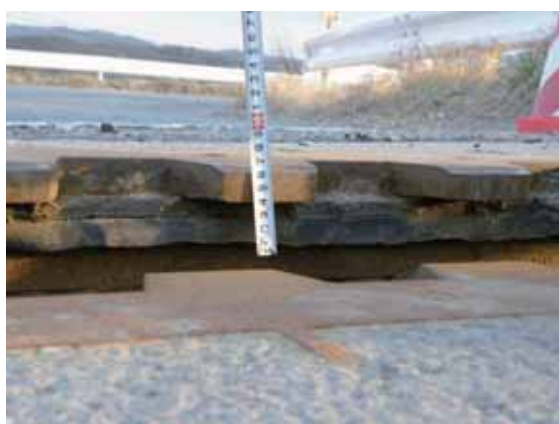
写真-4.2.11.29 高さ方向段差 (写真-4.2.11.28 の拡大)
