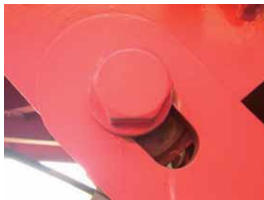
写真-4.5.1.18 落橋防止構造の擦過痕 (A2 橋台部桁側)
