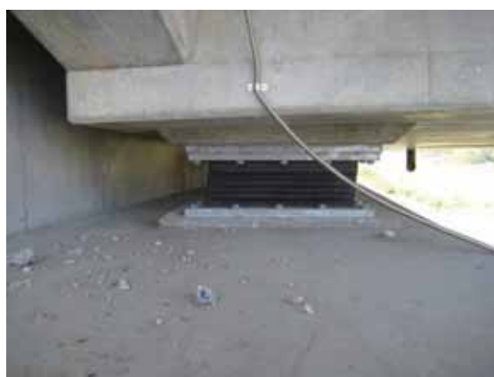
写真-4.2.9.6 ゴム支承の微小な変形
