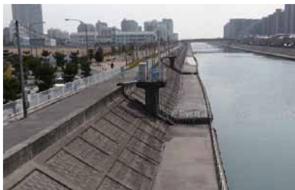
写真-4.5.6.5 左岸側の護岸の変状
