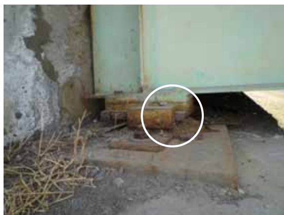
写真-4.2.10.8 A1橋台下流側(G5桁) 支承：サイドブロックの遊間なし
