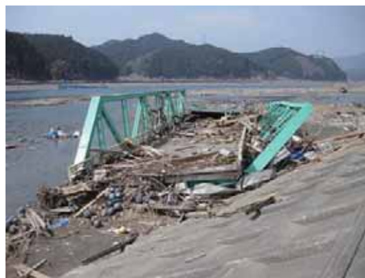
写真-4.1.2.2 流出した姉齒橋の上部構造
