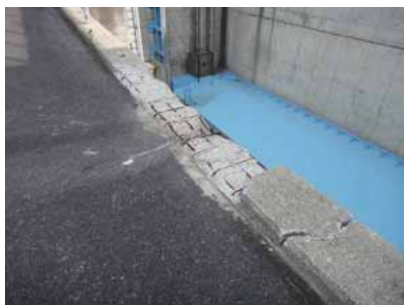
写真-4.1.19.8 地覆部の圧壊状況 (3 径間目)
