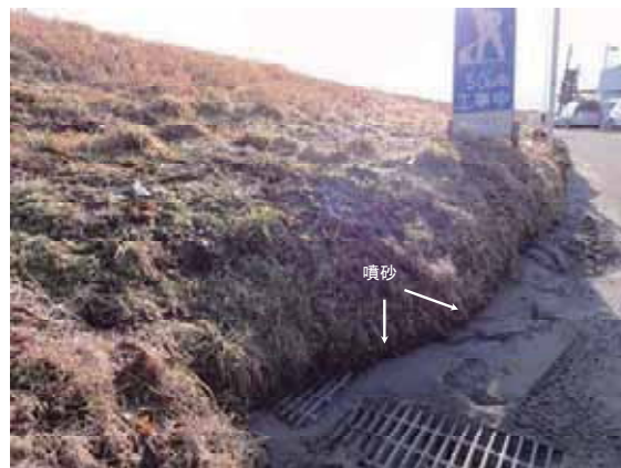
写真-4.2.17.4 左岸側の橋台周辺堤防の噴砂
