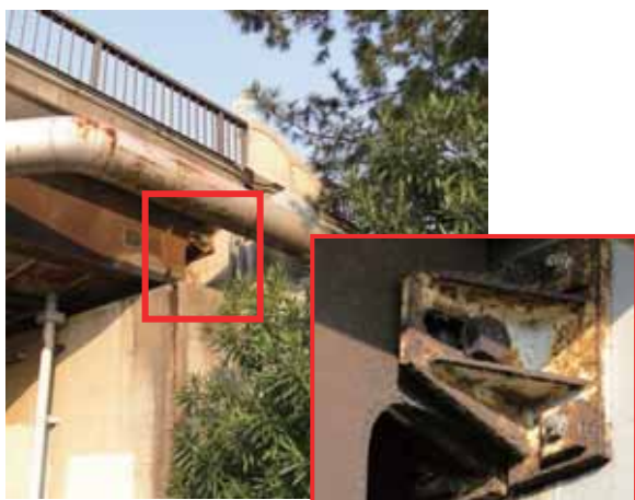
(a) パラペット付近の腐蝕状況
