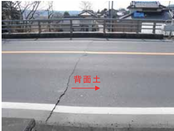
写真-4.4.3.4 A1 橋台背面の段差(約 2cm)
