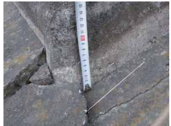
写真-4. 4. 13. 5 右岸側橋台側面地盤の沈下
