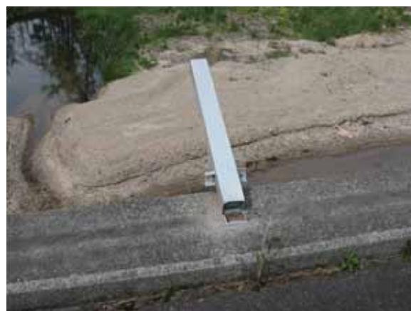
写真-4.1.19.9 高欄の損傷状況
