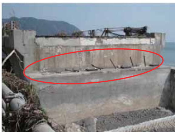
写真-4.1.17.3 被災時のA2 橋台 アンカーバーの状況(岩手県提供)
