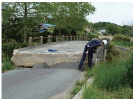
写真-4. 4. 14. 15 右岸側橋台背面の段差
