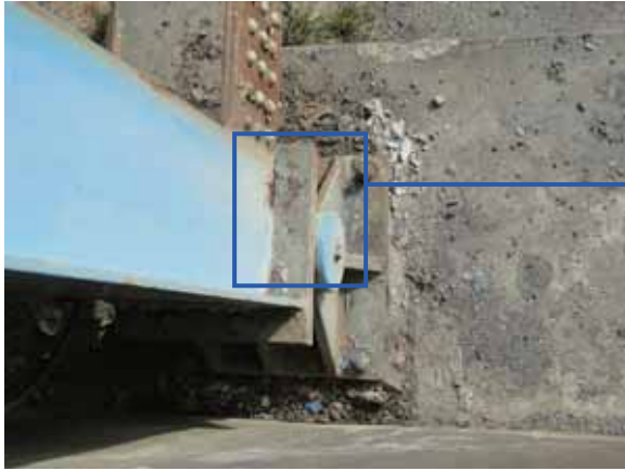
写真-4. 1. 16. 5 右岸橋台支承：沓座モルタルの損傷
