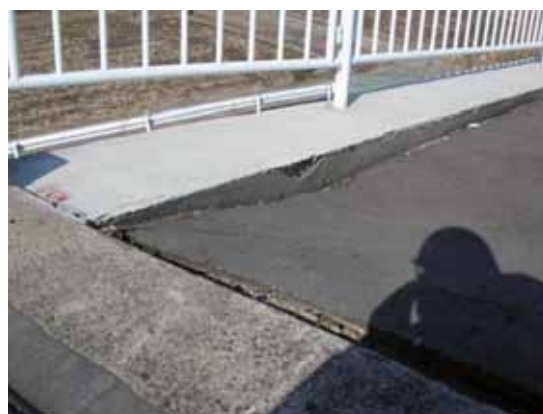
写真-4.4.16.4 歩道部の沈下
