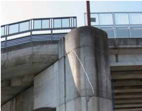
写真-4.3.8.6 ブロック取付部のせん断ひび割れ(北東)
