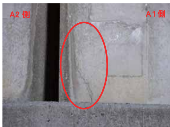
写真-4.1.13.6 P4 橋脚上の桁端部：ひび割れともみられる痕跡
