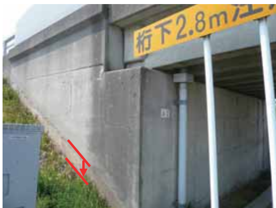
写真-4.4.30.2 橋台周辺盛土の沈下 (A2 橋台)
