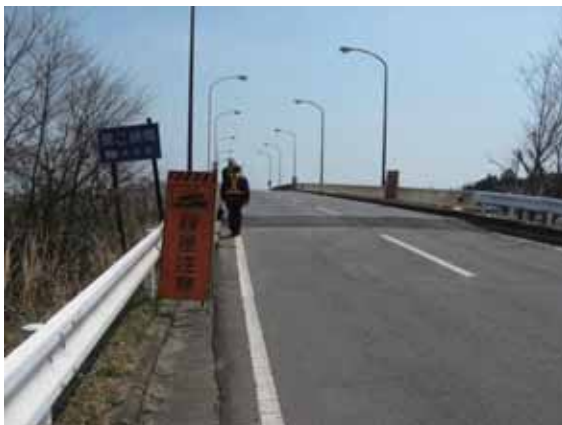
写真-4.3.7.2 北側橋台背面の沈下
