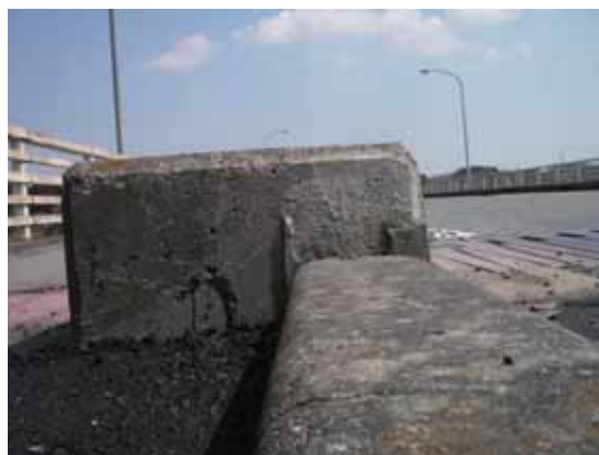
写真-4.4.6.15 A2 橋台背面歩道部の段差
