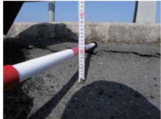
写真-4.4.3.5 A1 橋台背面歩道部の段差(約 10cm)
