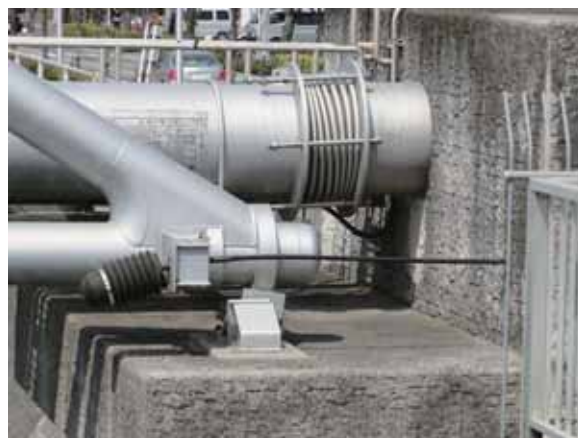
写真-4.5.8.8 落橋防止構造のたるみ
