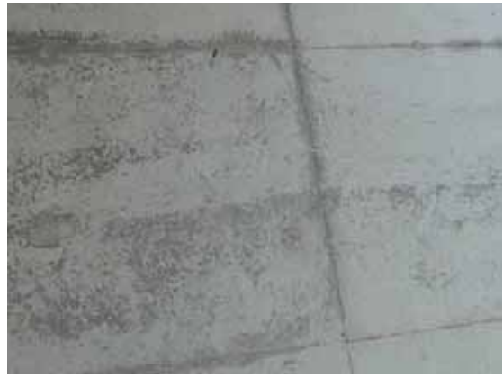
写真-4. 4. 3. 17 A1 橋台カルバートの斜めひび割れ
