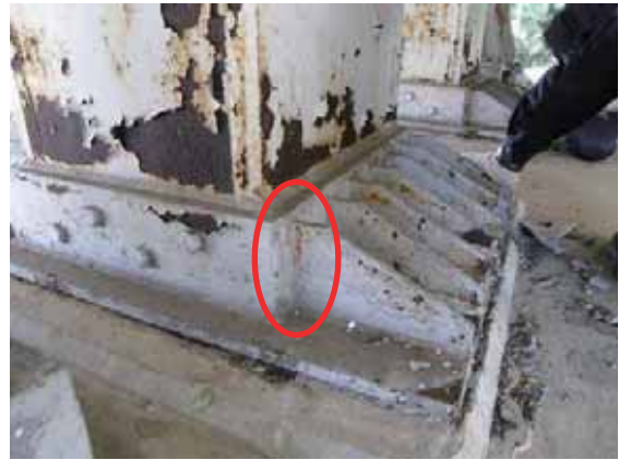
写真-4.1.12.11 P5 橋脚上のストッパー (両方向固定) の塗膜剥がれ
