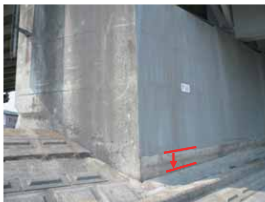
写真-4.4.30.3 堤防護岸の沈下 (P29)
