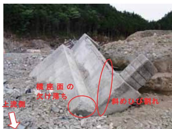
写真-4.2.3.4 上流側に傾斜して転倒した右岸側橋台
