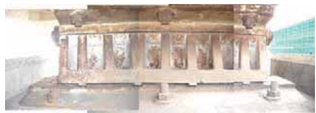
(b) P2 可動支承、変状なし(4 個の幅 30mm のほぞが水平移動を制限したと考えられる)
