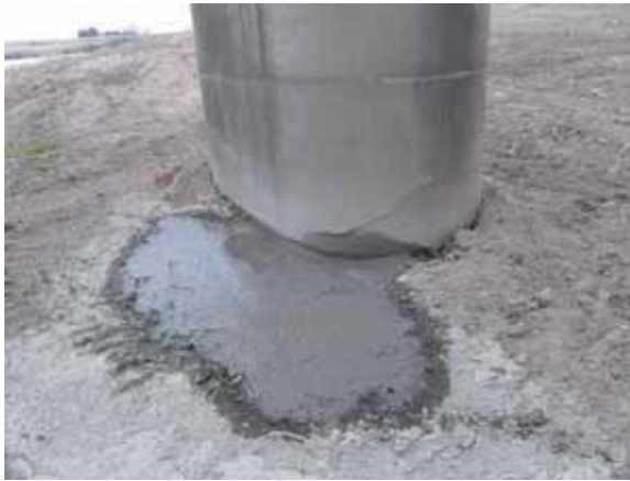
写真-4.2.12.4 水管橋橋脚基部の水たまり(粒径は細かい)
