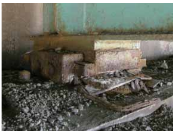
写真-4.2.10.11 A1橋台内桁(G2)支承の著 しい腐食と破損
