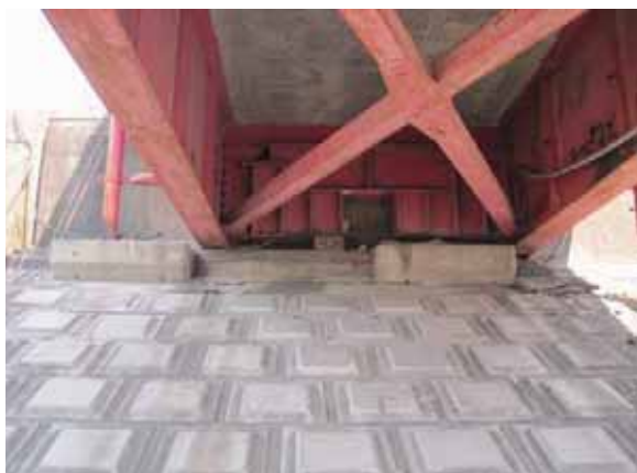
写真-4.2.18.2 A1 橋台上の上部構造の橋軸直角方向への移動(約 75cm) (資料提供：仙台市)
