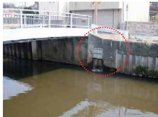
写真-4.4.21.3 排水樋管のせり出し (左岸側)
