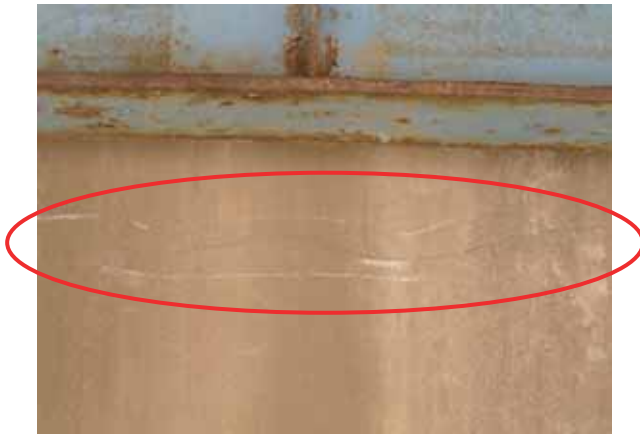
写真-4.2.11.9 A1 橋台パラペット前面の水平ひび割れ
