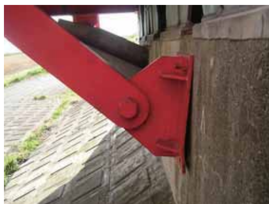
写真-4.5.1.16 A2 橋台部の落橋防止構造 の損傷
