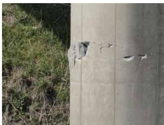
(b) コンクリートの曲げ損傷
