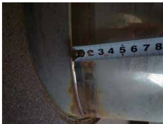
写真-4.1.7.7 添架管の擦過痕(写真-4.1.7.6の拡大)
