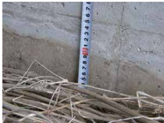
写真-4.1.7.11 橋脚周辺地盤の沈下
