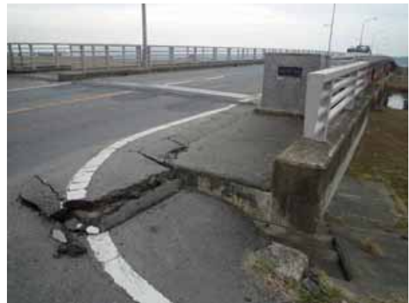
写真-4.2.12.7 橋台背面段差(左岸 A2 側)
