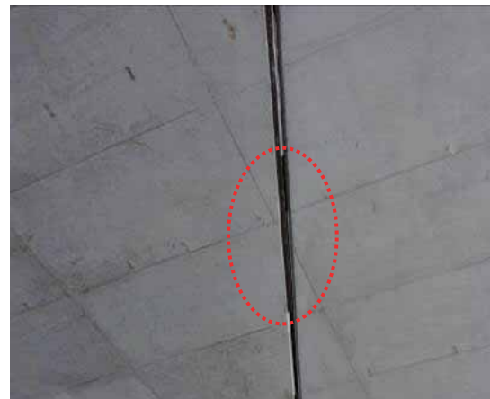
写真-4.3.13.11 カルバート間詰め材 の脱落
