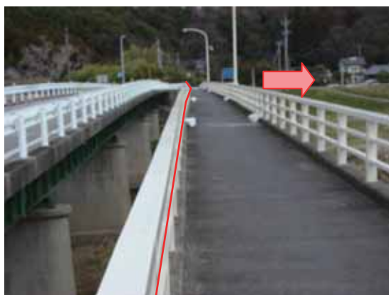
写真-4.4.2.8 側道部高欄の変形
