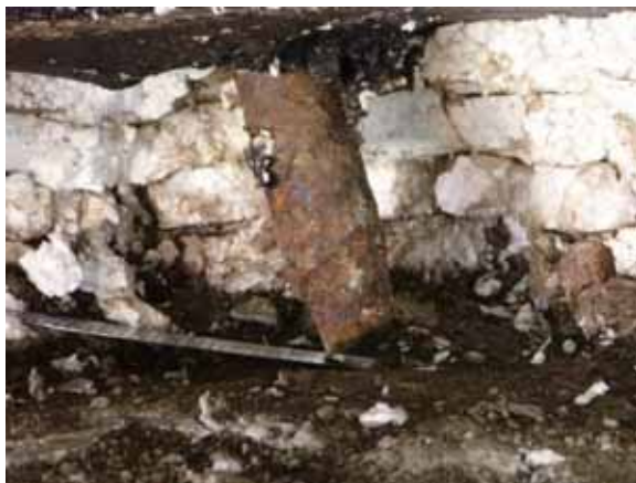
(c) アンカーバーの破断
