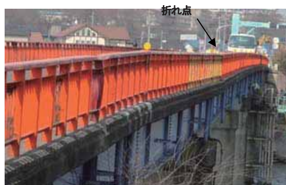
写真-4.4.9.9 高欄の不連続点(右岸側から)
