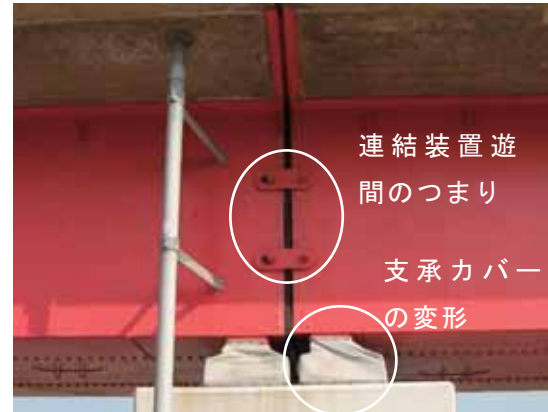
写真-4.3.2.5 桁遊間縮みの痕跡
