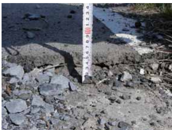
写真-4.4.4.12 左岸側取付部の段差
