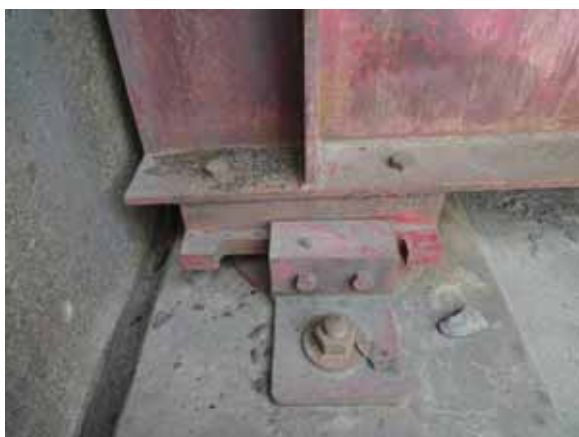
写真-4.2.12.12 A2 橋台上の可動支承：支承遊間のつまり
