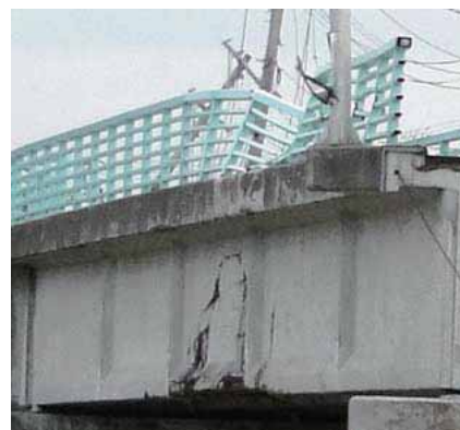
写真-4.2.6.8 損傷箇所状況
