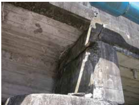
写真-4.4.4.2 橋脚上の桁端部の破壊状況：RC 桁と PC スラブ沓座の接触面に大きなひび割れ、沓座部コンクリートの剥落
