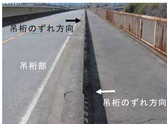
写真-4. 3. 12. 4 吊桁の回転的なずれ
