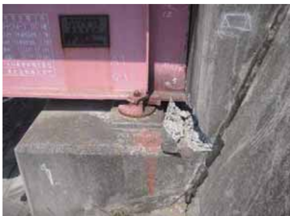
写真-4.2.18.16 側道橋の A1 橋台の支承と パラペットの損傷(資料提供：仙台市)
