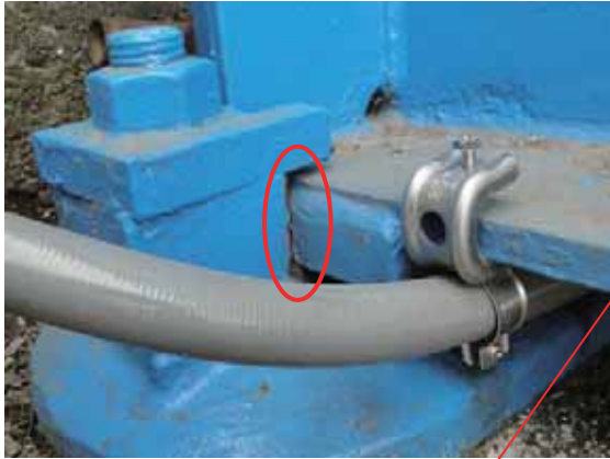
写真-4.1.8.4 A1 橋台上の可動支承：塗膜剥がれ
