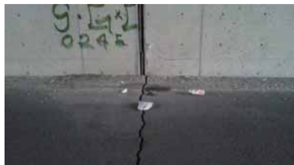
写真-4.3.4.5 目地部開きによる舗装面のひび割れ
