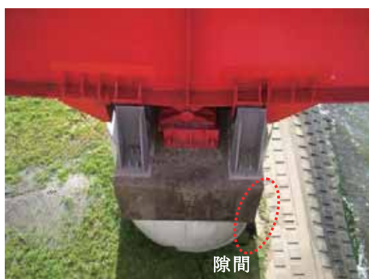
写真-4.5.1.6 P2 橋脚周辺地盤の変状 (下流側より)
