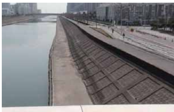
写真-4.5.6.10 右岸側の護岸の変状
