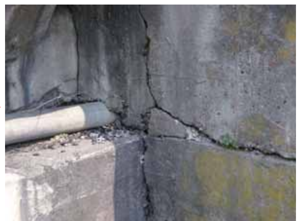
写真-4. 4. 26. 9 左岸側橋台側面のひび割れ
