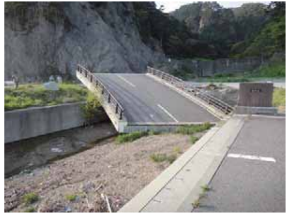
写真-4. 1. 18. 2 流出した上部構造
