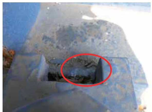
写真-4.4.13.19 右岸側橋台支承の 接触痕
