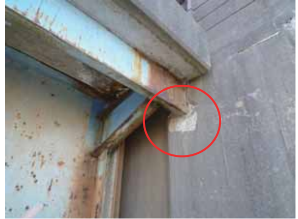
写真-4.2.11.8 A1 橋台脇(上流側)の壁部におけるコンクリート欠損
