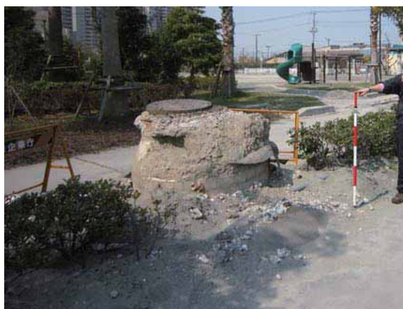
(a) マンホールの浮き上がり(1m弱)
