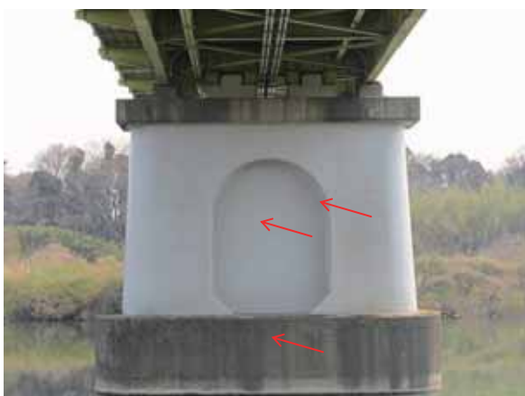
写真-4.4.28.6 低水域の橋脚：ひび割れの 痕跡が確認
