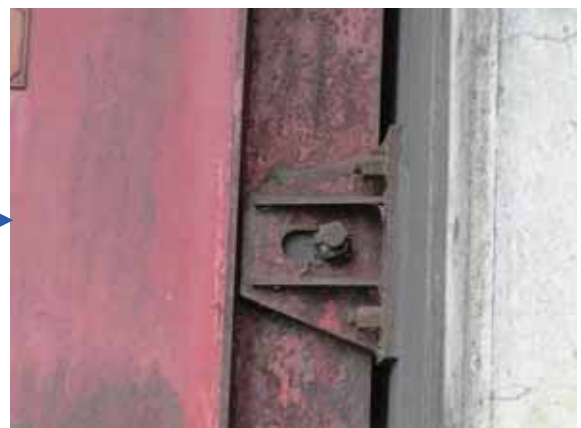
写真-4.2.12.9 A1 橋台側面：桁端がつまり遊間がなくなっているが、以前から生じていたものとみられる
