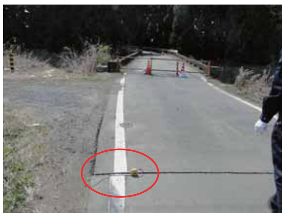
写真-4.4.4.8 左岸側道路の横ずれ(約 3cm)
