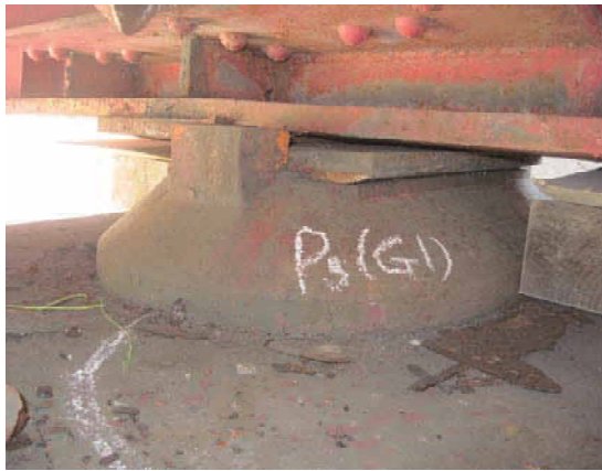
写真-4.2.18.6 P3 橋脚上の G1 桁の支承の損傷(資料提供：仙台市)
