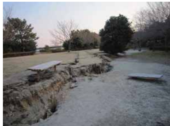
(b) 段差の境界付近に設置されたベンチ (左：沈下しなかった箇所にあるベンチ、 右：沈下したベンチ)
