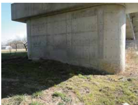
写真-4. 1. 12. 6 P7 橋脚段落し部の損傷状況（A1 側）
