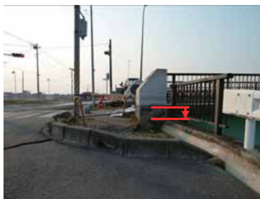
写真-4.4.32.11 側道橋橋台背面部の 段差(香取市側)
