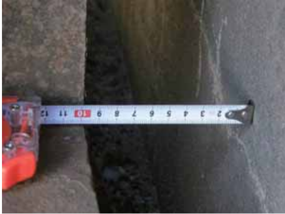
写真-4.2.11.7 A1 桁端部と橋台パラペット間のすき間(約 10cm)
