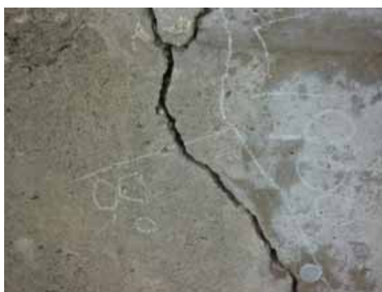
写真-4. 2. 13. 23 A2 橋台ひび割れ(拡大)
