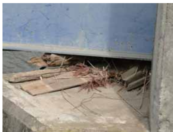
写真-4.2.5.6 右岸側橋台に堆積している木片など
