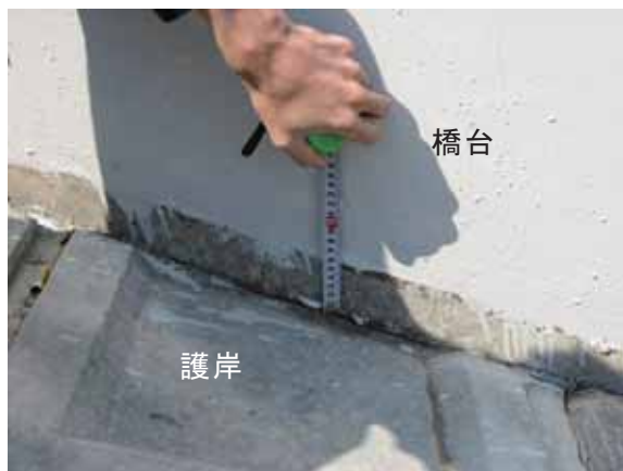
写真-4. 3. 11. 5 右岸橋台部の護岸の沈下(約 6cm)
