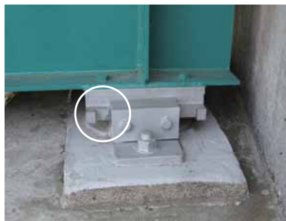
写真-4.3.6.4 支承の擦過痕
