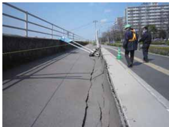
写真-4.5.9.8 左岸護岸背面土の沈下、 看板の転倒(今川橋～境川中央歩道橋間)
