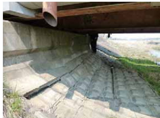
写真-4. 4. 23. 9 堤防護岸の沈下(右岸側)
