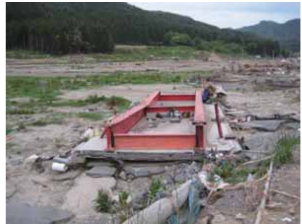
写真-4.2.4.7 流出した大倉橋の上部 構造
