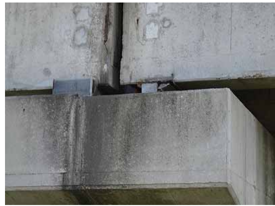
写真-4.2.14.7 橋脚上での支承の損傷
