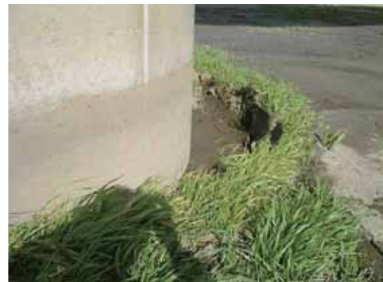
写真-4.5.1.12 P7 橋脚基部にできた隙間
