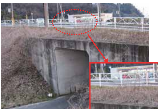
写真-4.3.4.4 ボックスカルバート取付部のガードパイプのずれ(右が矢田川橋)
