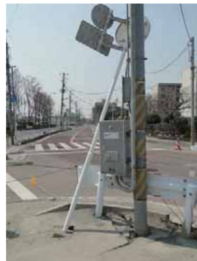
写真-4.5.7.4 道路標識柱の傾斜
