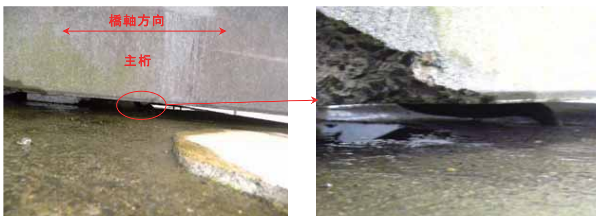
写真-4. 1. 20. 8 水門堰柱P2 支点上のアンカーバーの変形
