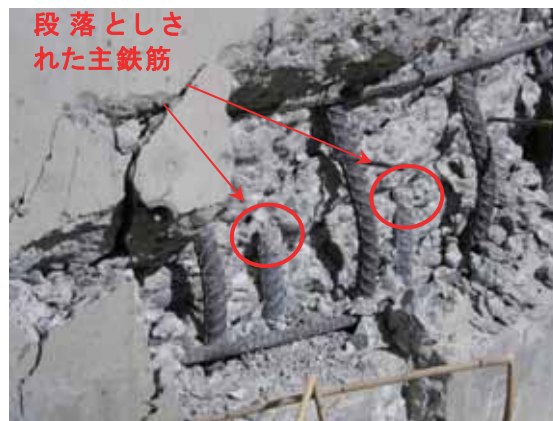
写真-4. 1. 12. 5 P7 橋脚段落し部の損傷状況（A2 側）
