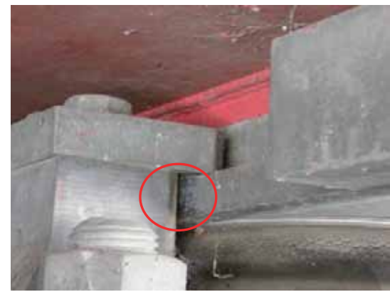
写真-4.4.6.13 A2 橋台ゴム支承下流側側面の状況(擦過痕あり)
