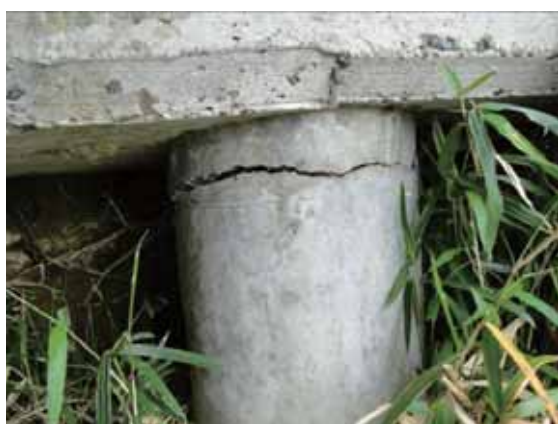
写真-4. 4. 14. 6 左岸側橋台杭の損傷 (写真-4. 4. 14. 5 の丸囲み部)
