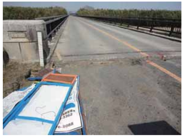
写真-4.4.5.25 A2 橋台背面の段差
