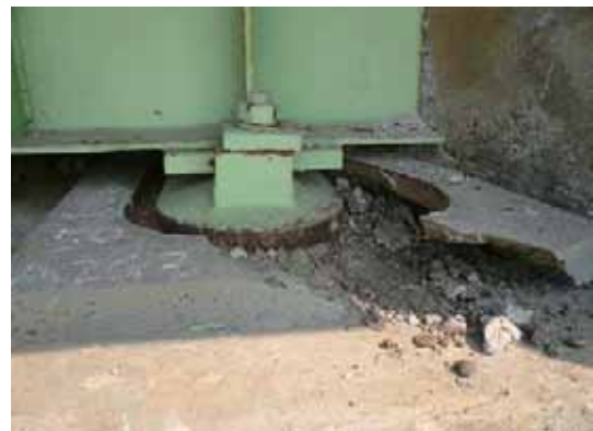
写真-4.4.17.6 沓座モルタルの破損（左岸側橋台）
