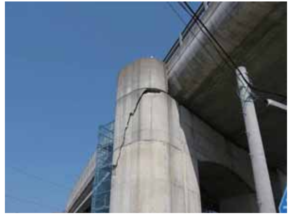
写真-4.3.8.7 ブロック取付部のせん断破壊(南東)
