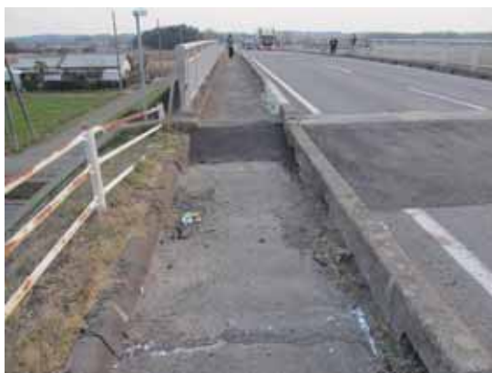
写真-4.4.25.4 歩道部の段差状況(東側橋台)
