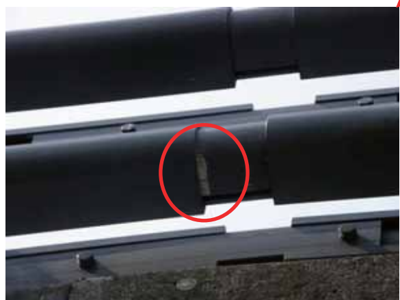
写真-4.4.29.4 防護柵継手部の擦過痕
