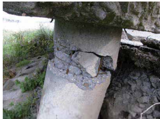
写真-4. 4. 14. 20 右岸側橋台杭の折損
