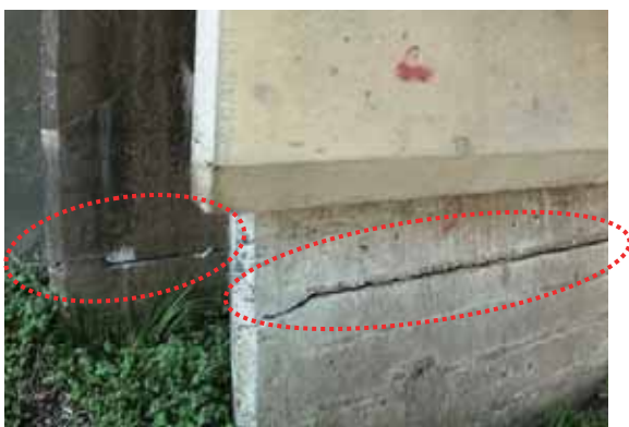
写真-4.4.17.7 橋台躯体の水平ひび割れ（左岸側橋台）
