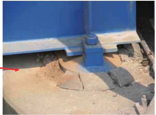
写真-4.4.13.15 固定支承の損傷
