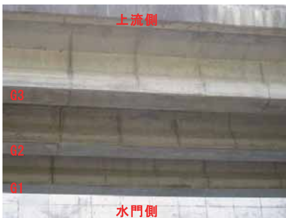
写真-4.1.19.5 4径間目主桁の損傷状況
