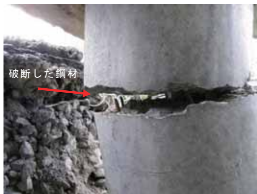
写真-4. 4. 14. 19 右岸側橋台杭の折損
