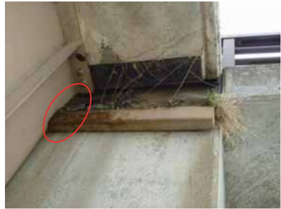
写真-4.2.13.15 A2 桁端部床版下面：伸縮装置の排水管が主桁と接触し変形
