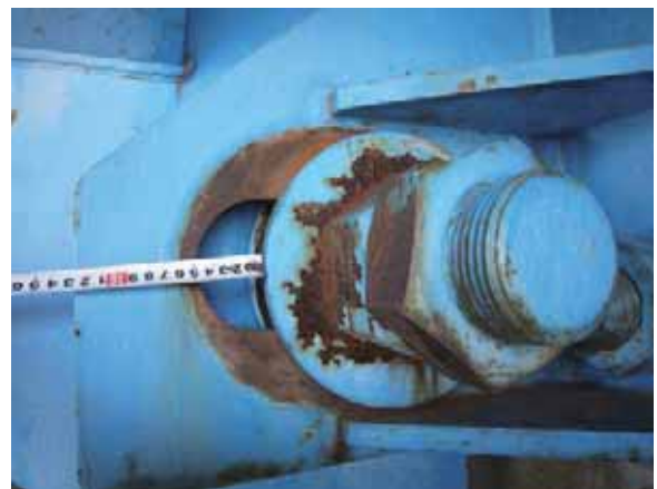
写真-4.5.5.3 橋脚が 6cm前面に移動した痕跡
