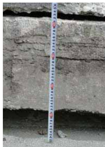
(d) コンクリート壁と陸側歩道との鉛直変位(約35cm)
