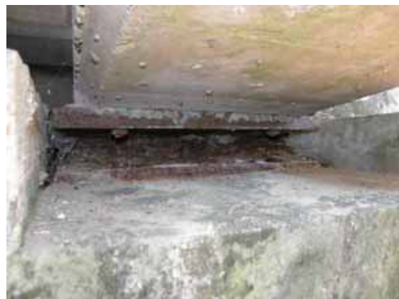
写真-4.4.4.3 RC 桁の支承(下流側)：腐食が生じているものの、セットボルトの損傷等は確認されず
