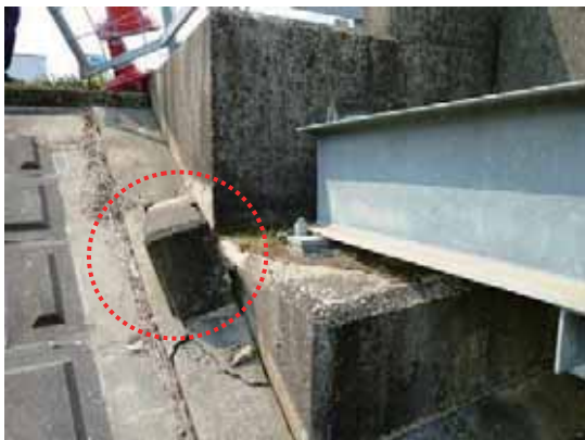
写真-4. 4. 20. 4 橋台周辺のブロックの破損(右岸側)
