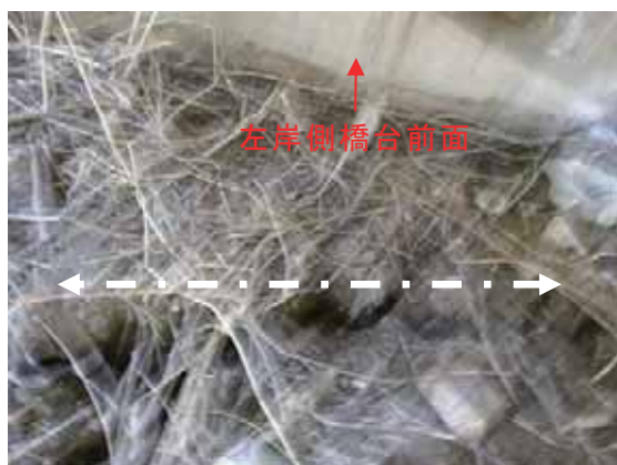
写真-4.4.4.10 橋台前面地盤のひび割れ
