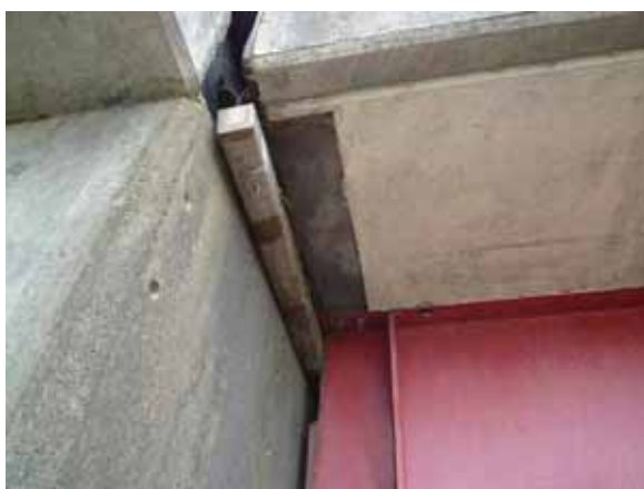
写真-4.2.12.14 A2 桁端部床版下面：伸縮装置の排水管が少し主桁に押しつぶされている
