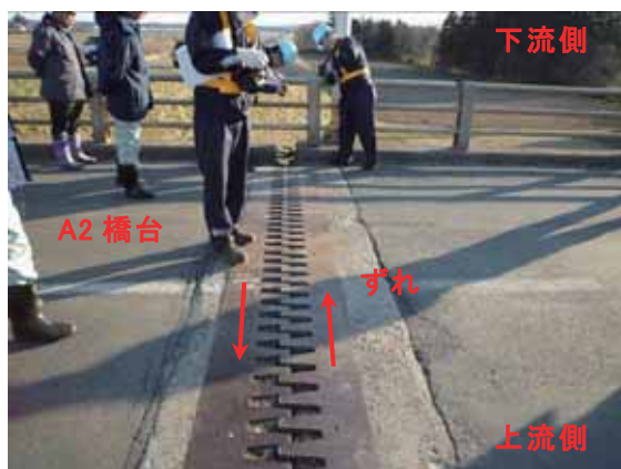
写真-4.1.11.2 A2 橋台上の伸縮装置：桁と橋台間における橋軸直角方向のずれ
