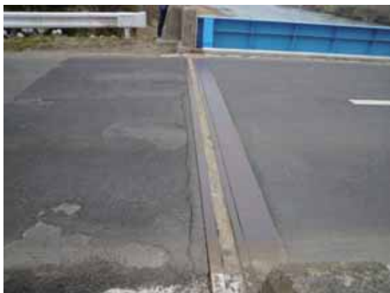
写真-4.1.8.2 背面段差状況(右岸 A1 側)
