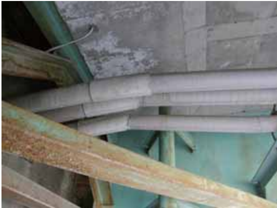
写真-4. 2. 10. 12 添架物の損傷
