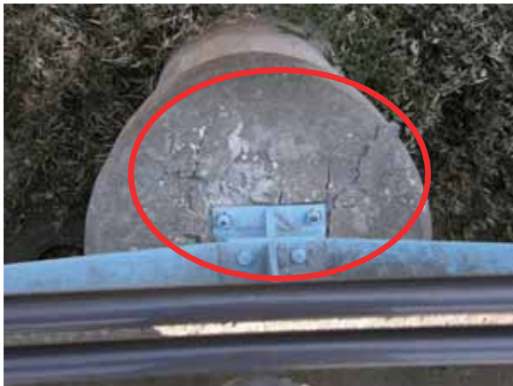
写真-4. 4. 5. 30 固定支承橋座部の損傷
