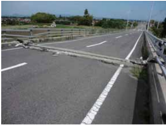
写真-4.3.14.8 A1 橋台部の損傷
