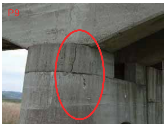
写真-4.6.1.4 P9橋脚可動支承周りの損傷
