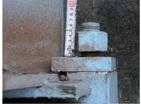
写真-4.4.5.17 A1橋台下流側支承アンカ ーボルトの伸び出し(約1cm)
