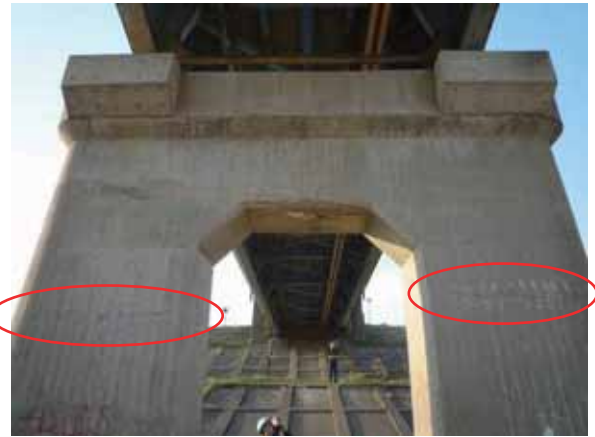
写真-4.2.11.14 P1 橋脚中間部のひび割れ (P2 側より撮影)
