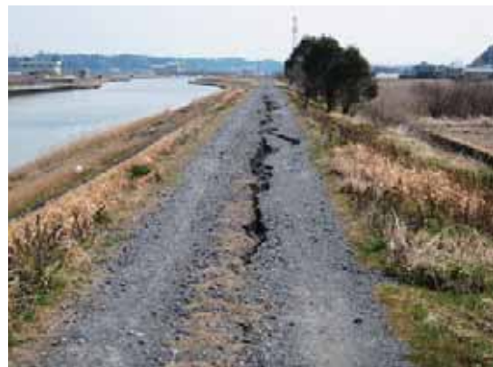
写真-4. 4. 20. 5 右岸下流側の堤防の亀裂
