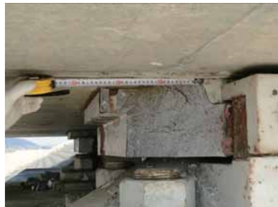
写真-4.4.3.13 A2 橋台支承(下流側)：沓座の割れ、全ての上沓セットボルトの破断、上沓の破壊
