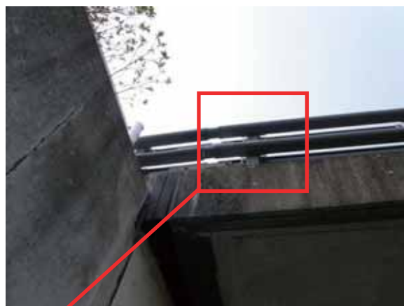
写真-4.4.29.3 A1 橋台付近の防護柵継手部
