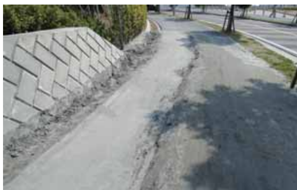
写真-4.5.6.7 噴砂痕(護岸背後の歩道)
