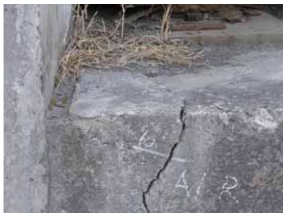
写真-4.2.10.10 A1橋台下流側橋座部(写 真-4.2.10.7の拡大)：G5桁支承の後ろか ら側面にかけて10mmのひび割れ、数mmの 段差(前側が低い)、既往の補修モルタル痕 もみられる
