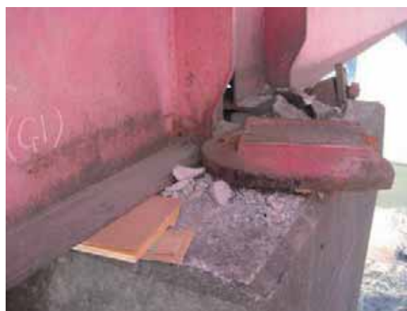
写真-4.2.18.5 P2 橋脚上の支承の破壊 (資料提供：仙台市)
