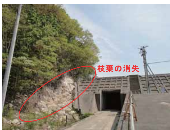
写真-4. 1. 19. 14 樹木の状況 (上流左岸側)
