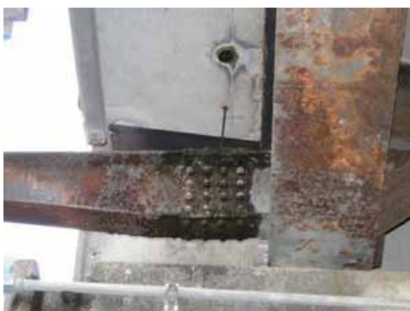
(c) 支承部付近の腐蝕状況
