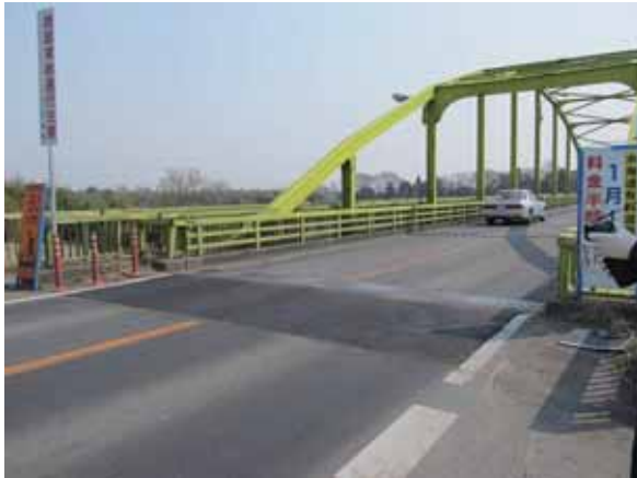
写真-4.4.28.2 A2 橋台背面の段差 (補修済)
