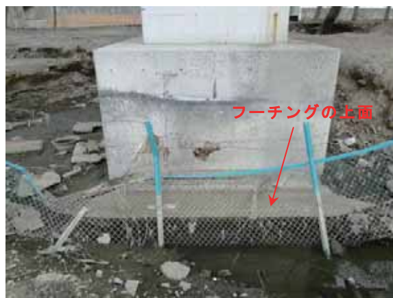
写真-4. 2. 7. 12 橋脚基部の洗掘状況
