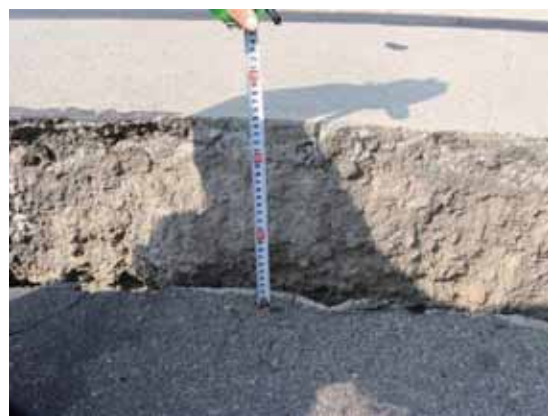
写真-4.3.2.3 南側橋台背面の沈下 (約 23cm)
