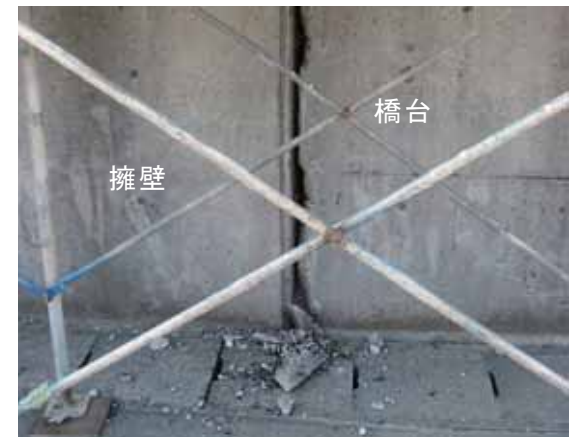
写真-4. 3. 8. 20 橋台と擁壁の衝突痕
