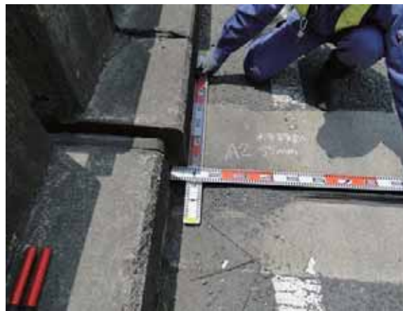
写真-4.2.19.11 4月7日の余震後のA2橋台部における上部構造の橋軸直角方向への移動(70mm)(資料提供:宮城県)
