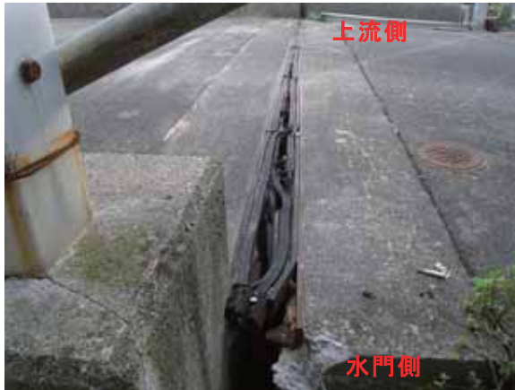
(a) 水門堰柱P1 上の伸縮装置：下流側に開きがあり、ゴムの破断を確認
