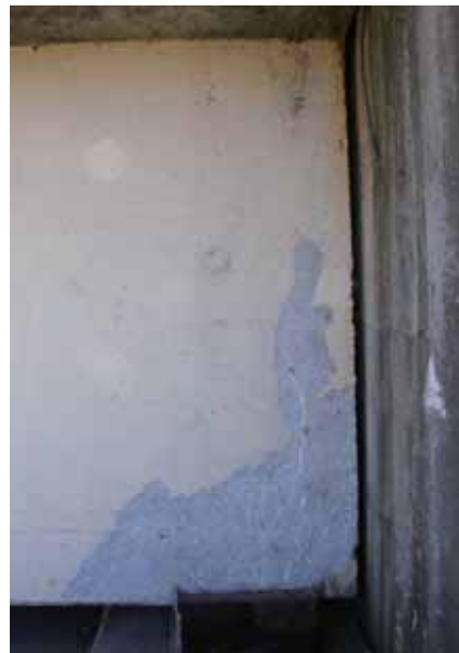
写真-4.2.14.5 A2側桁端部ひび割れ (補修後に撮影)
