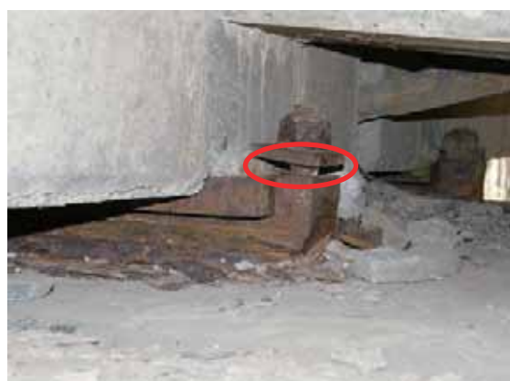
写真-4.1.13.4 P3 橋脚 G3 桁端部の損傷： 取付ボルトの伸び出し等
