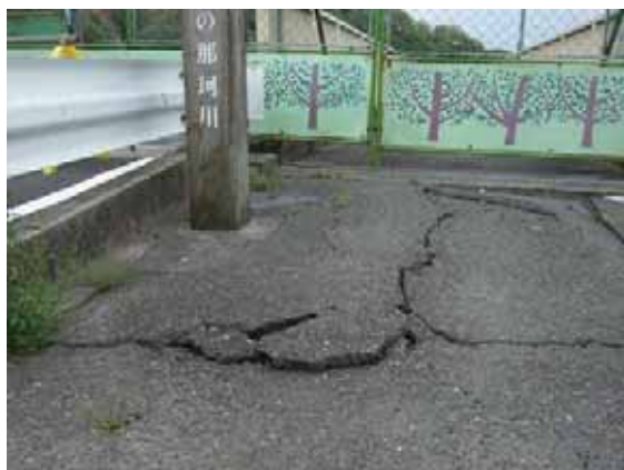
写真-4.6.1.2 A2 橋台背面の段差(路肩部)
