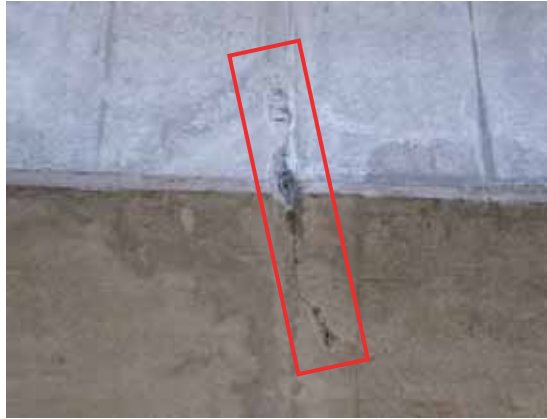
写真-4.1.12.16 箱桁の斜めひび割れ及び欠け落ち
