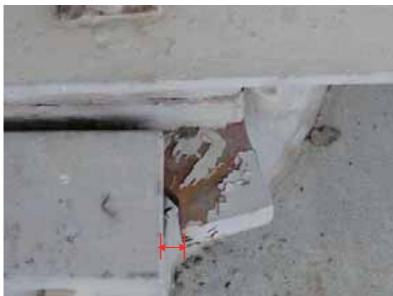
写真-4.2.13.18 A2 橋台上の上流側支承桁支間側ストッパーの変形とすき間(約 9mm)
