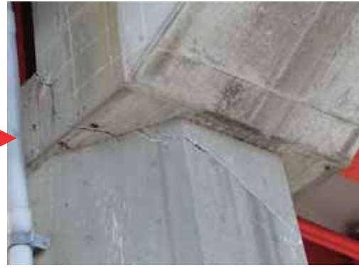
(b) ひび割れ部の拡大
