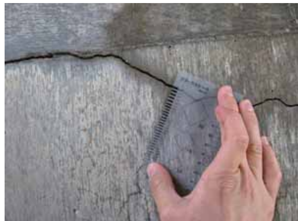
写真-4.3.3.9 側道橋南側橋台の水平ひび割れ
