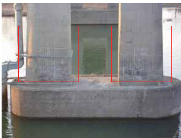
写真-4.2.11.20 P8 橋脚基部の損傷(A2 側より)
