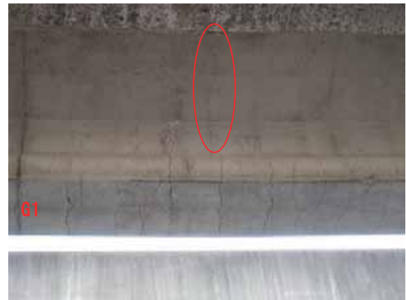
写真-4.1.19.4 3径間目G1桁の床版まで 達するひび割れ
