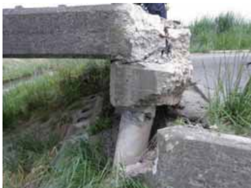
写真-4. 4. 14. 17 右岸側橋台部の損傷
