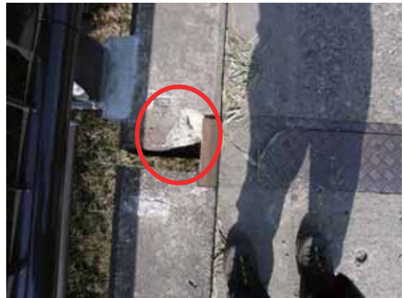
写真-4. 4. 5. 31 上部構造地覆部の損傷
