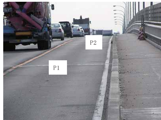
写真-4.2.14.9 A1～P3 上の桁の橋軸直角方向のずれ、回転
