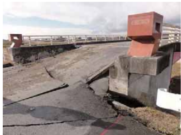
写真-4.2.17.3 右岸側橋台アプローチ部の沈下および翼壁下端の露出
