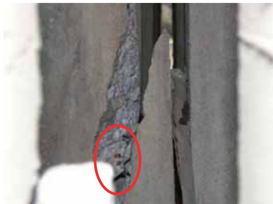
写真-4.1.13.3 P3 橋脚 G4 桁端部の損傷： コンクリートの剥離、PC 鋼材端部の露出等
