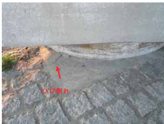
写真-4.5.11.6 香取市側堤体内橋脚周辺部のひび割れ
