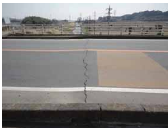
写真-4.4.6.19 A2 橋台背面ボックスカルバート～土工境界部のひび割れ
