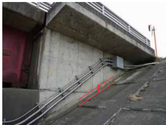
写真-4.2.12.11 A1 橋台側面：堤体の沈下がみられる
