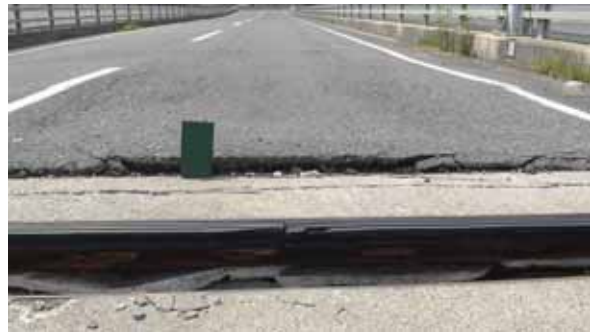
写真-4.3.14.5 A2 橋台背面舗装の 盛上がり
