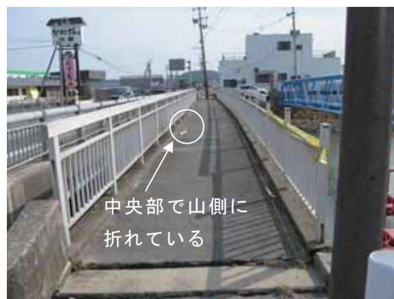
写真-4.3.3.10 側道橋の軸線のずれ
