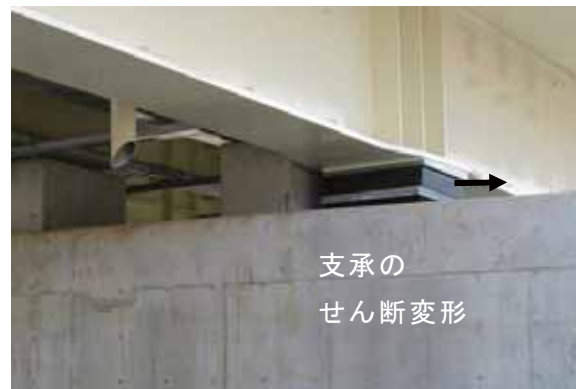
写真-4.3.11.3 橋脚部支承の変形
