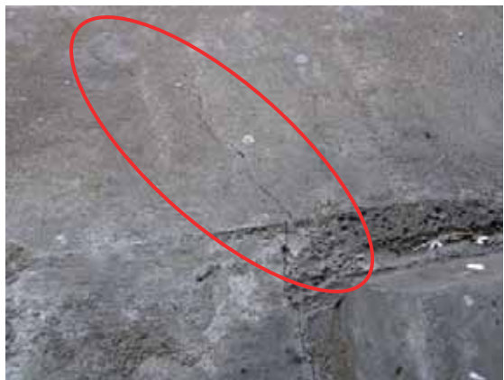
写真-4.1.7.10 P6 橋脚橋座部のひび割れ(拡大)
