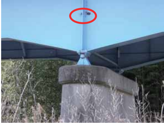
写真-4.4.5.22 下流側主桁外側の損傷 (P2)：横桁下フランジ位置での塗膜はがれ
