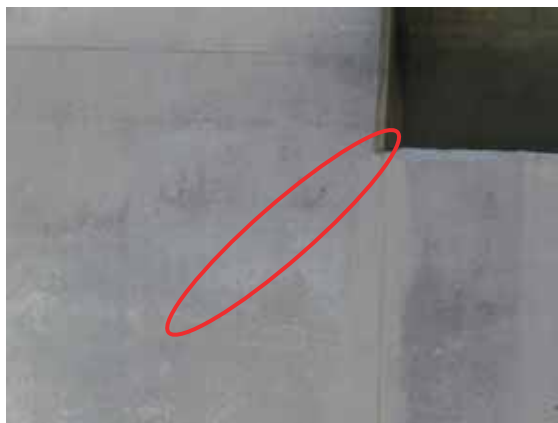
写真-4. 1. 11. 7 P6 橋脚上のコンクリート ブロック隅角部の斜めひび割れ
