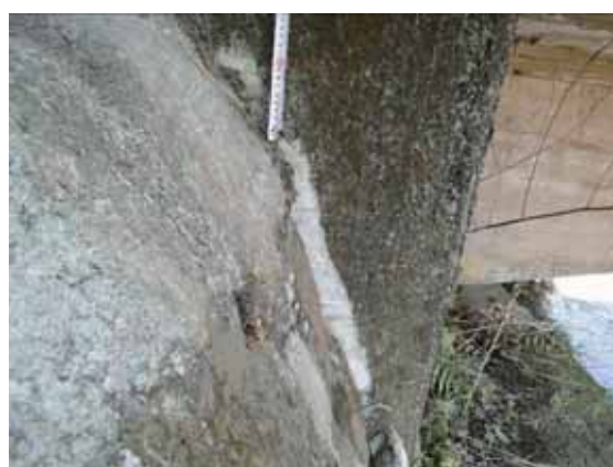
写真-4.4.4.7 右岸橋台盛土の沈下 (約 2cm)
