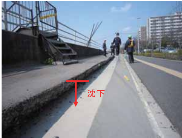
写真-4.5.9.9 左岸護岸背面土の沈下 (今川橋～境川中央歩道橋間)
