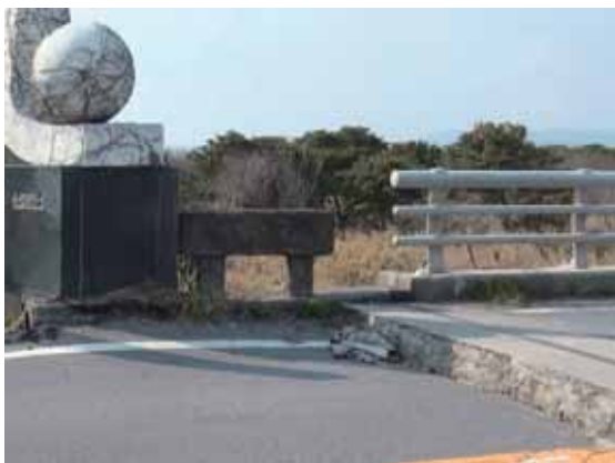
写真-4.3.2.2 南側橋台部の段差
