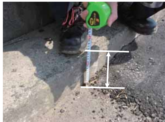
写真-4.3.7.3 北側橋台背面の沈下 (約 12cm)
