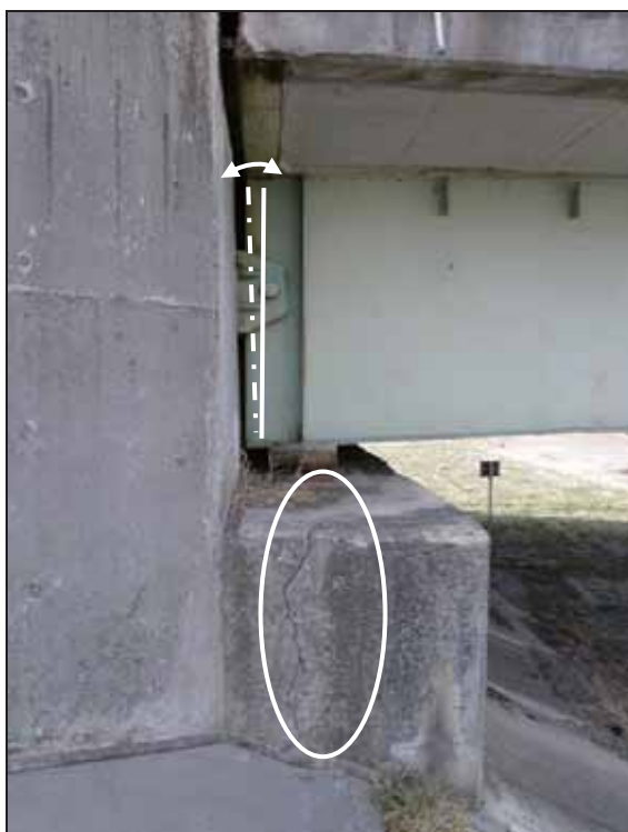
写真-4.2.10.7 A1橋台、桁端部の状況： 桁端部のつまり（回転）、橋座部のひび割れ 等が発生
