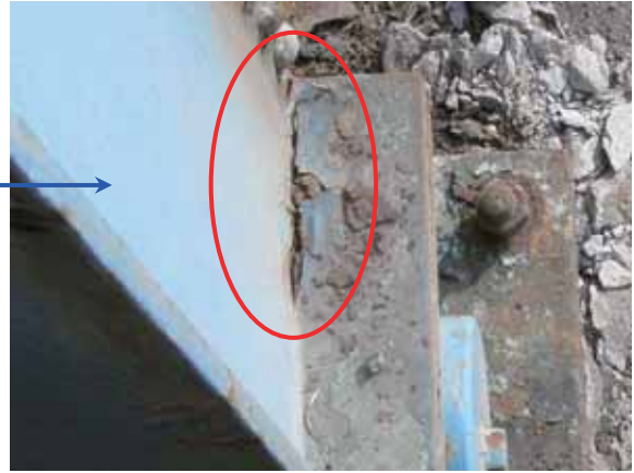
写真-4. 1. 16. 6 支承上側鋼板の塗膜割れ
