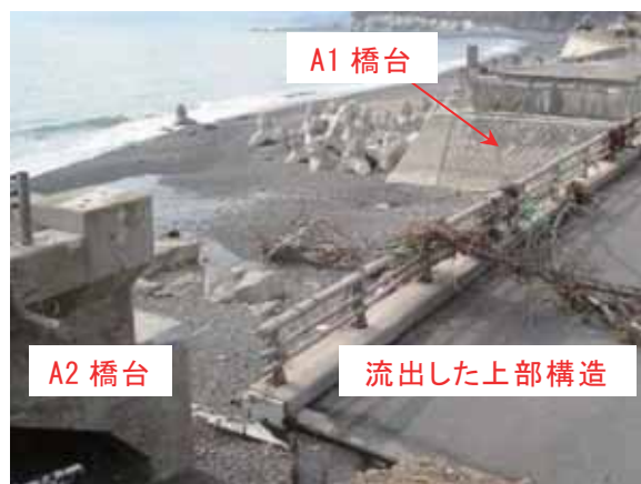
写真-4.1.17.2 被災時の状況 (岩手県提供)
