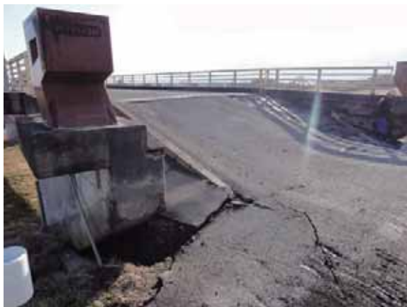
写真-4.2.17.2 左岸側橋台アプローチ部の沈下および翼壁下端の露出
