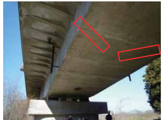
写真-4.1.12.15 箱桁底面の斜めひび割れ
