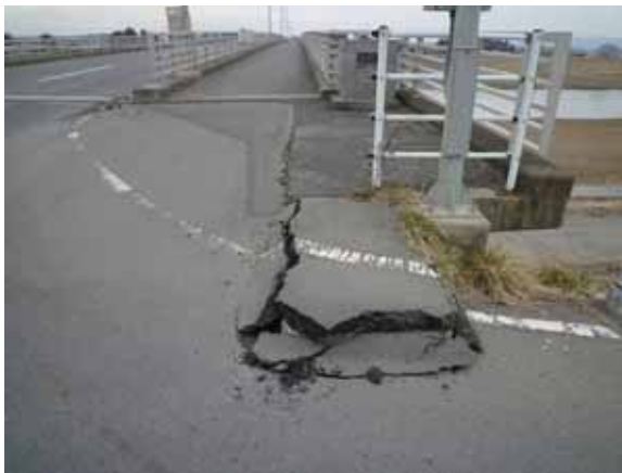
写真-4.2.12.6 橋台背面段差(右岸 A1 側)
