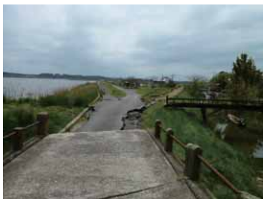
写真-4. 4. 14. 21 周辺道路の沈下(右岸側)
