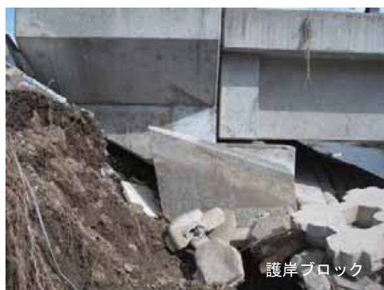
写真-4.1.6.4 橋台背面盛土の流出(右岸下流側)
