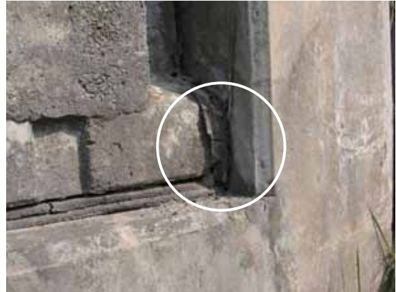
写真-4.3.3.7 側道橋南側橋台部における桁端部のひび割れ
