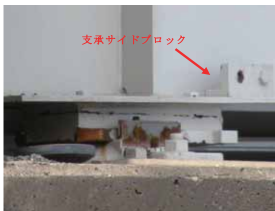
写真-4.4.30.6 支承サイドブロックの 破損 (P29 起点側-南側)
