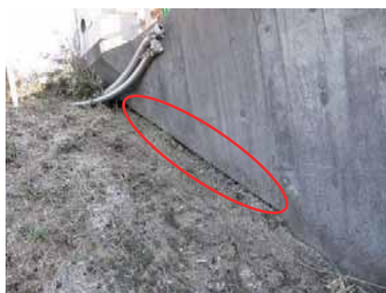
写真-4. 1. 11. 9 A2 橋台翼壁下のすき間
