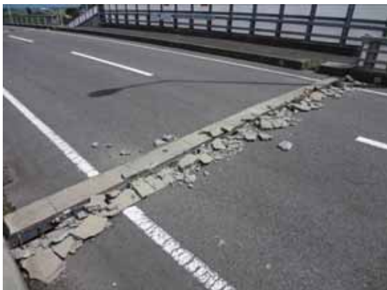
写真-4.3.14.6 跨線部(西側)での伸縮装 置の損傷(P4 橋脚上)
