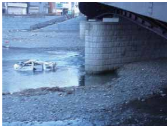
写真-4.1.1.3 橋脚上流側の洗掘状況
