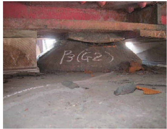
写真-4.2.18.7 P3 橋脚上の G1 桁の支承の損傷(資料提供：仙台市)
