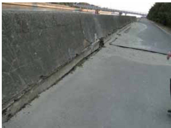
(c) コンクリート壁と陸側歩道との間に生じた沈下
