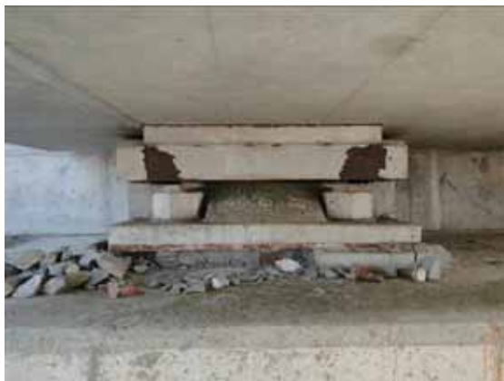
写真-4.4.3.12 A2 橋台支承(上流側)：沓座の割れ、全ての上沓セットボルトの破断
