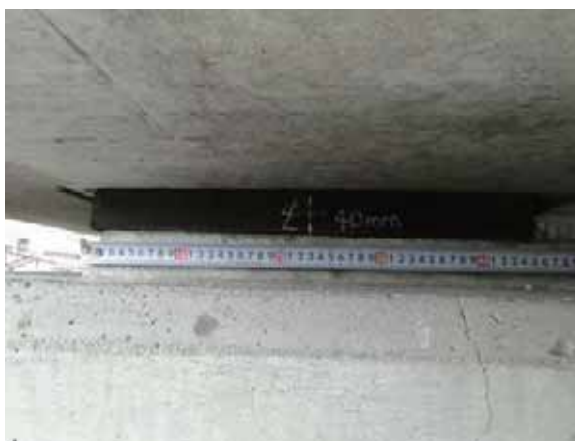
(a) ゴム支承の側方への移動 (40mm) (G4 主桁)
