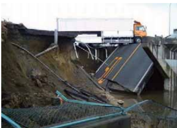
写真-4.2.7.9 右岸側橋台背面盛土の流出(3月11日地震直後の状況、宮城県より)
