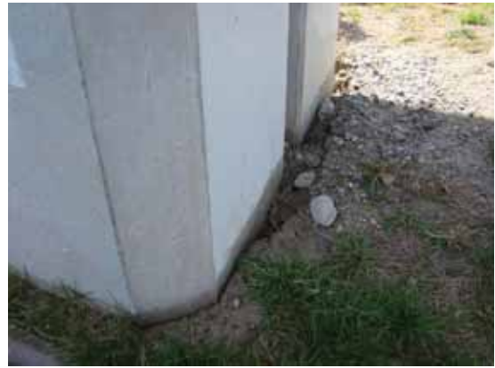
写真-4.4.1.6 橋脚周り移動跡 (P3)
