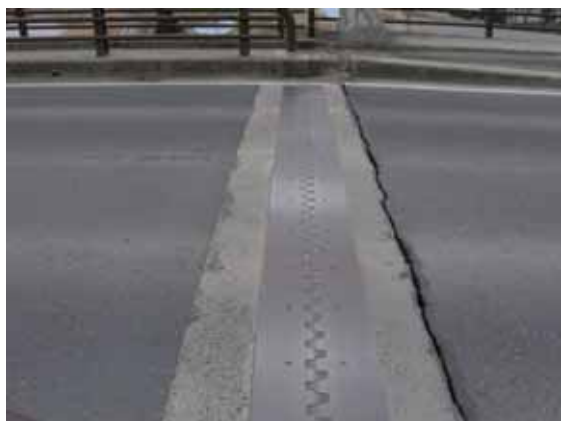
写真-4. 2. 13. 6 A1 橋台背面の舗装ひび割れ、伸縮装置遊間のつまり
