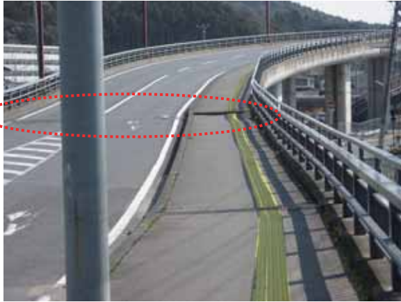
写真-4. 3. 8. 15 西側橋台部の段差
