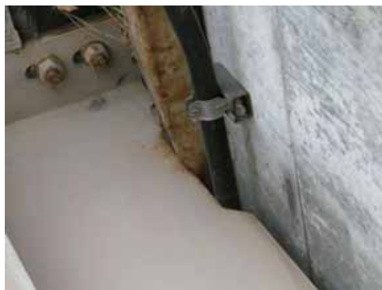
写真-4.2.13.9 A1 桁端部床版下面：伸縮装置の排水管が主桁と接触
