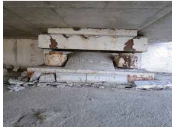
写真-4.4.3.11 A1 橋台支承の損傷：沓座の割れ、ストッパーの塗膜割れ等が確認
