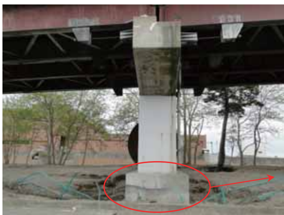
写真-4. 2. 7. 11 橋脚基部の洗掘状況
