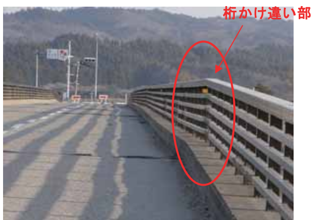
写真-4.2.11.11 上部構造ゲルバー部での折れ
