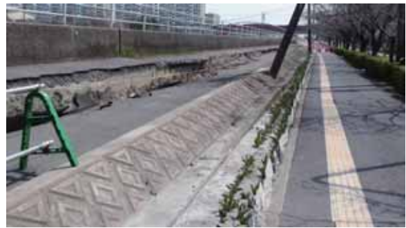
写真-4.5.9.12 右岸護岸背面土の沈下 (境川中央歩道橋～境川橋間)
