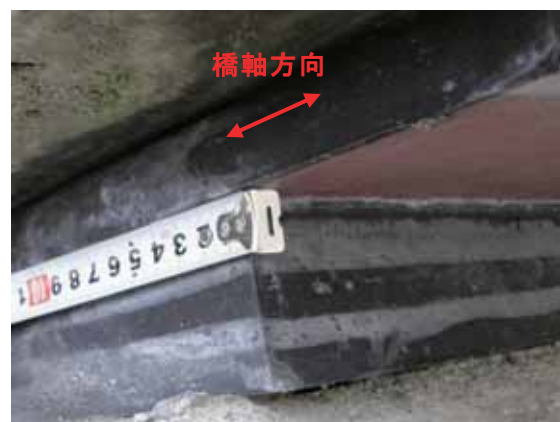
写真-4.1.9.7 橋脚上の支承の橋軸方向への移動(約 1cm)
