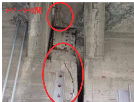
写真-4.6.1.5 P7～P8橋脚間ゲルバー固定支承部の損傷
