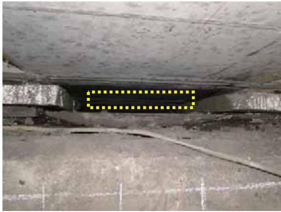
(a) ゴム支承の脱落 (G2 主桁)
