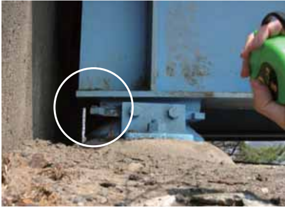
写真-4.3.7.4 橋台部の上沓ストッパーの 損傷
