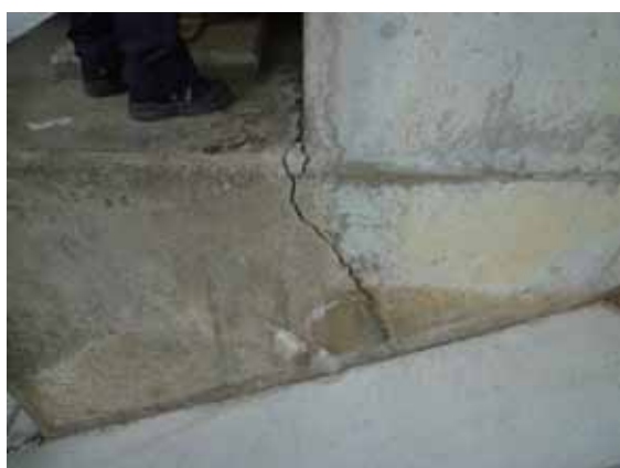
写真-4. 2. 13. 22 A2 橋台ひび割れ
