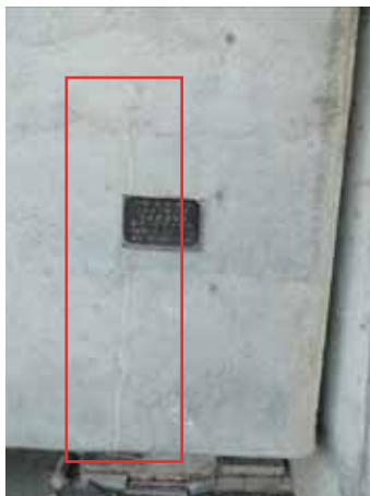
写真-4.4.3.8 A1 橋台側桁端部のひび割れ(幅 0.15mm)
