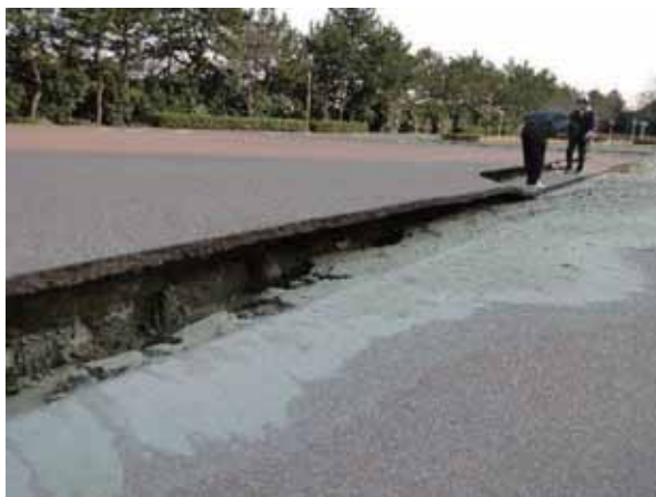
(a) 交通公園内に生じた段差
