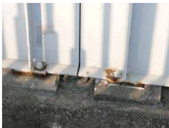
写真-4.5.3.5 沓座モルタルの割れ(中浜橋側道橋)
