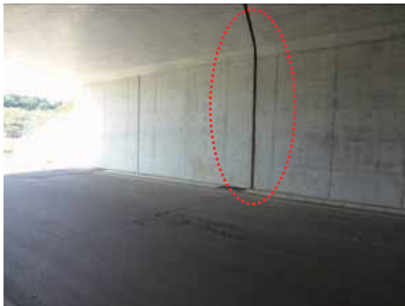
写真-4.3.13.10 カルバート目地部の開き
