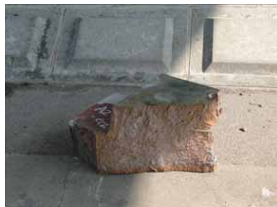
写真-4.4.3.15 上沓の破壊部
