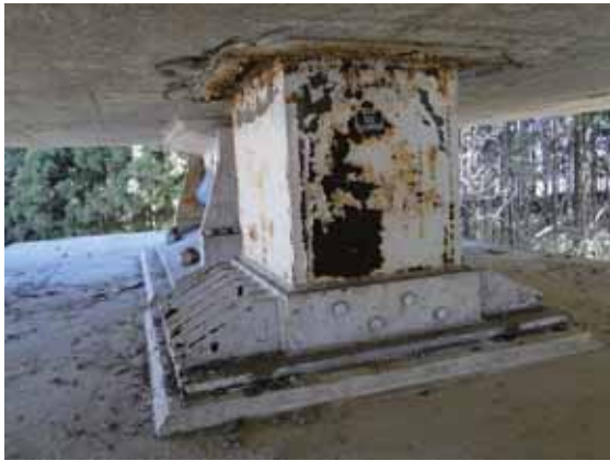
写真-4.1.12.10 P5 橋脚上のストッパー (両方向固定) 取付部のモルタル剥落
