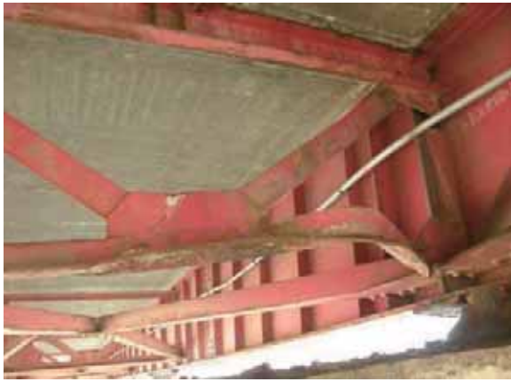
写真-4.2.18.10 P3 橋脚上の対傾構の変形 (資料提供：仙台市)
