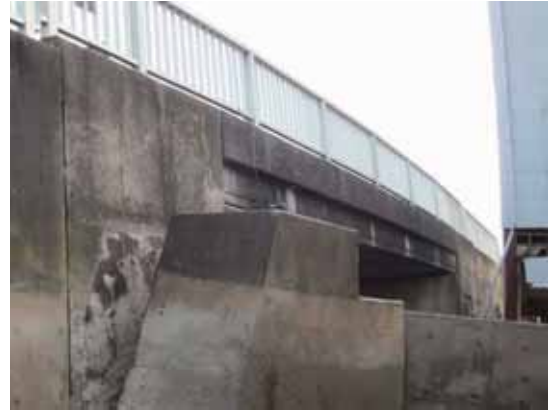
写真-4.3.5.4 新大平橋(写真右側(上流側)に崩落した大平川1号橋がある)
