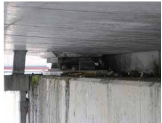
写真-4.3.8.9 サイドストッパーの破損(西側橋台)
