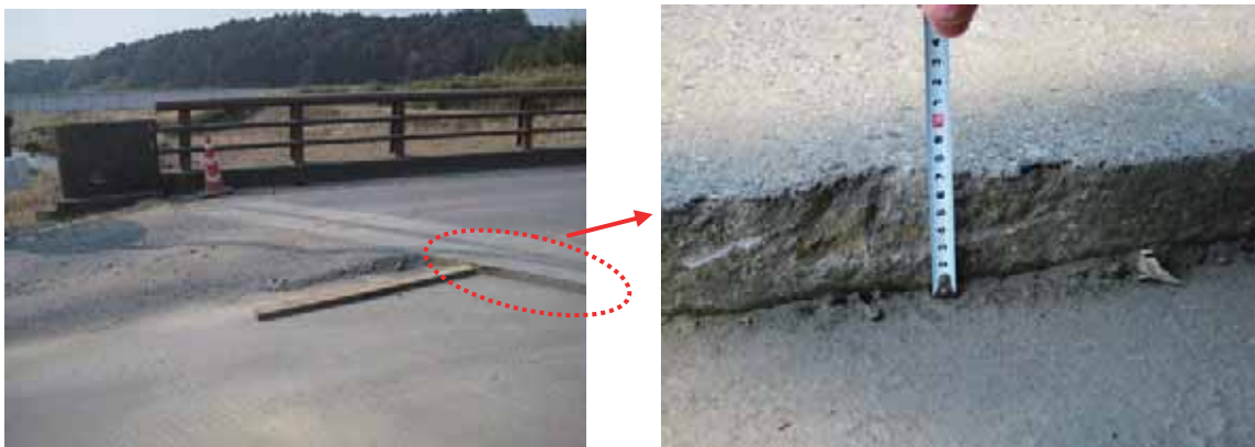
写真-4.4.17.2 左岸側橋台背面部の段差
