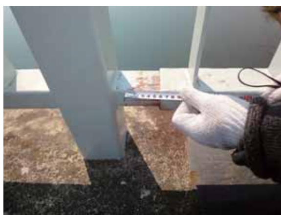
写真-4.4.7.8 高欄の擦過痕
