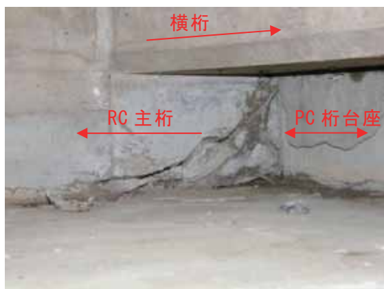
写真-4.4.4.4 RC 桁端部のひび割れ状況 (上流側)
