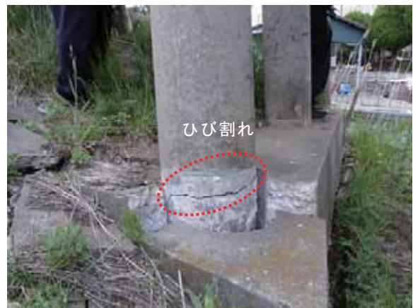
写真-4. 4. 14. 12 右岸側橋脚中間梁の損傷 と杭の水平ひび割れ
