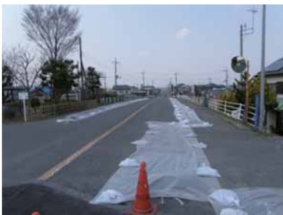
写真-4. 4. 13. 6 右岸側橋台アプローチ部の損傷
