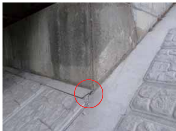
写真-4. 2. 13. 24 A2 橋台たて壁前面角部 : 堤体コンクリートに割れ、浮きが発生
