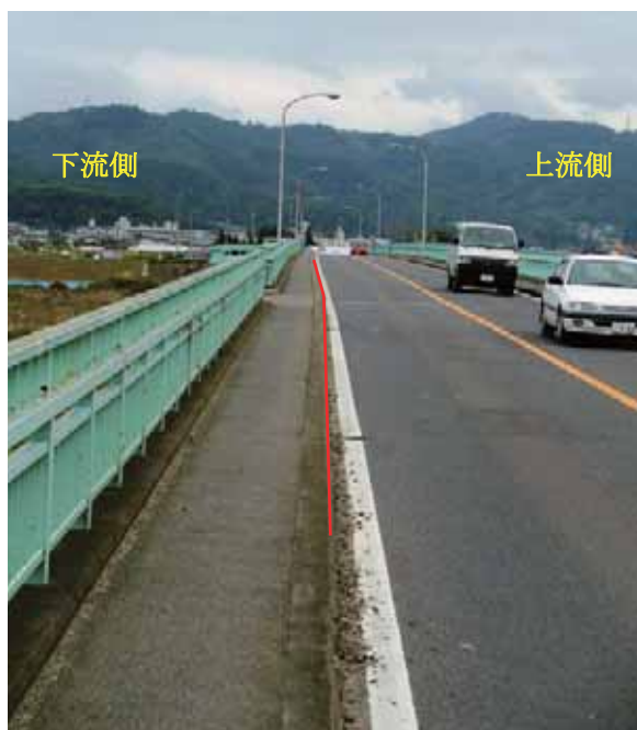
写真-4.3.16.5 P1 橋脚の傾斜に伴う上部構造の回転・移動
