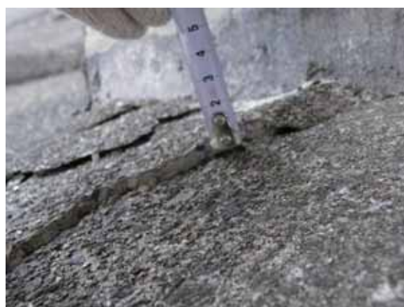
写真-4.2.12.15 A2 橋台たて壁前面角部：前面の堤体コンクリートに割れ・浮きが生じている
