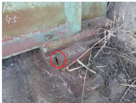
写真-4.2.10.20 A2 橋台支承の状況：前側 サイドブロックとの間にすき間
