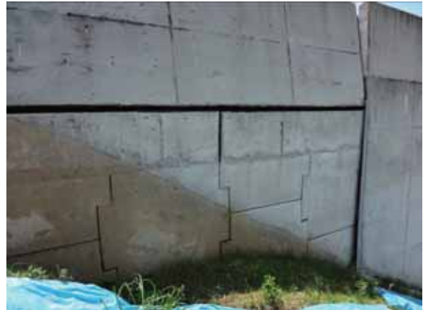
写真-4.3.13.6 補強土壁の変状 (福島空港 IC 側橋台下り線側)
