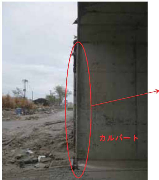
写真-4.2.7.7 左岸側カルバート背面盛土の橋軸直角方向の変状
