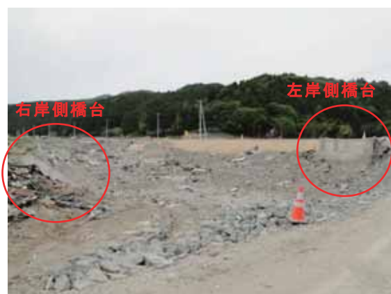
写真-4.2.3.2 被災状況
