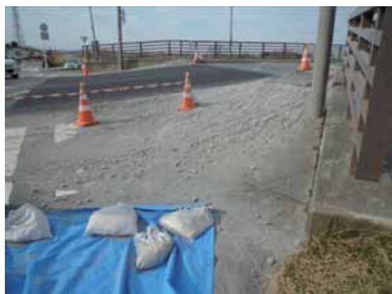
写真-4. 2. 10. 5 橋台背面段差(右岸 A1 側)
