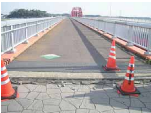
写真-4.5.1.23 側道橋 A2 橋台部の段差
