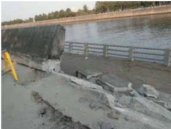
(a) 倒壊したコンクリート壁と周辺地盤
