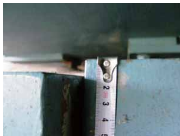
写真-4.3.15.11 落橋防止構造取り付けブラケットの下方へのずれ (A2 側)
