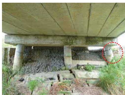
写真-4. 4. 14. 18 右岸側橋台杭の折損
