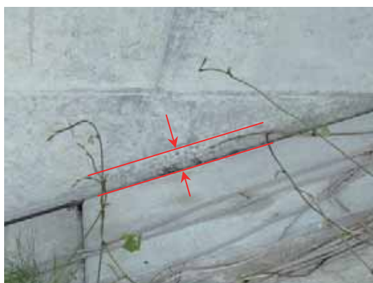
写真-4.2.15.4 堤防盛土の沈下
