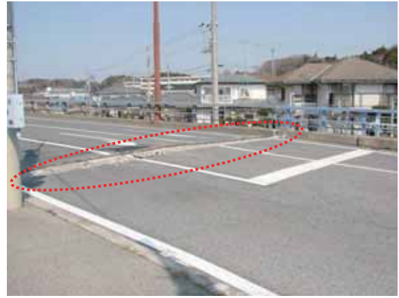
写真-4. 3. 8. 16 東側橋台部の段差
