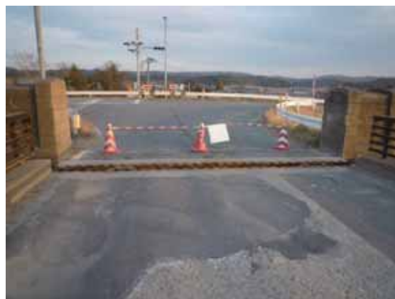
写真-4.2.11.28 伸縮装置部段差(右岸 A2)
