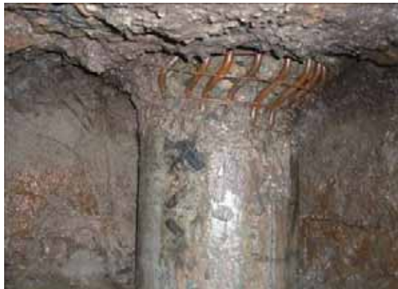
(b) A2 橋台上流側の杭の状況
