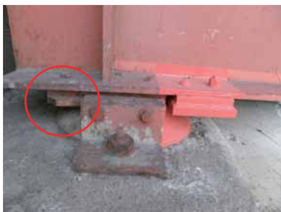
写真-4. 3. 17. 9 上沓のストッパーの破損
