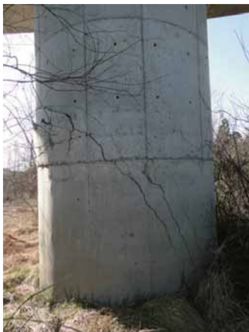
写真-4.1.12.2 P8 橋脚段落し部の損傷状況(側面)
