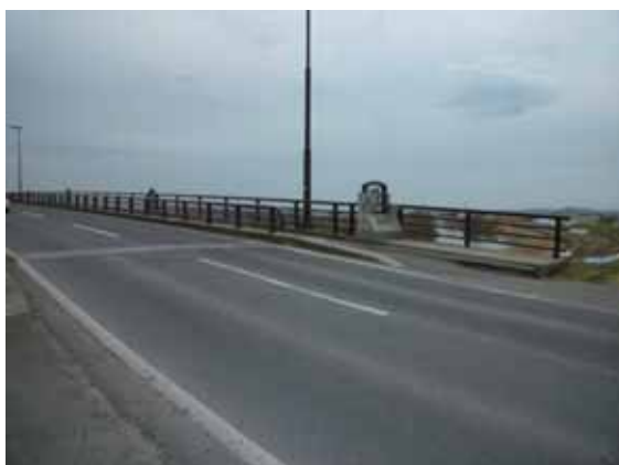
写真-4. 2. 13. 4 A1 橋台背面段差 (右岸側)
