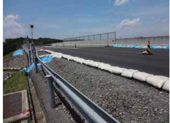
写真-4.3.13.4 橋台背面の沈下 (福島空港 IC 側橋台上り線側)
