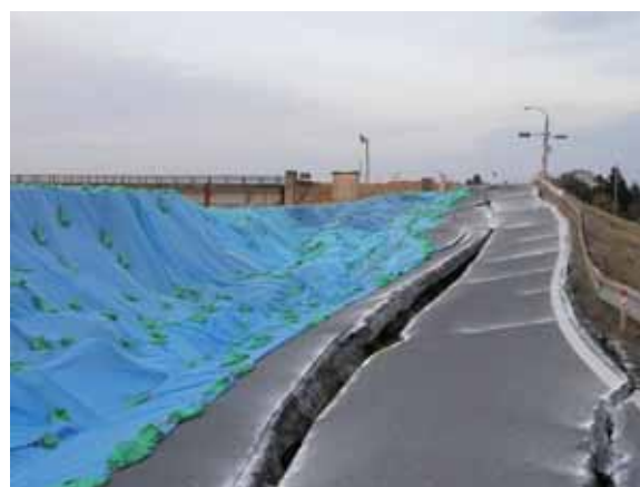
写真-4.2.11.4 左岸(A2 下流側)の堤体 状況：堤体が崩れ、背面の道路も著しい 変形、損傷が発生
