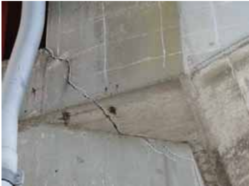
(c) ひび割れ部の拡大(正面側)
