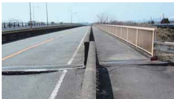
写真-4. 3. 12. 7 左岸側橋台部のずれと段差
