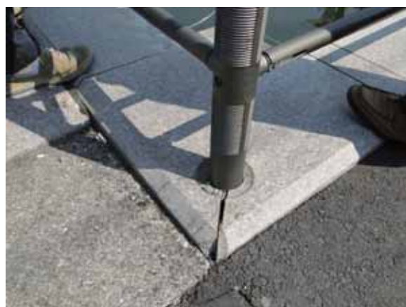
写真-4.5.10.5 橋梁取付護岸(右岸側) 天端の化粧タイルの割れ
