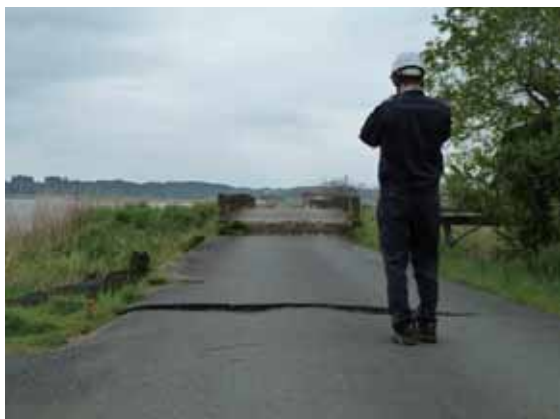
写真-4.4.14.2 左岸側橋台背面の段差
