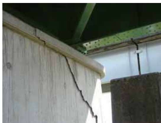
写真-4.4.2.5 P1 橋脚コンクリート浮き
