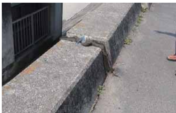
写真-4.5.6.8 樋門付近の護岸の沈下
