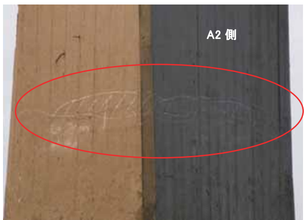
写真-4.2.11.21 P8 橋脚上流側柱中間部のひび割れ(A2 側ではコンクリートの浮きを確認)
