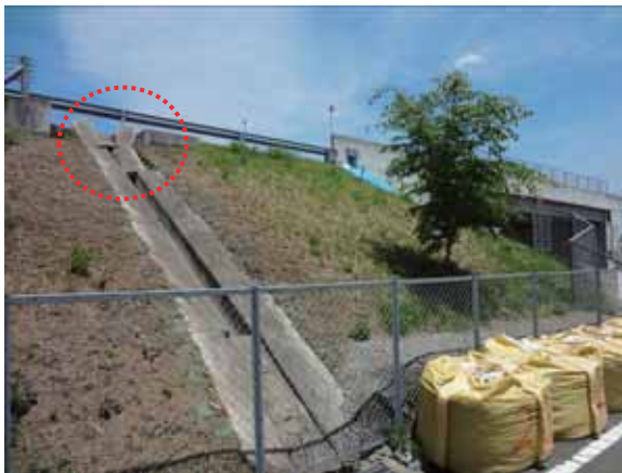
写真-4.3.13.5 のり面縦排水溝の損傷 (矢吹 IC 側橋台上り線側)
