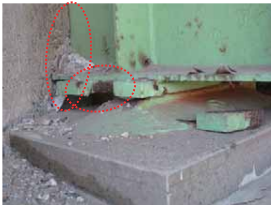
写真-4.4.17.5 桁と橋台パラペットの衝突痕とサイドブロック破損（左岸側橋台）
