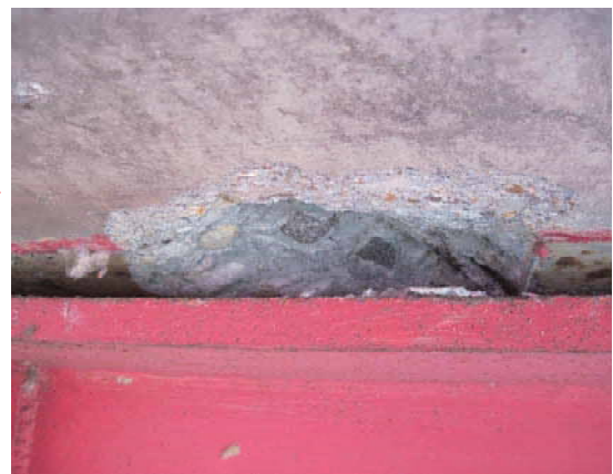
写真-4.2.18.13 P3 橋脚上における上フラン ジ接合部付近の床版の損傷(資料提供： 仙台市)
