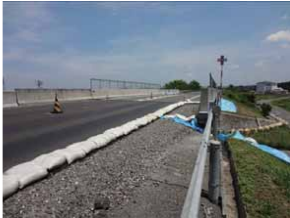
写真-4.3.13.3 橋台背面の沈下 (矢吹 IC 側橋台上り線側)
