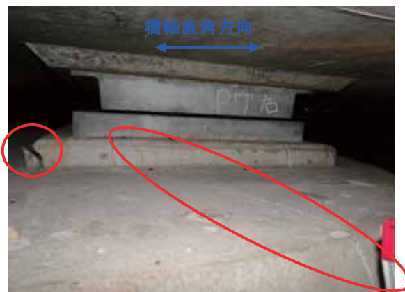
写真-4.1.10.3 P7 橋脚の変位制限構造： 沓座モルタルの割れ、橋脚天端のひび割れ
