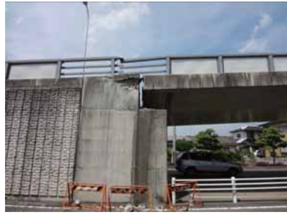
写真-4.3.14.3 橋台と桁の衝突による 損傷(西側の A2 橋台部)
