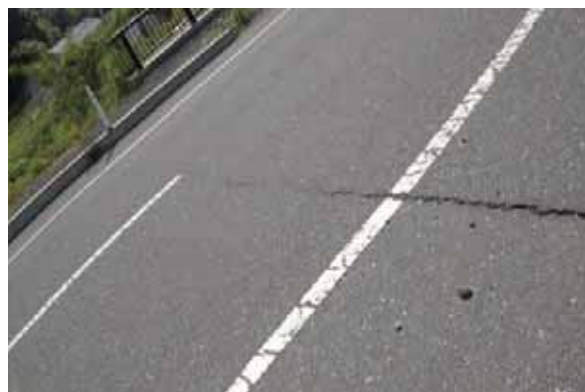
写真-4.2.15.3 車道部アスファルトのひ び割れ、ただし段差はほとんど無い
