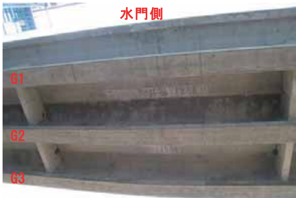
写真-4.1.19.3 3径間目主桁の損傷状況
