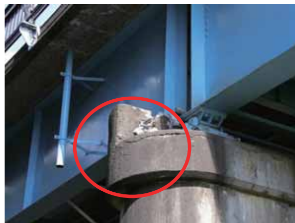
写真-4.4.5.3 P6 橋脚かけ違い状況 (上流側より)
