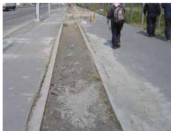
(b) 噴砂痕、縁石の傾斜
