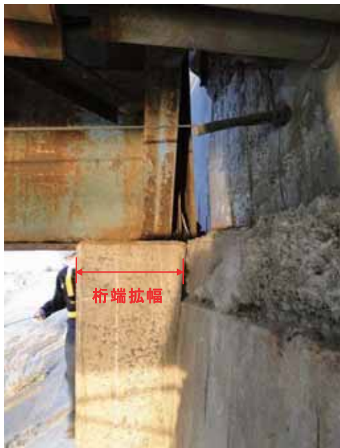
写真-4. 2. 11. 25 A2 橋台上主桁の脱落(G1 桁内側より撮影)
