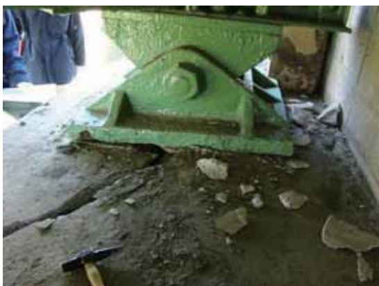
写真-4.4.2.2 A1 橋台沓座ひび割れ
