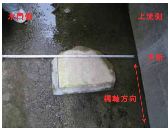
写真-4. 1. 20. 3 水門堰柱P2 支点上の移動 (2 径間側) : 約 70cm上流側に移動
