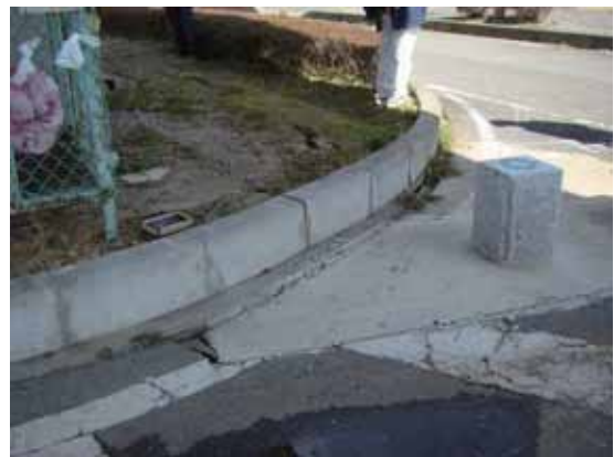
写真-4.4.1.8 側道路面ひびわれ (P10)
