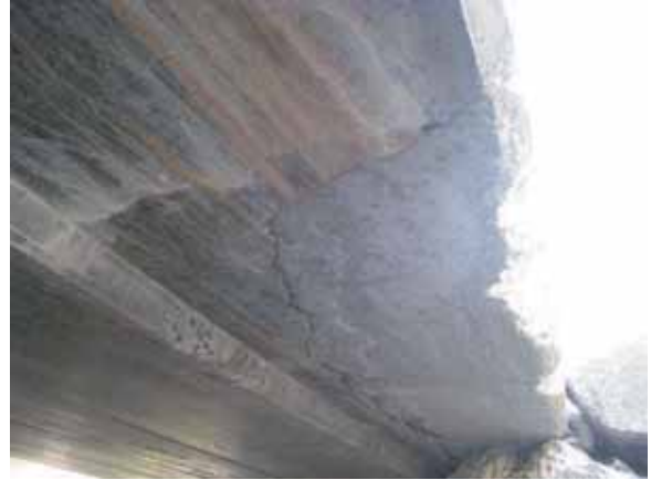
写真-4.1.18.8 陸側地覆部下面の損傷
