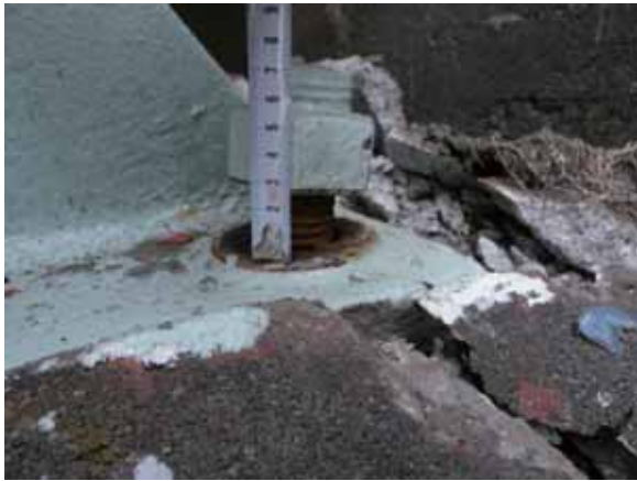
写真-4.4.13.8 左岸側橋台部支承アンカーボルトの抜出し
