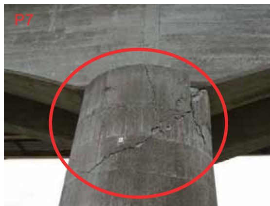
写真-4.6.1.3 P7橋脚可動支承周りの損傷
