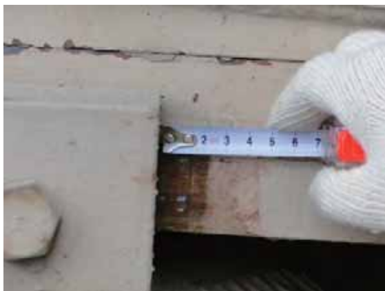
写真-4.2.13.16 A2 橋台上の下流側支承側面の擦過痕(約 14mm)
