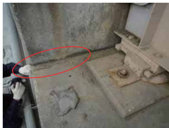
写真-4.2.13.13 A1 橋台ひび割れ(橋座部)
