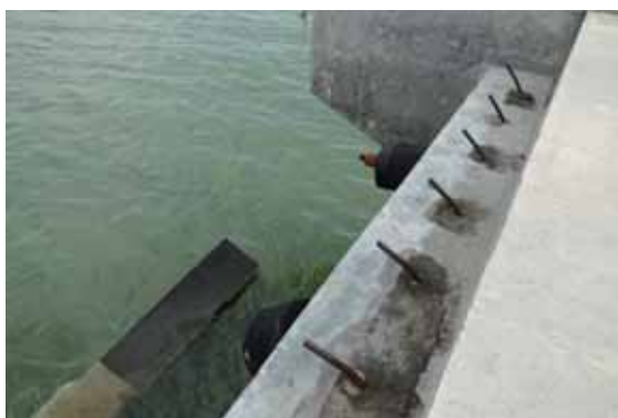
(a) 流出した踏掛版のアンカーバー(左岸側)
