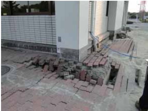
(a) 建物付近の地盤の変状
