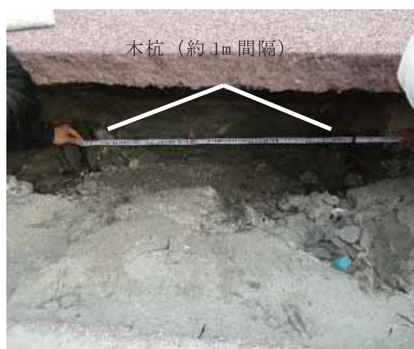
(c) 沈下しなかった箇所に施工されていた 木杭(約 1m間隔)
