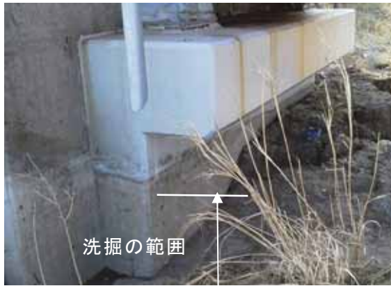
写真-4.3.2.4 橋台前面の洗掘
