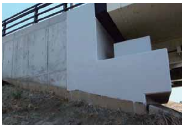
写真-4. 3. 11. 6 左岸側橋台周辺土の沈下
