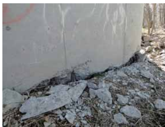
写真-4. 1. 12. 7 P5 橋脚段落し部の損傷状況（A2 側）
