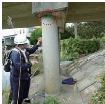
写真-4. 4. 14. 8 左岸側橋脚の傾斜
