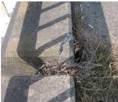
写真-4.3.7.6 北側第1径間南端部地覆の損傷
