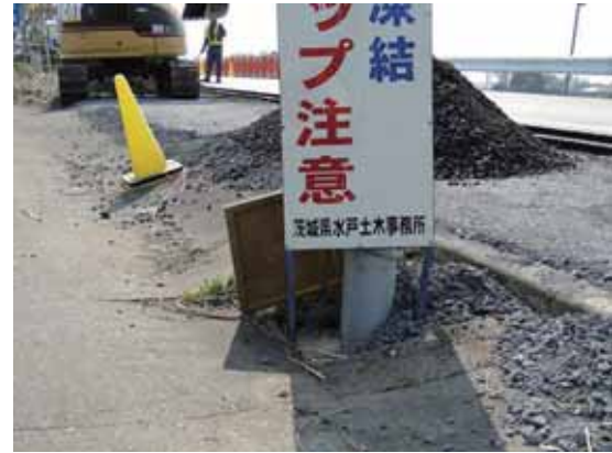
写真-4.4.9.2 橋台背面の沈下と修復状況
