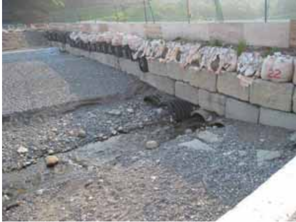
写真-4.1.17.7 仮設道路下の排水管
