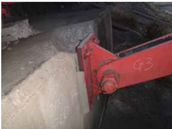
写真-4.3.17.6 アンカーの引き抜きの 状況 (A2 橋台 G3 桁)
