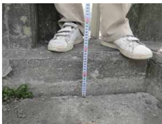
写真-4.1.16.3 右岸側橋台背面の段差(約 8cm)
