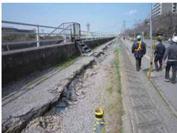
写真-4.5.9.7 左岸護岸背面土の沈下 (今川橋～境川中央歩道橋間)
