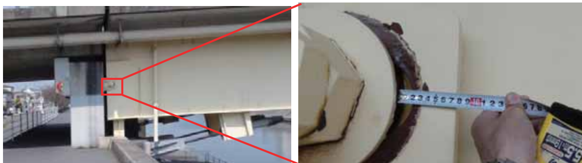
写真-4.5.6.2 橋脚が 3cm 前面に移動した痕跡
