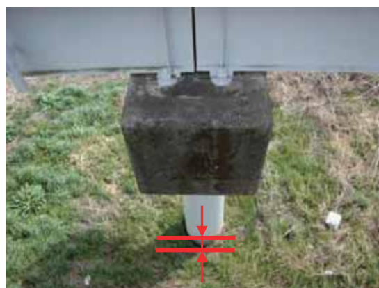
写真-4.4.2.9 側道部橋脚の傾き
