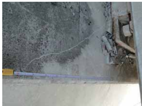
写真-4.4.3.7 A2 橋台橋座部の斜めひび割れ(上流側支承の外側)
