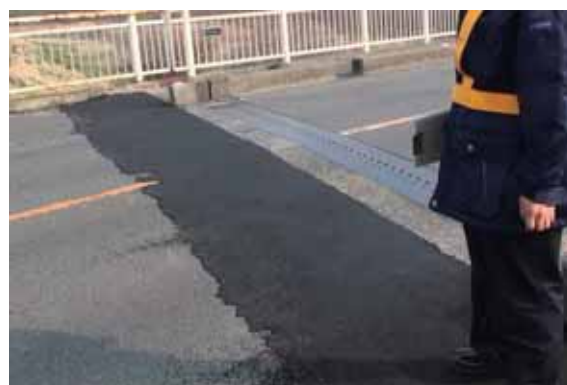
写真-4.3.1.5 北側橋台背面の段差補修痕
