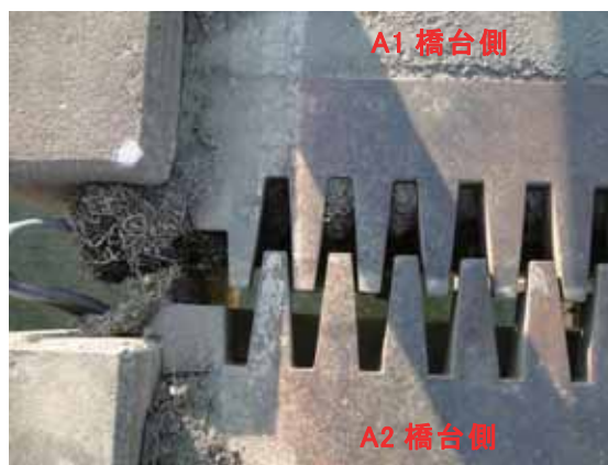
写真-4.1.11.3 中央ヒンジ部の伸縮装置：遊間の開き、橋軸直角方向のずれ
