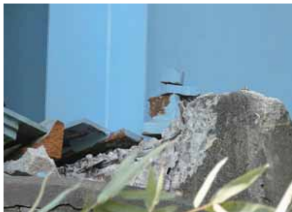
写真-4.4.5.10 アンカーボルトの変形状況
