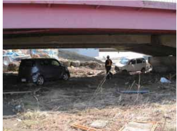
写真-4.3.12.9 津波により漂着した自動車(手前が旧橋、奥が新橋)
