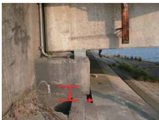
写真-4.4.32.6 橋台周辺護岸の状況 (潮来市側)
