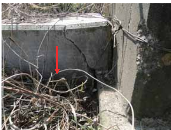
写真-4.4.4.6 左岸側水道管取付部のひび割れ
