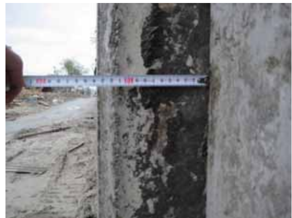
写真-4.2.7.8 左岸側カルバート背面盛土の橋軸直角方向の変状による段差(約 13.5cm)
