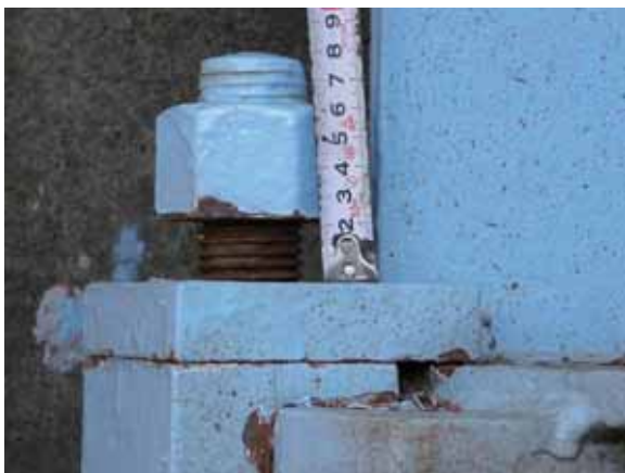
写真-4.4.5.14 A1 橋台上流側支承部アンカーボルトの伸び出し(約 2cm)
