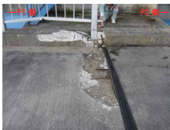
写真-4. 1. 20. 7 水門堰柱P2 支点上桁端部の損傷状況(上流側より撮影)
