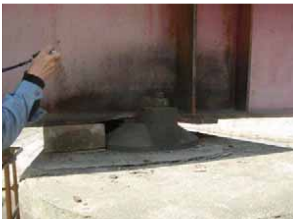
写真-4.2.18.8 P3 橋脚上の主桁の変形(資料提供：仙台市)
