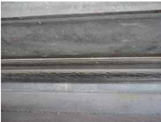
写真-4.4.6.12 A2 橋台支承ゴムのひび割れ
