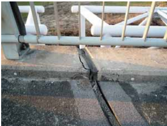
写真-4.4.24.2 ジョイント部の損傷状況
