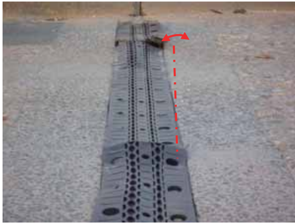
写真-4.2.11.13 桁折れ部での伸縮装置： 桁間のつまりに伴いゴムが浮いている
