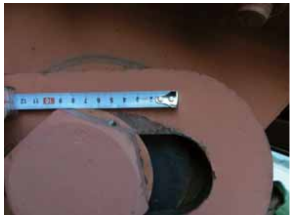
写真-4.3.17.7 ヒンジ部での移動痕 (A2 橋台 G1 桁)
