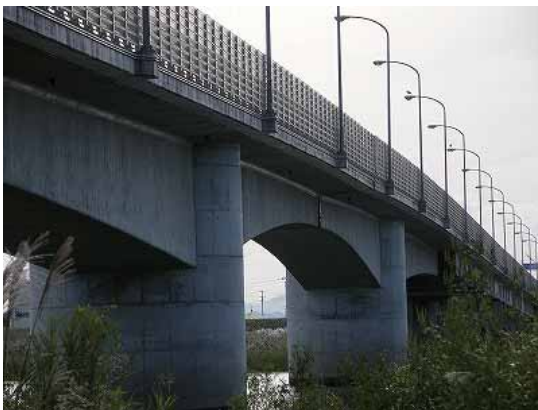
写真-4.2.14.8 ラーメン構造部における中央ヒンジの垂れ下がり
