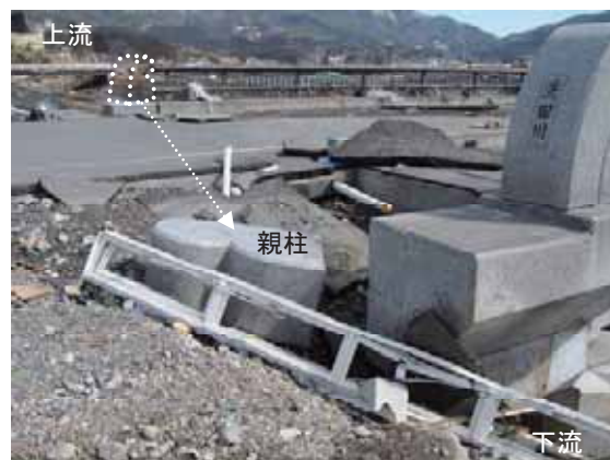
写真-4.1.6.3 橋台背面盛土の流出及び 親柱の移動(右岸下流側)
