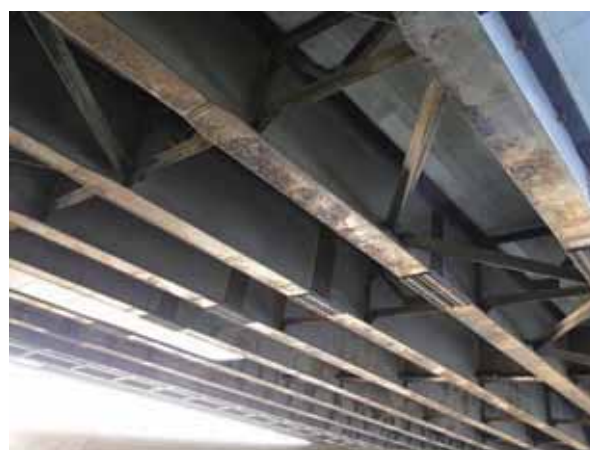
(b) 桁下部の腐蝕状況
