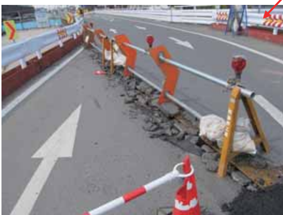
写真-4.4.26.14 接続部に生じた段差
