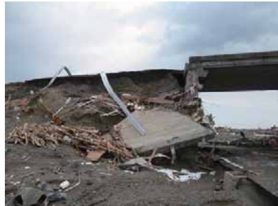
写真-4.1.3.3 橋台背面盛土の流出(竹駒駅側)
