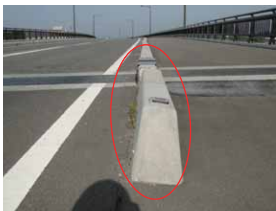
写真-4.2.9.4 橋台背面盛土の沈下による 地覆の傾き
