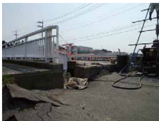
写真-4.4.23.3 橋台背面部の段差 (右岸側)
