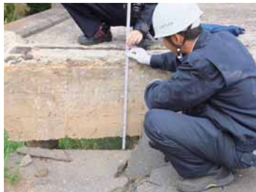
写真-4. 4. 14. 16 右岸側橋台背面の段差
