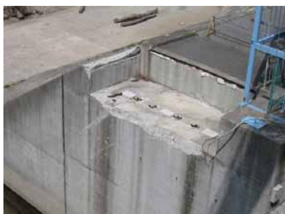
写真-4.1.19.10 水門堰柱P1 の橋座の 損傷
