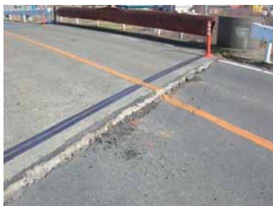
写真-4.4.16.3 橋梁路面と取付道路部の 段差
