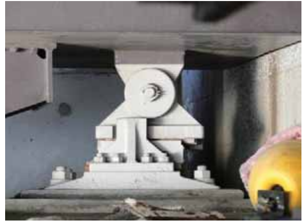
(k) 可動支承に生じた変状
