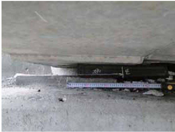
(a) ゴム支承の側方への移動(280mm) (G1 主桁)
