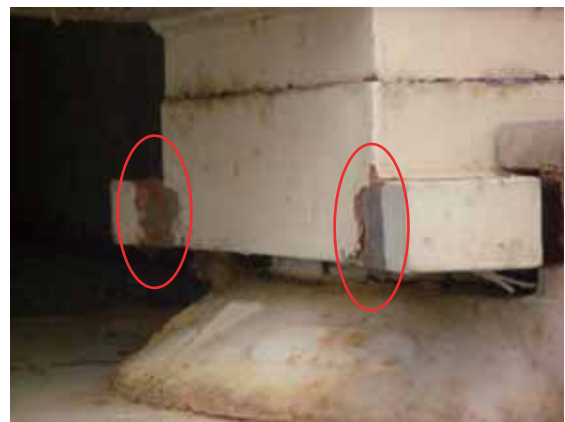
写真-4.2.13.17 A2 橋台上の下流側支承桁支間側ストッパーの変形
