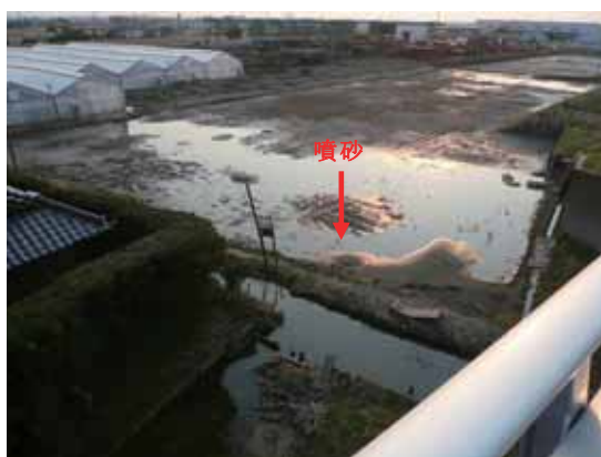
写真-4.5.11.4 稲敷市側橋台近傍の噴砂
