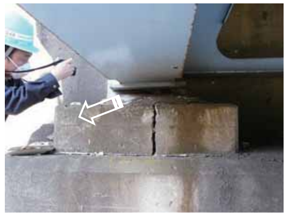
写真-4.4.5.13 A1 橋台上流側支承部前面の状況：破壊により大きくひび割れ
