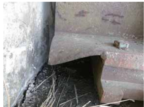
写真-4.2.10.21 A2 橋台上 G1 桁端部の 変形
