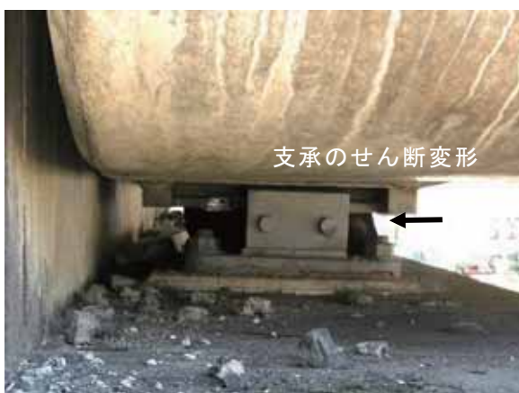
写真-4. 3. 8. 19 橋台部支承のせん断変形
