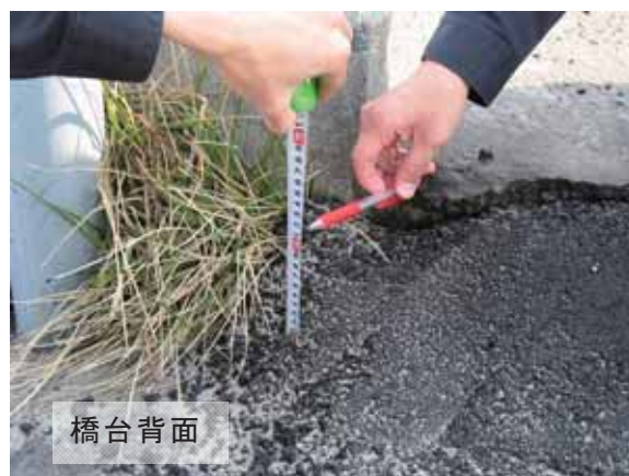
写真-4.3.3.3 北側橋台背面の沈下 (約 13cm)
