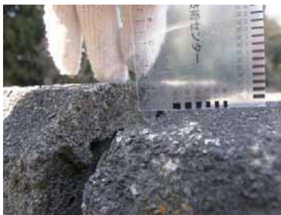
写真-4.4.4.13 橋脚上の高欄のズレ(上流側) (PC 桁側が約 12mm 低い)
