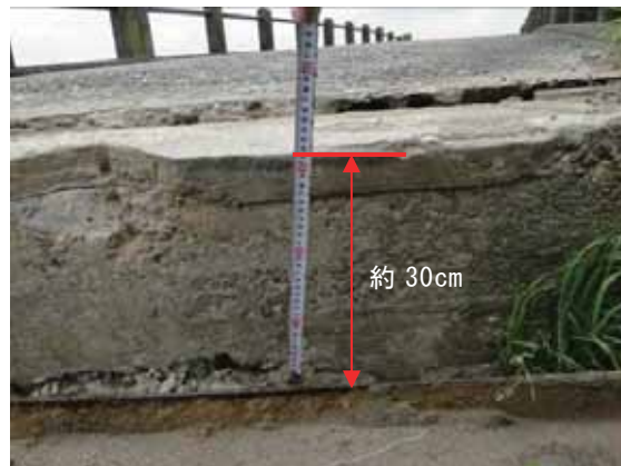
写真-4.4.14.3 左岸側橋台背面の段差
