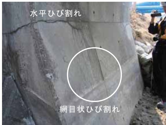
写真-4.3.3.8 側道橋南側橋台のひび割れ
