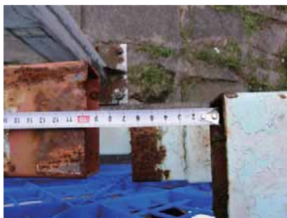
写真-4.3.16.7 高欄のずれ・開き
