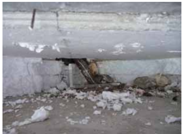
(d) アンカーバーの変形(90mm)
