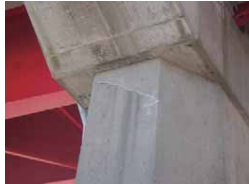
(d) ひび割れ部の拡大(側面側)
