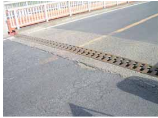
写真-4.5.1.20 A2 橋台部ジョイントの目開き
