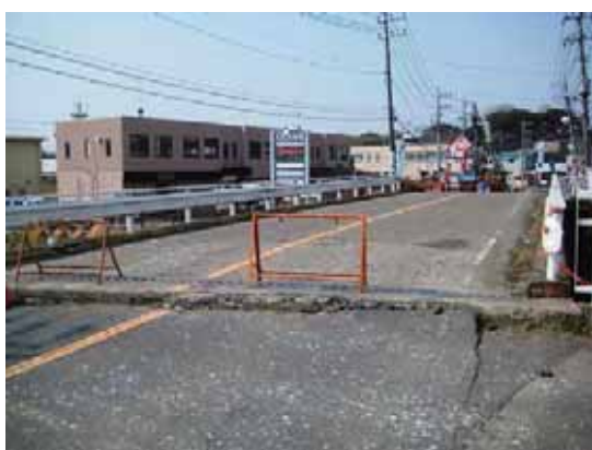
写真-4.4.23.2 橋台背面部の段差 (左岸側)
