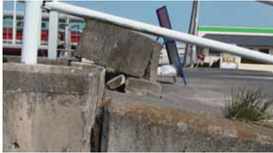
写真-4.3.3.6 側道橋南側橋台背面の沈下
