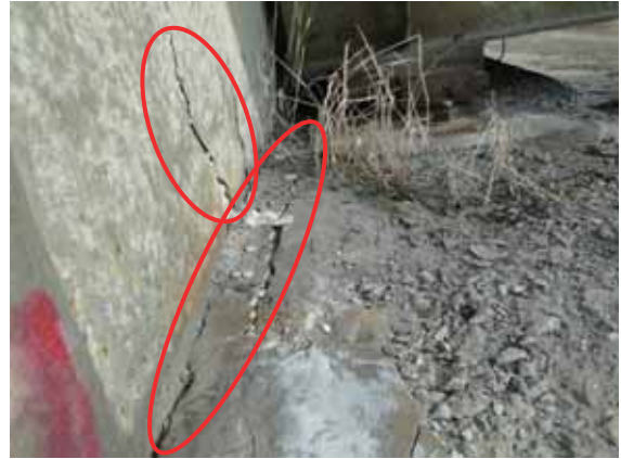
写真-4.2.10.19 A2 橋台パラペット前面及び橋座部のひび割れ等
