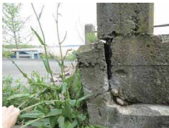
写真-4. 4. 14. 7 左岸側橋台の傾斜
