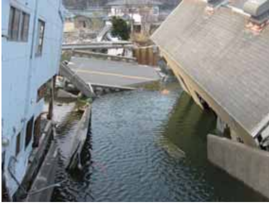
写真-4.3.5.3 崩落した橋と倒壊した周辺家屋(新大平橋より)
