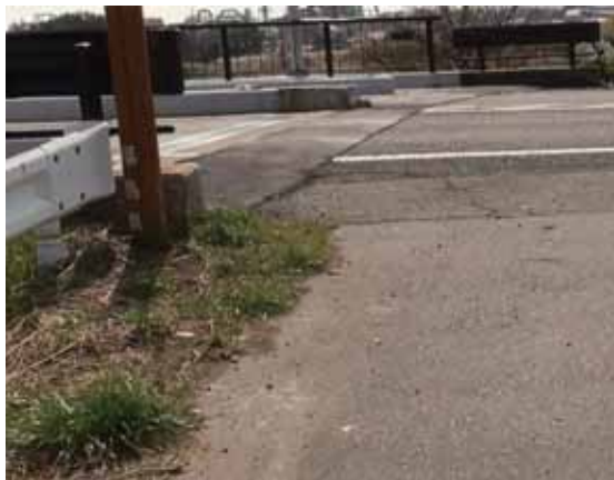
写真-4.3.6.2 橋台背面の段差
