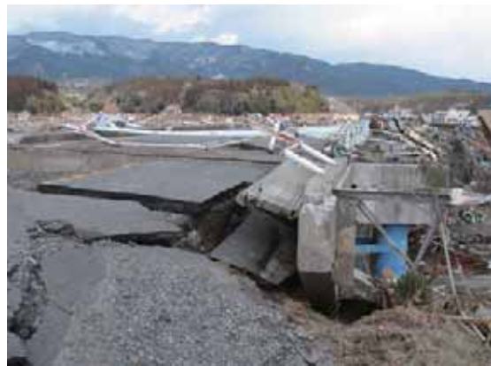
写真-4.1.3.4 橋台背面盛土の流出(陸前高田駅側)
