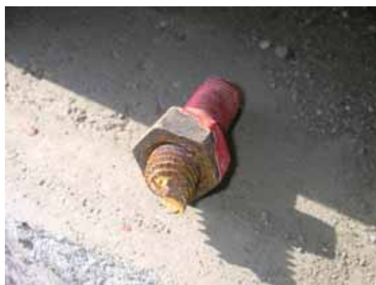
写真-4.5.1.17 破損したボルト
