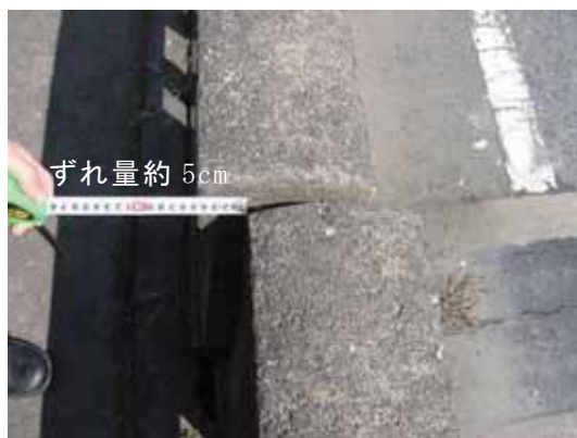
写真-4. 3. 12. 3 ヒンジ部の高欄の橋軸直角方向ずれ
