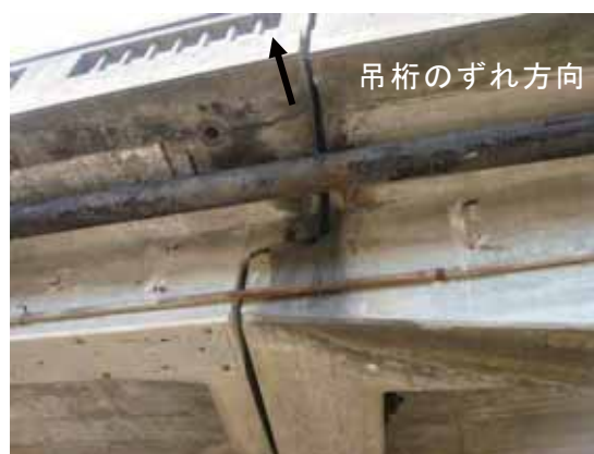
写真-4. 3. 12. 6 吊桁の橋軸直角方向ずれ（北側）
