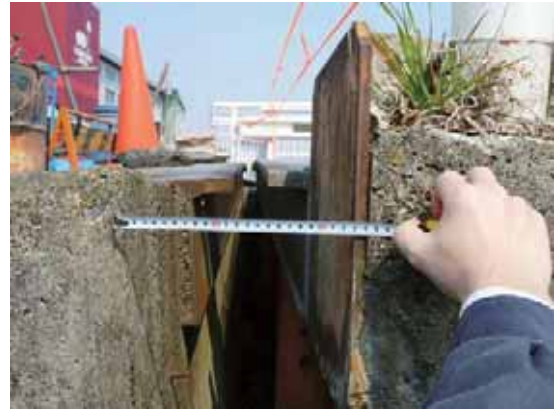
写真-4. 4. 23. 5 桁端部の開き(右岸側)
