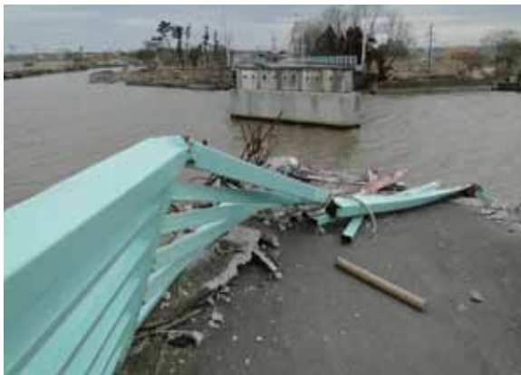
写真-4.2.6.9 上部構造が流出した 径間の状況(橋面)
