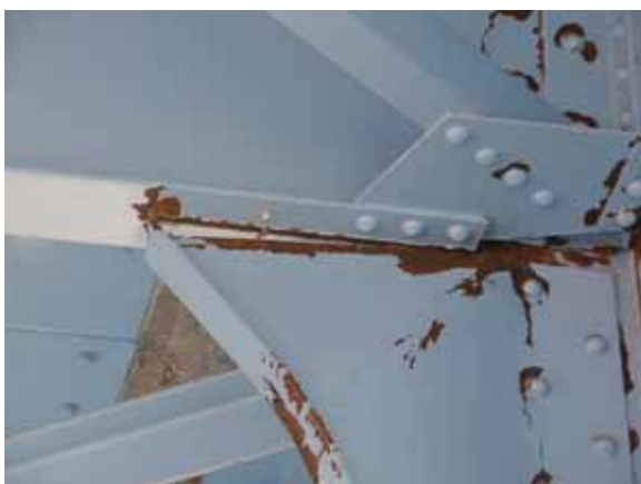
写真-4.4.5.20 ニーブレースの損傷(P4) : (横桁溶接部の亀裂)
