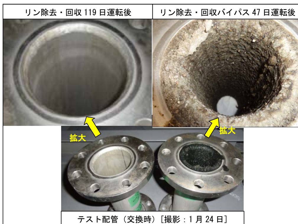
写真資 1-5 テスト配管、リン除去有無でのスケール生成状況写真
