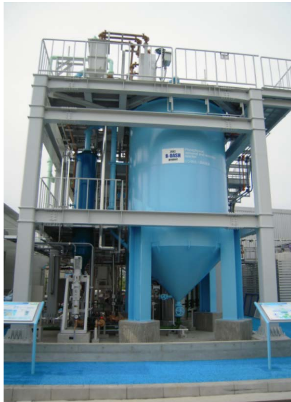
写真 2-5 リン除去・回収装置の外観
