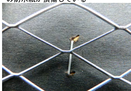
写真-5 ステーブルの周辺部の防水紙の損傷
