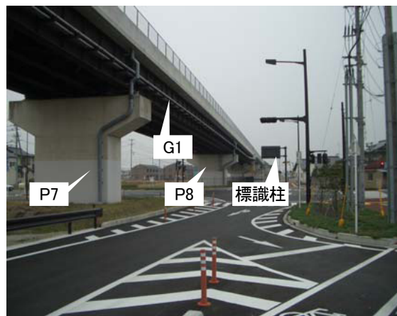
b) P7 橋脚北側と西側 (P8 側) の状況
