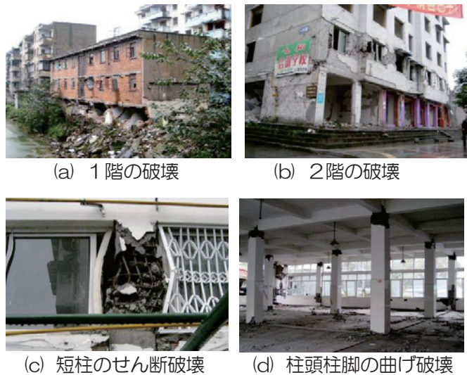
図Ⅱ②-2-3 被害状況
