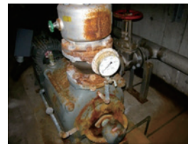
圧搾水ポンプの劣化状況
