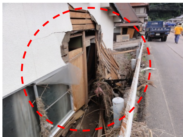
写真-3. 2. 13 馬溪橋付近の家屋外壁損壊
