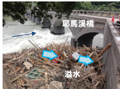
写真-3.2.2 耶馬溪橋での流木等の堆積状況
