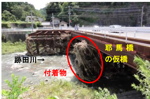
写真-3.2.7 耶馬橋仮橋における痕跡状況
