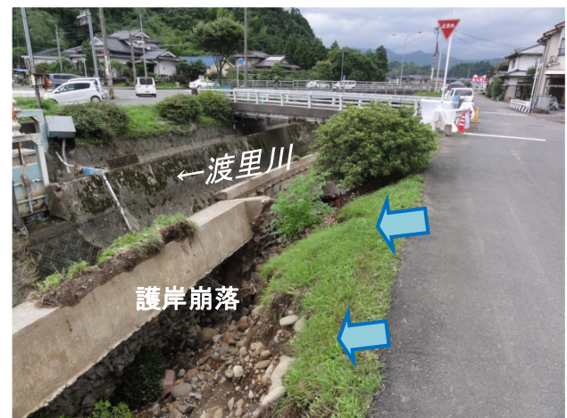
写真-3.1.10 渡里川左岸護岸の崩落状況
