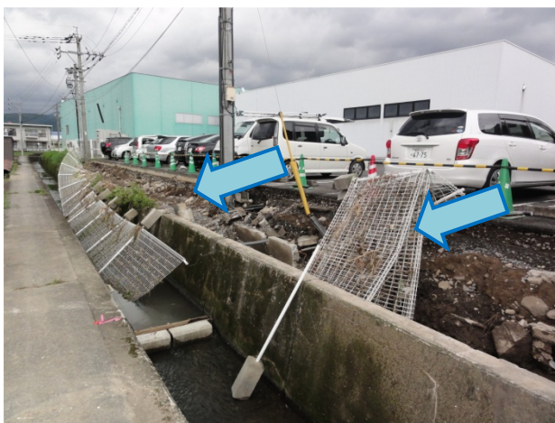
写真-3.1.9 レンタルビデオ店のフェンス倒壊
