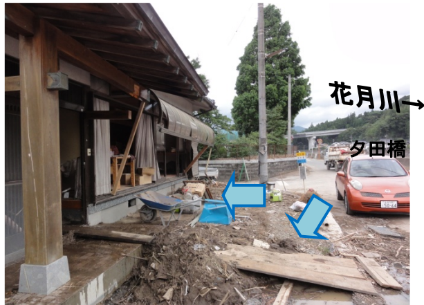
写真-3.1.7 夕田橋右岸付近の家屋の損壊状況
