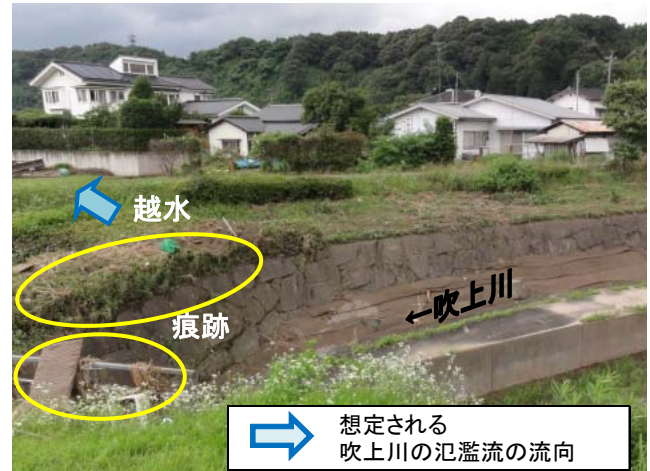
写真-3.1.6 吹上川における越水の痕跡 (渡里第二号樋管の川裏)
