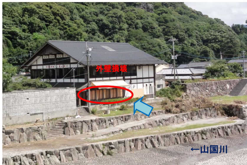
写真-3.2.9 商業施設1階外壁の損壊状況
