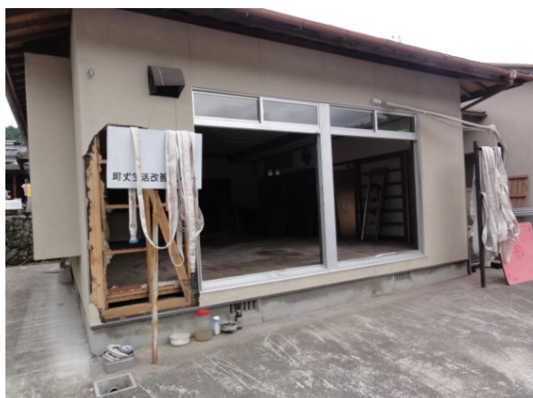
写真-3. 2. 12 生活改善センターの外壁損壊
