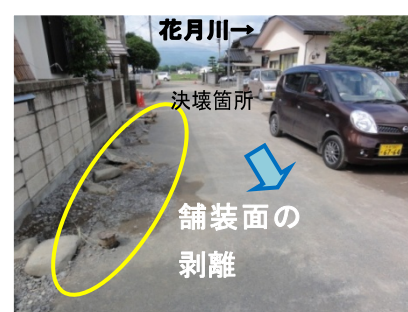
写真-3.1.18 道路舗装面の剥離
