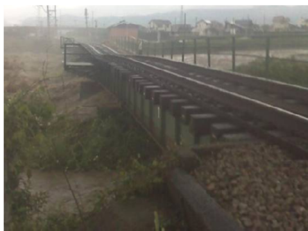
写真-4.1.2 久大本線隅の上橋梁 橋脚の沈下 （福岡県うきは市）
