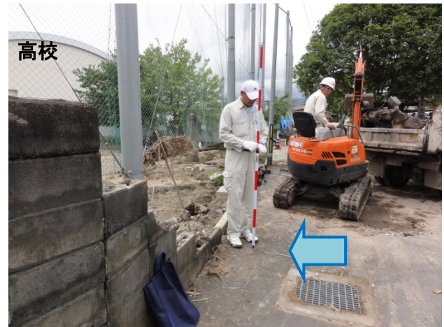
写真-3.1.8 高校のブロック塀の倒壊
