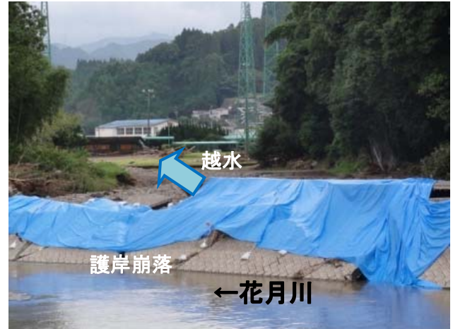
写真-3.1.4 右岸0.4k付近堤防護岸崩落状況
