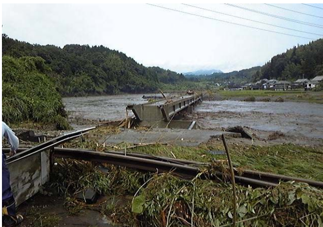
写真-4.1.1 豊肥本線第一大野川橋梁流失 （大分県豊後大野市）
