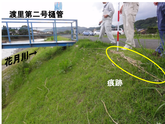
写真-3.1.5 渡里第二号樋管の痕跡
