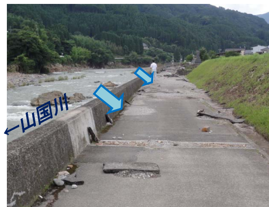
写真-3.2.11 左岸 21.5k 付近の道路における舗装の剥離
