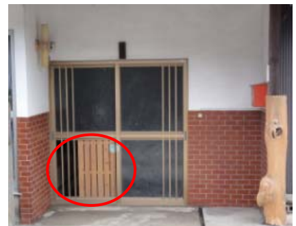
写真-3.2.3 家屋の玄関扉の破損状況
