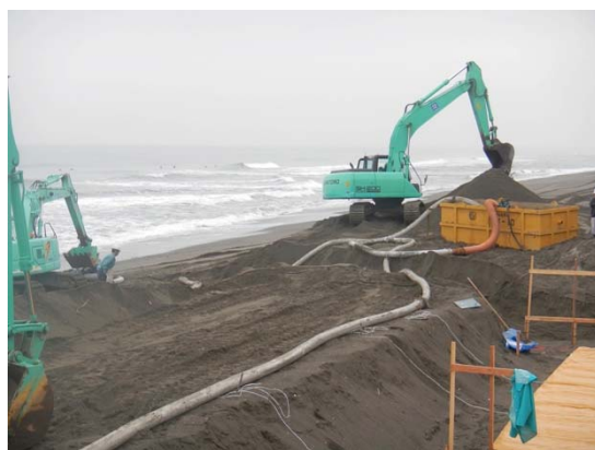
写真Ⅰ-4.5.6 送水系統と貯砂水槽
