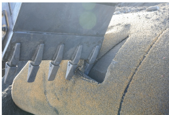
写真 I-4.4.1 掘削機バケットによる引裂き状況
