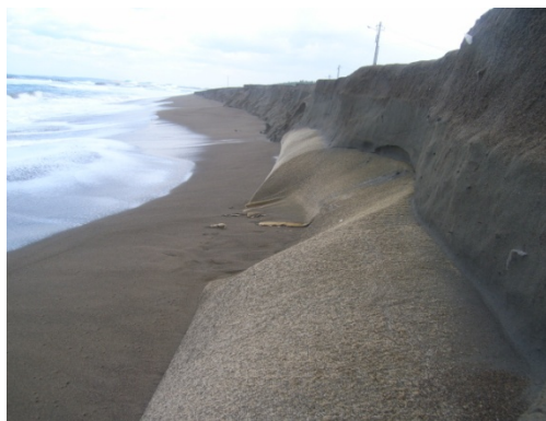
写真 I-4.4.3 中詰め材流出による変形状況
