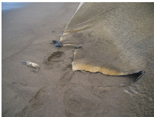
写真 I-4.4.2 中詰め材の流出状況
