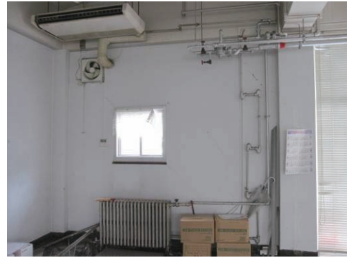
写真 B-34 耐力壁のせん断ひび割れ (1 階、損傷度 II)
