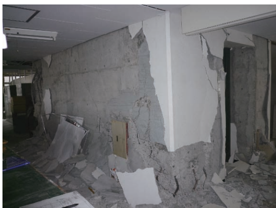
写真B-17 耐力壁のせん断破壊(2階)
