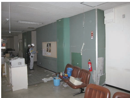
写真B-15 耐力壁側柱の主筋座屈(1階)
