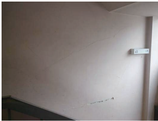
写真 B-23 耐力壁の被害（2 階梁間方向）
