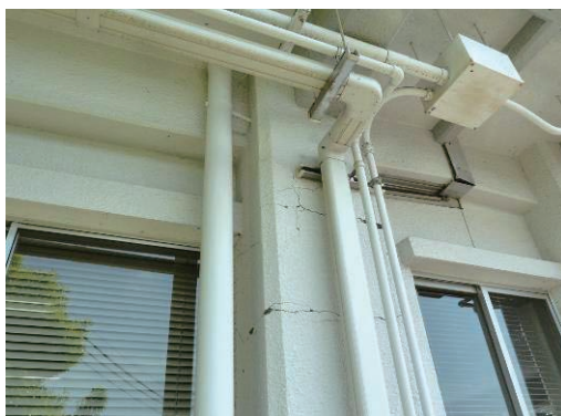
写真 B-51 梁間方向の柱頭曲げひび割れ （A-9柱）
