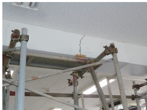
写真 B-54 梁間方向の梁中間部に生じた ひび割れ (⑨通り : ひび割れ幅 5mm)
