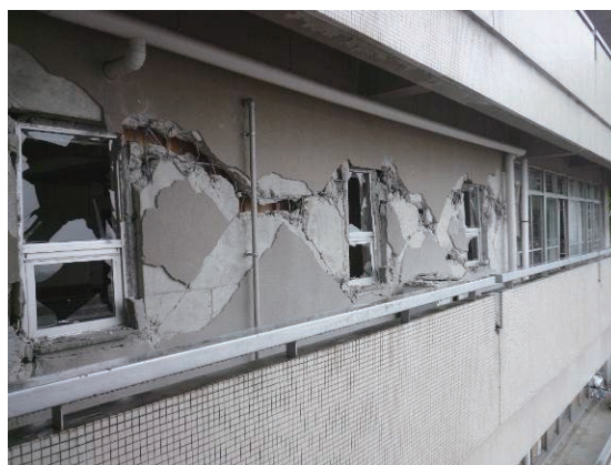
写真B-18 非構造壁のせん断破壊(2階)
