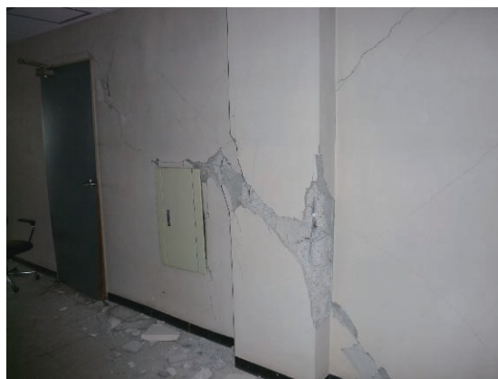
写真B-16 長柱のせん断破壊(2階)
