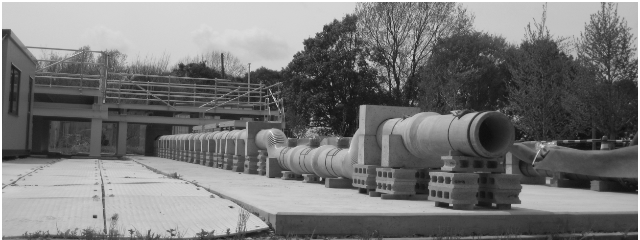
写真-3 模擬劣化管路外観
