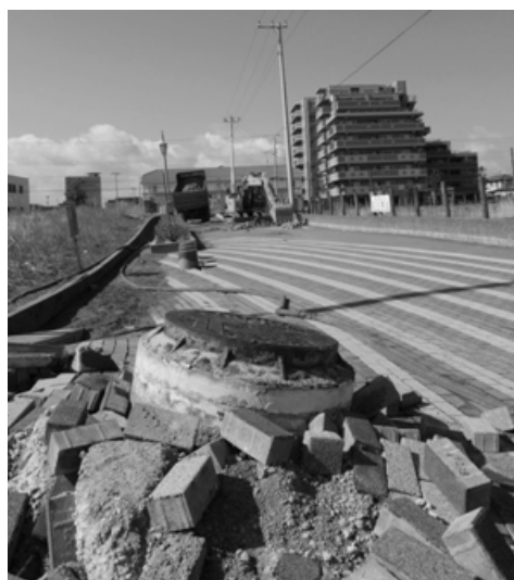
写真－１ マンホール浮上がり (茨城県神栖市)
