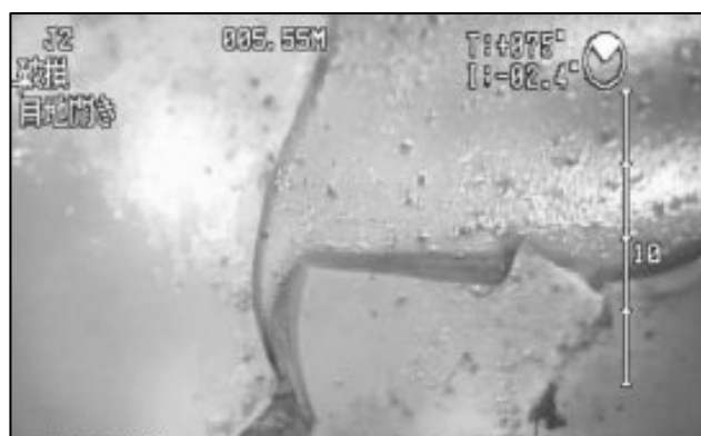
写真-2 破損した塩化ビニル管
