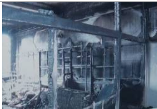
写真 7.3.16-2 火災室（備品庫）
