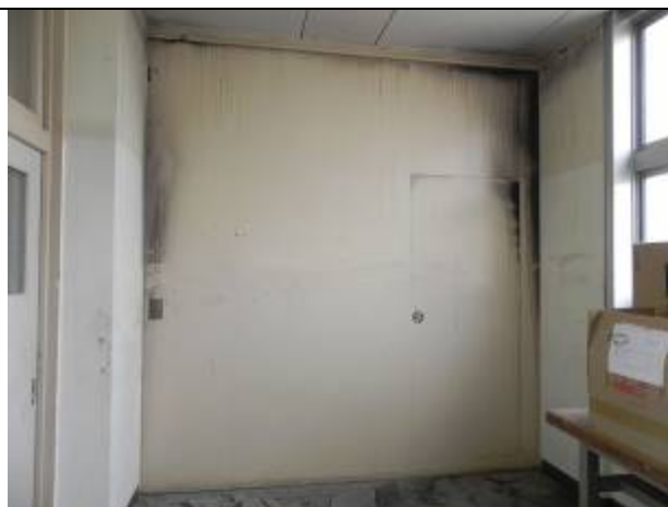
写真 7.3.16-6 防火戸（非火災側）
