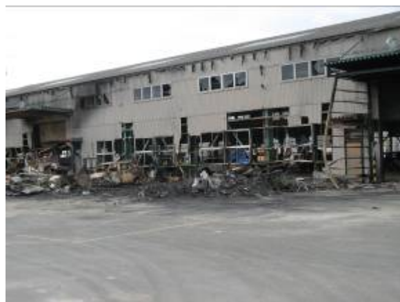
写真 7.3.1-4 仙台塩釜港北側の駐車場2の火災
