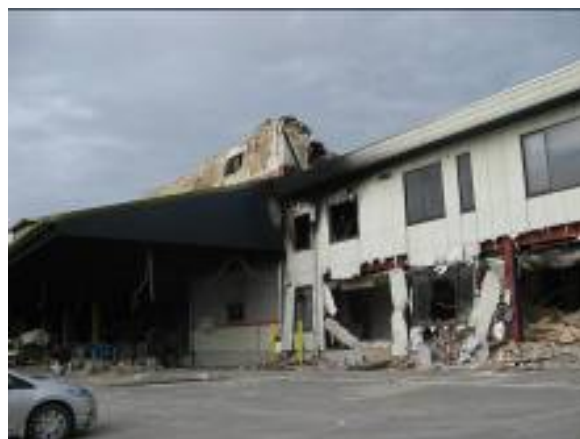
写真 7.3.1-3 仙台塩釜港北側の倉庫2の火災
