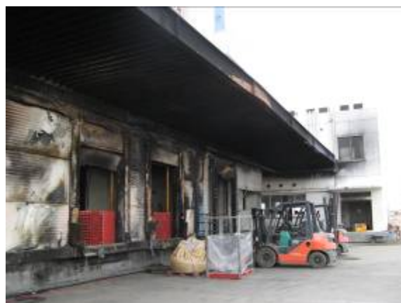
写真 7.3.1-2 仙台塩釜港北側の倉庫 1 の火災
