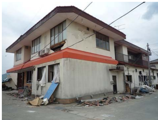
写真 6. 3. 13-22 残存した鉄骨造建築物 (14)
