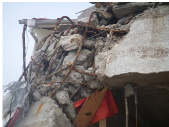
写真 6. 3. 11-40 1F 柱頭の損傷
