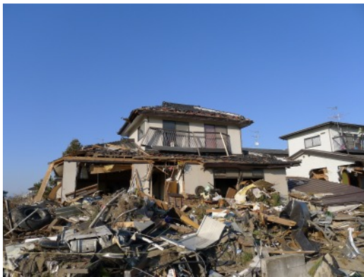
写真 6. 3. 10-29 1F の損傷の激しい木造 (⑭)
