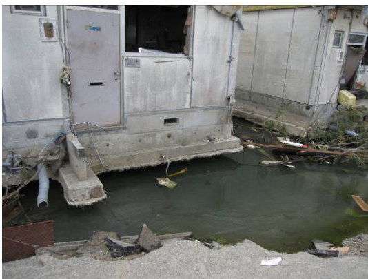
写真 6. 3. 11-27 周辺地盤の洗掘
