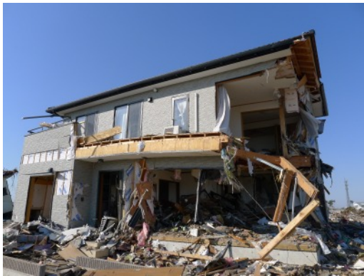
写真 6. 3. 10-21 残存した木造住宅 (⑨)
