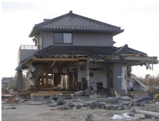
写真 6. 3. 12-7 1 階の大半の躯体を失った住宅（寺島地区）
