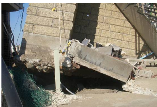
写真 6. 3. 10-11 写真 6. 3. 10-10 の地盤の洗掘状況
