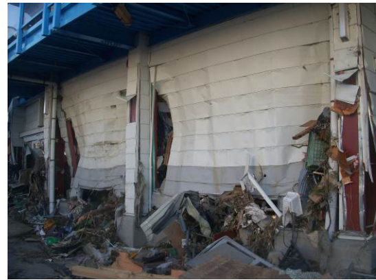
写真 6. 3. 10-18 外壁材の面外変形
