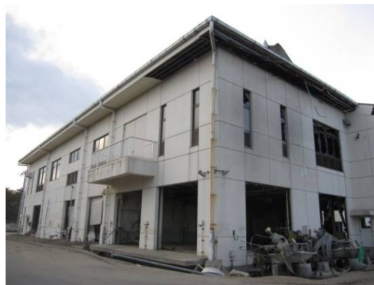
写真 6. 3. 12-13 屋根及び窓ガラスの損傷
