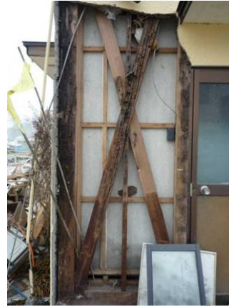
写真 6. 3. 13-14 写真 6. 3. 13-13 の筋かいの生物劣化
