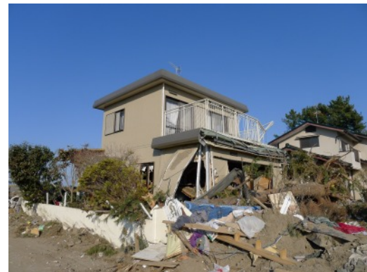
写真 6. 3. 10-26 残存する軽量鉄骨造住宅 (⑫)
