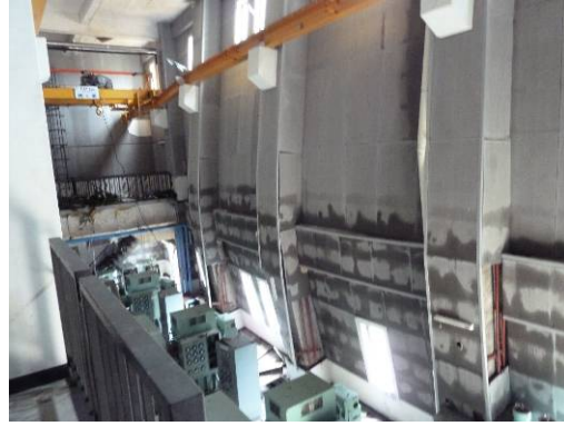
写真 6. 3. 10-45 第3 ポンプ室 内部
