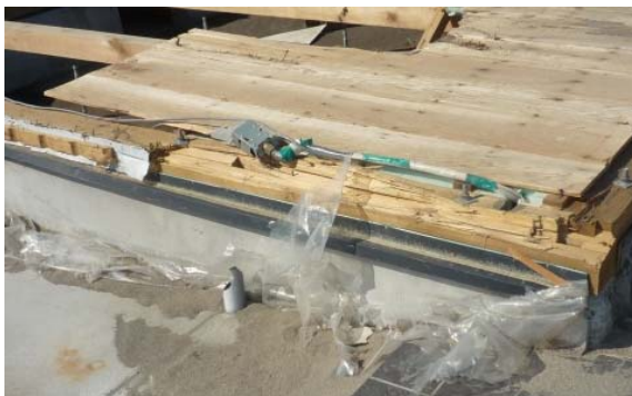
写真 6. 3. 10-5 土台が割裂した例
