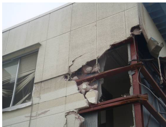
写真 6. 3. 11-36 外装材の流失
