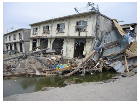
写真 6. 3. 11-28 周辺地盤の洗掘による建物傾斜 (17)
