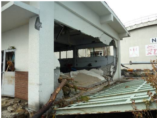
写真 6. 3. 10-46 センター内での非構造壁脱落
