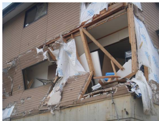
写真 6. 3. 11-42 壁及び柱の破損
