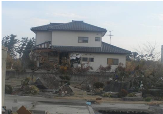
写真 6. 3. 12-3 隅角部や壁面側躯体を失った住宅（押分）
