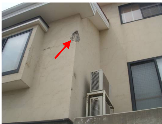
写真 6. 3. 13-34 2 階外壁の衝突痕
