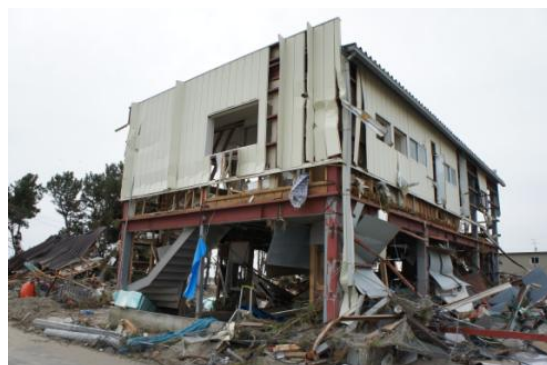
写真 6. 3. 11-21 外装材は損傷しているが構造体は健全な鉄骨造(1)
