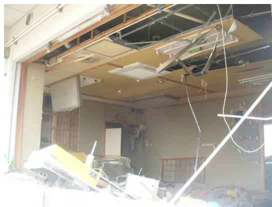
写真 6.3.11-34 1F 天井仕上げ材の破損
