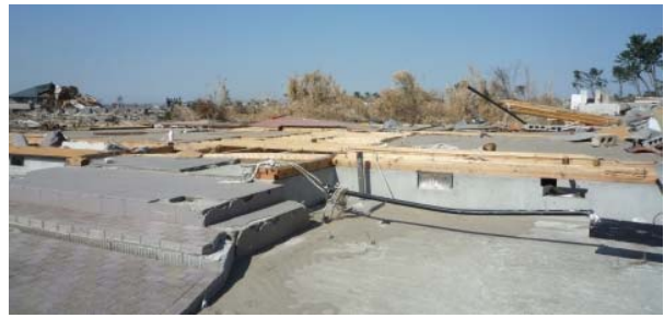
写真 6. 3. 10-2 基礎と土台が残る被害例
