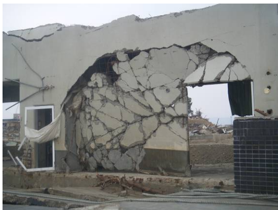
写真 6.3.11-43 外壁の面外へのはらみ出し
