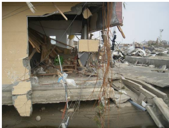
写真 6.3.11-49 周辺地盤の洗掘
