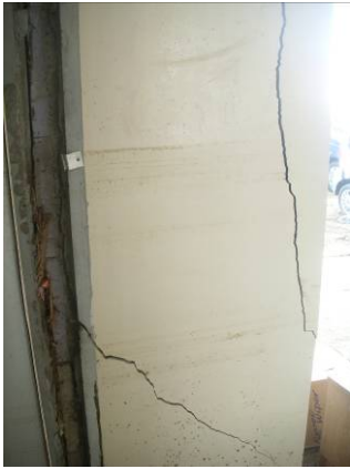
写真 6. 3. 11-50 壁のひび割れ
