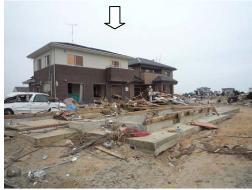
写真 6. 3. 11-15 写真 6. 3. 11-11 の津波作用方向から見て反対方向(西)に位置する残存建物 (⑪)
