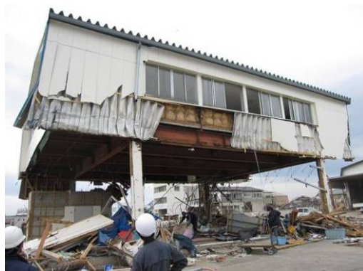
写真 6. 3. 13-36 2 階外壁の破損状況
