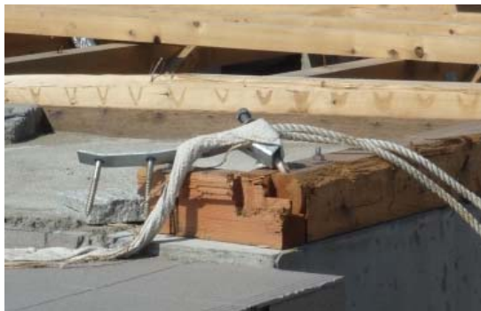
写真 6. 3. 10-3 写真 6. 3. 10-2 に残る ホールダウン金物
