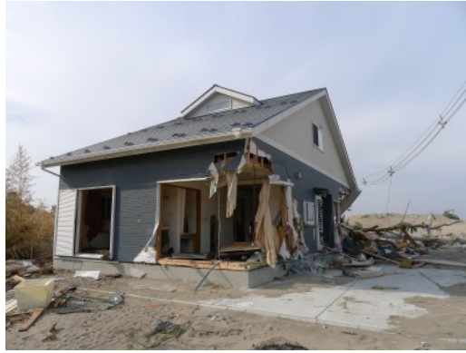
写真 6. 3. 11-59 残存した木造住宅 (⑤)
