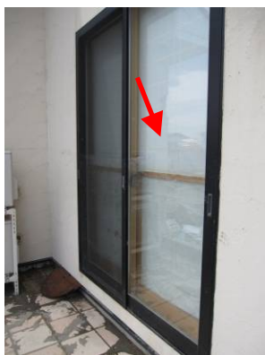
写真 6. 3. 13-33 2 階窓ガラスの浸水痕
