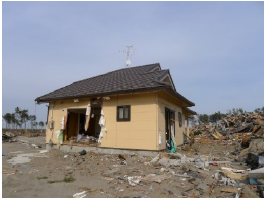
写真 6. 3. 11-58 残存した木造と鉄骨造住宅
