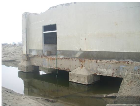
写真 6.3.11-44 周辺地盤の洗掘
