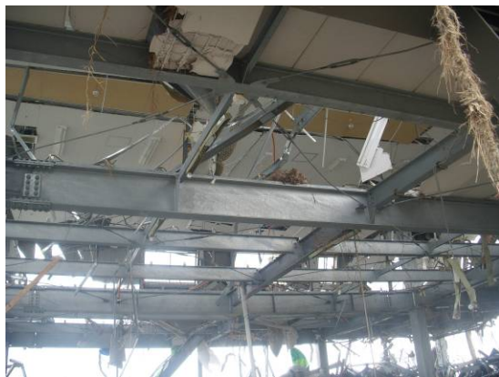
写真 6.3.11-47 内外装の破損
