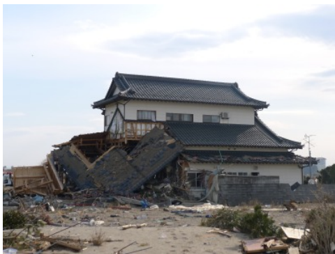
写真 6. 3. 11-62 残存した木造住宅 (⑧)
