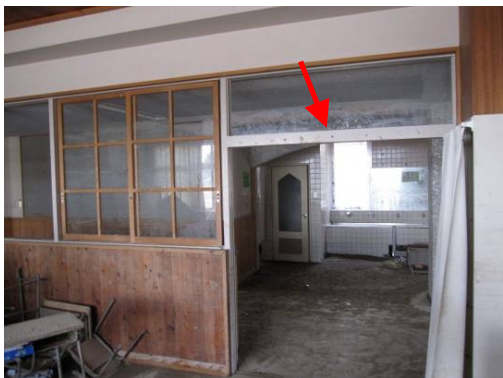
写真 6. 3. 14-11 室内の浸水痕
