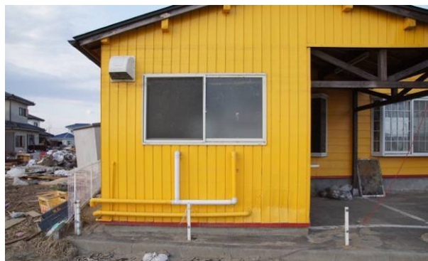
写真6.3.13-2 建物外装材に残る浸水痕
