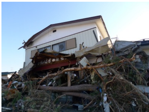
写真 6. 3. 10-34 全壊状態の H 形鋼梁を有する 木造住宅 (⑯)
