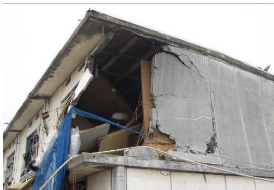
写真 6.3.11-29 漂流物の衝突による 2 階部分の損傷
