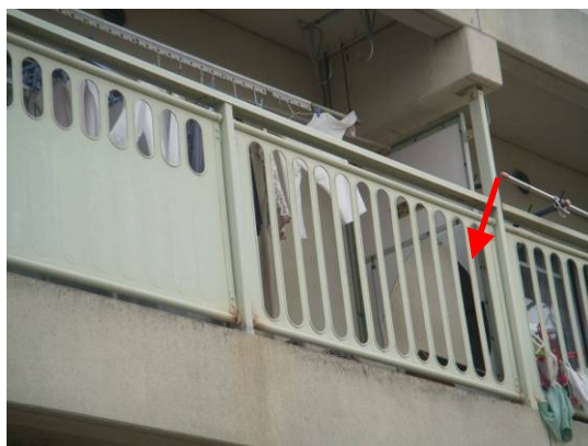
写真 6.3.11-32 住戸間の仕切りの破損状況 (2 階)
