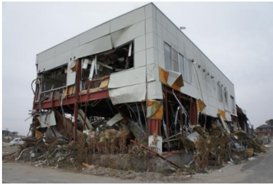
写真 6. 3. 11-22 外装材は損傷しているが 構造体は健全な鉄骨造(2) (15)
