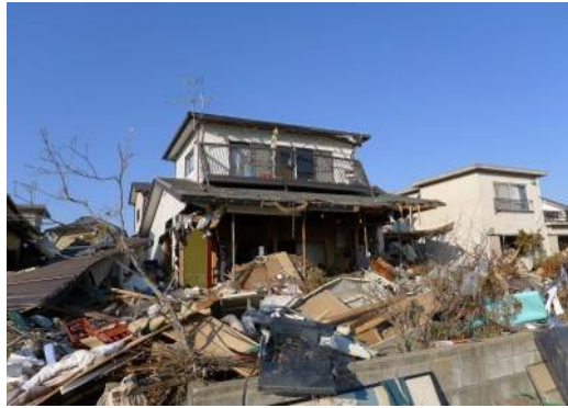
写真 6. 3. 10-28 1F の損傷の激しい木造
