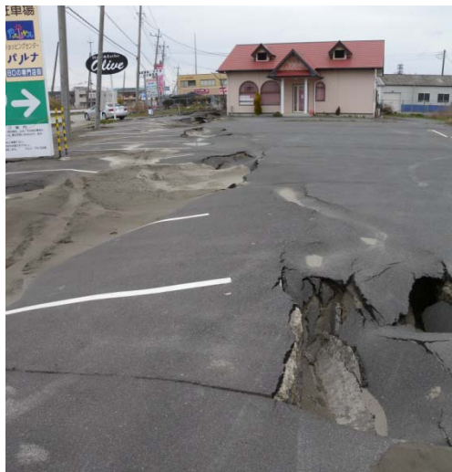
写真 5.5.2.1-13 駐車場路面の変状 (左側が県道 11 号)
