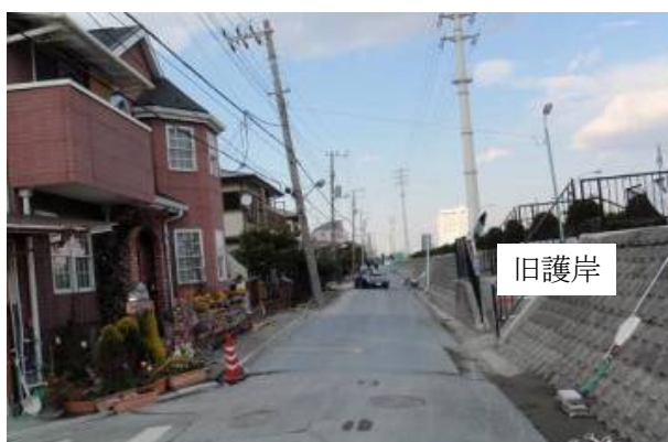
写真 5. 5. 2. 2-11 右側に傾斜した道路
