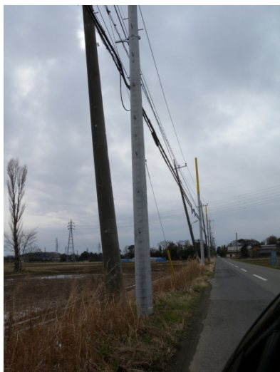
写真 5.5.2.1-1 電柱の傾斜（復旧中）
