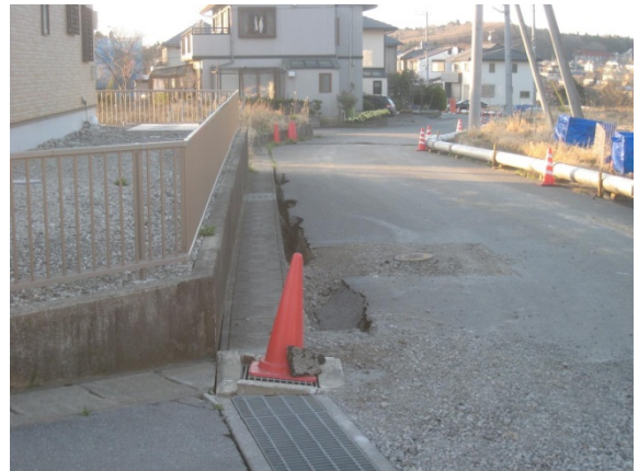
写真 5. 5. 2. 3-56 地割れの痕跡
