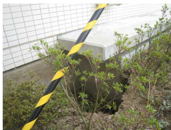
写真 5. 5. 2. 3-22 建物に対する地盤の相対沈下（仙塩街道の北側）
