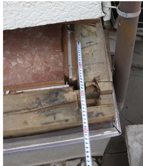
写真 5. 5. 2. 1-18 約 25cm のずれを生じた土台 (手前側が県道 11 号)
