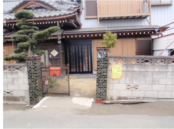
写真 5.5.2.1-6 ブロック塀の段差
