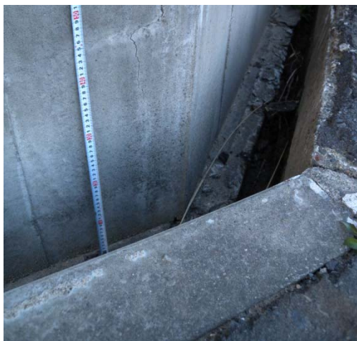
写真 5. 5. 2. 1-39 外周部塀と前面道路との段差
