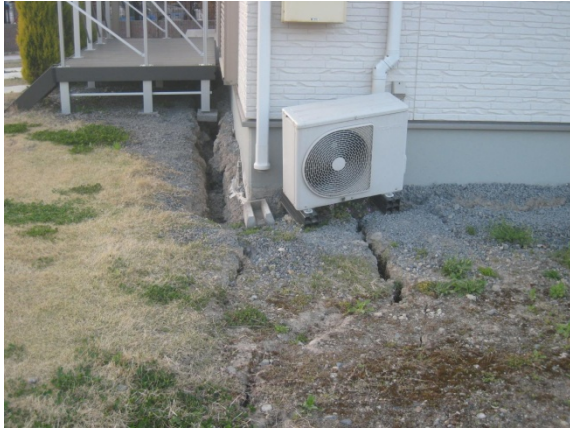
写真 5. 5. 2. 3-53 写真 5. 5. 2. 3-52 の住宅の地盤の変状
