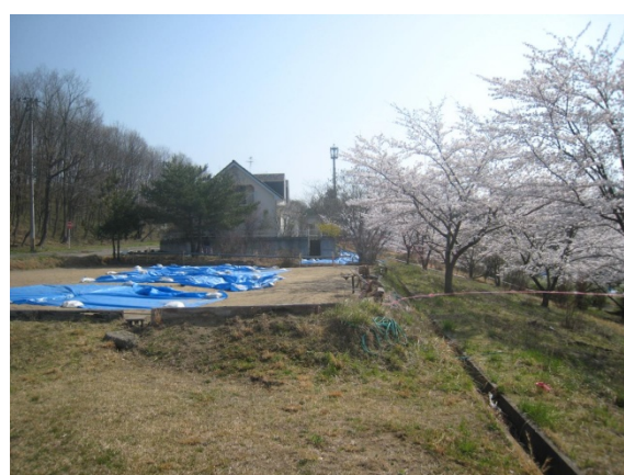
写真 5.5.2.3-30 緑ヶ丘 1 丁目の斜面地①および頂部に生じた地割れ（一部ブルーシート掛け）
