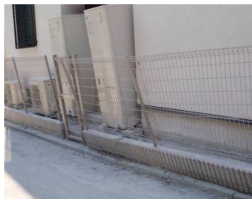
写真 5.5.2.2-2 変形したフェンス
