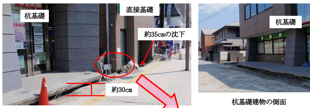
写真 5. 5. 2. 2-14 支持機構による被害状況の違い
