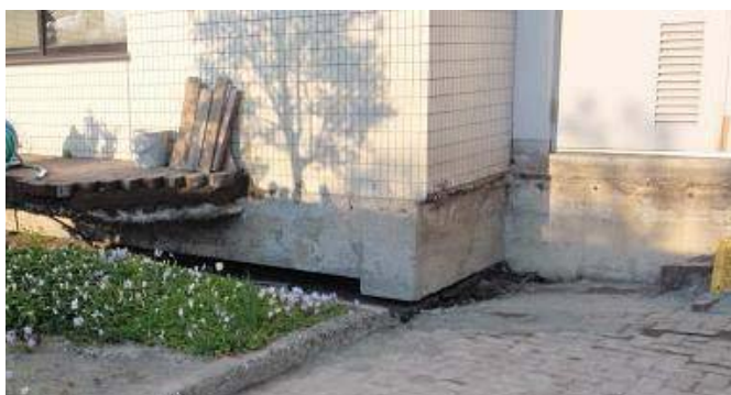
写真 5.5.2.2-16 周辺地盤が沈下した建物
