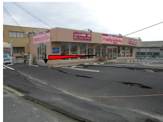
写真 5.5.2.1-14 片側が不同沈下した建築物（同）
