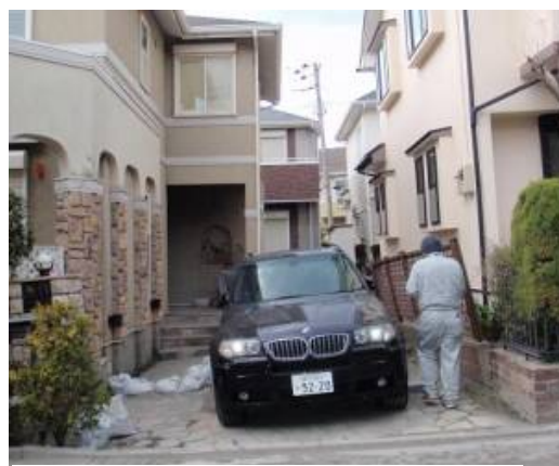
写真 5. 5. 2. 2-10 傾斜した住宅
