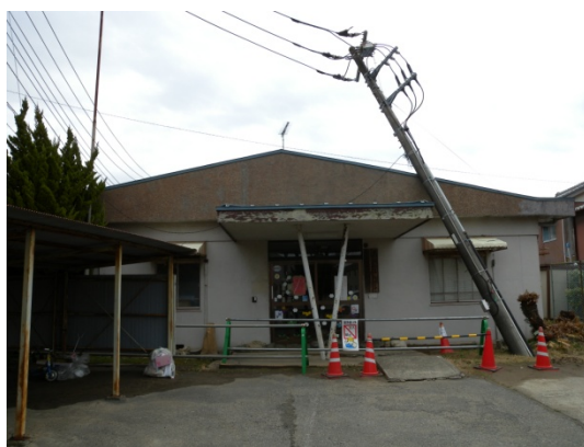
写真 5.5.2.1-3 保健センター入口付近の状況
