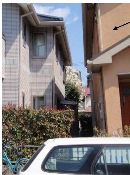
写真 5. 5. 2. 2-5 沈下・傾斜した住宅
