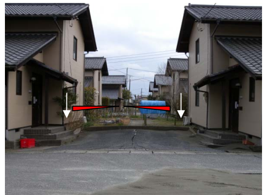
写真 5.5.2.1-30 空地を挟んだ2棟の沈下
