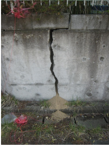
写真 5.5.2.3-31 写真 5.5.2.3-30 の住宅の盛土擁壁の破壊
