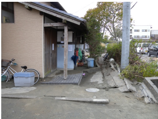
写真 5.5.2.1-29 住宅玄関付近の沈下
