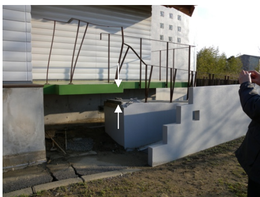
写真 5.5.2.1-35 スロープ部の段差
