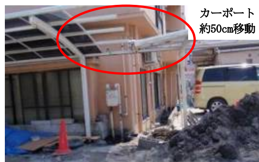
写真 5.5.2.2-4 移動したカーポート
