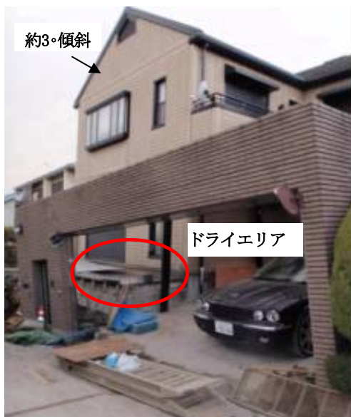
写真 5.5.2.2-1 傾斜した住宅
