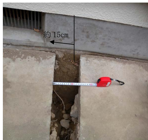
写真5.5.2.1-8 離間(基礎は外観上ひび割れ等なし)
