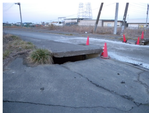
写真 5. 5. 2. 1-42 周辺歩道部分の被害(段差約 40cm)
