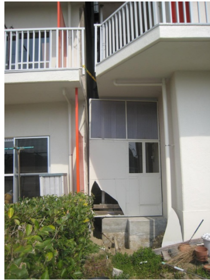
写真 5. 5. 2. 3-26 写真 5. 5. 2. 3-25 の 1 階部分における 2 棟の隙間および地盤の相対沈下
