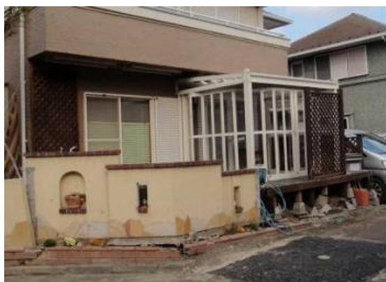
写真 5. 5. 2. 2-9 バルコニー基礎部の被害
