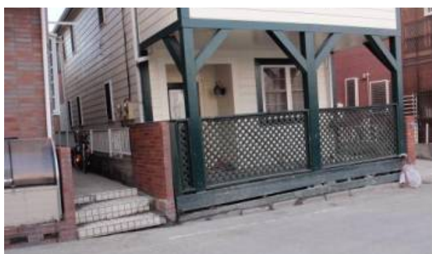
写真 5. 5. 2. 2-13 左側が沈下・傾斜した住宅
