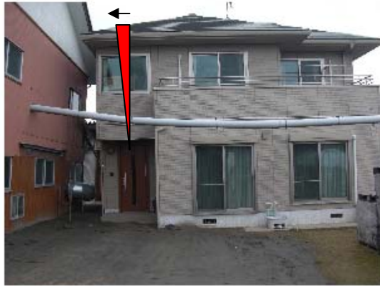
写真 5.5.2.1-25 †) 傾斜した住宅 (写真 5.5.2.1-24 の左端)
