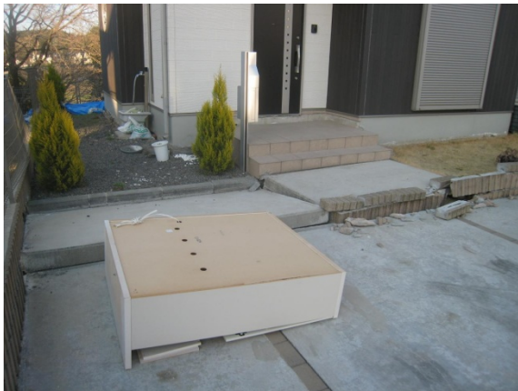
写真 5. 5. 2. 3-55 宅地地盤の変状による損傷
