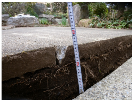
写真5.5.2.1-9 入口付近の沈下
