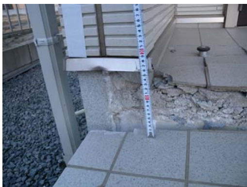
写真 5. 5. 2. 1-41 建築物入口付近の段差
