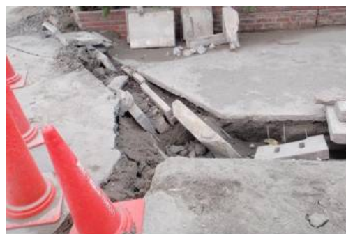
写真 5. 5. 2. 2-12 破断した道路面
