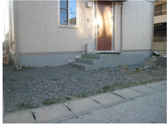
写真 5. 5. 2. 3-54 住宅に対する地盤の相対沈下
