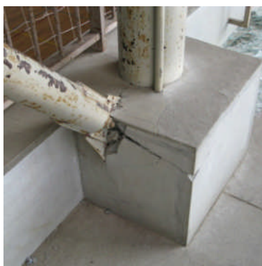
写真 5. 3-32 ひび割れ (HKT-2)
