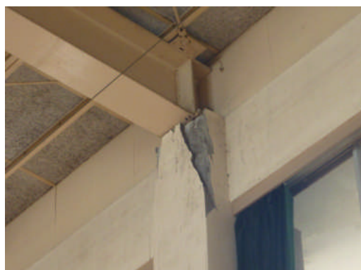
写真 5.3-21 仕上げモルタルの剥落 (MIT-25)
