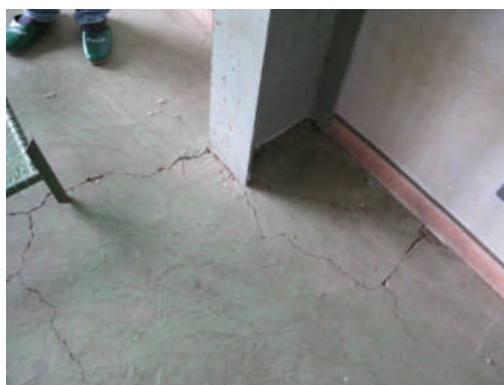
写真 5. 3-31 柱脚部のひび割れ (HKT-1)
