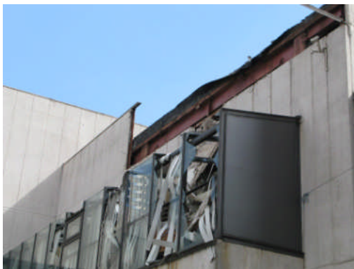
写真 5.3-9 外装材の脱落、ガラス破損（須賀川市）
