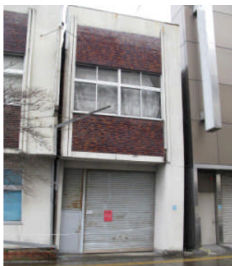
写真 5.3-4 1階の残留変形（仙台市若林区）
