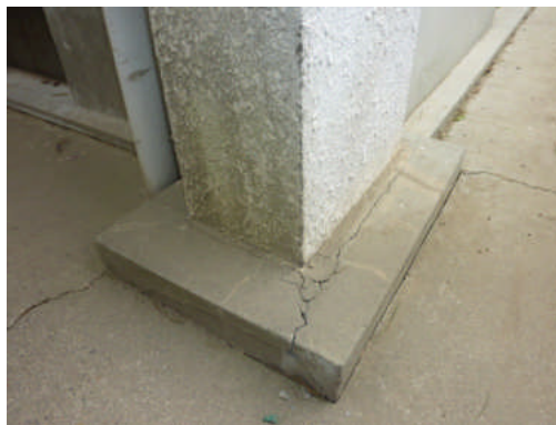
写真 5. 3-33 ひび割れ (MIT-13)
