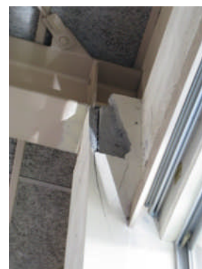
写真 5.3-22 仕上げモルタルの剥落 (MIT-27)
