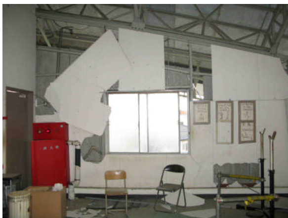
写真 5.3-48 内装仕上げの落下 (HKT-2)
