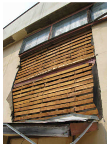
写真 5.3-45 外装仕上りの落下（SSM-2）
