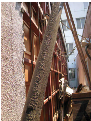
写真 5.3-46 外装仕上げの落下 (MIT-5)
