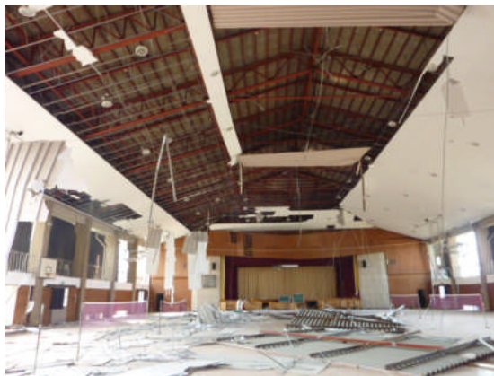
写真 5.3-43 天井材脱落（MIT-7）
