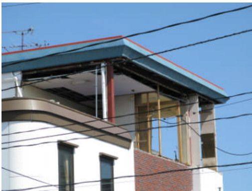
写真 5.3-7 4 階建て最上階の外装材等の被害（須賀川市）
