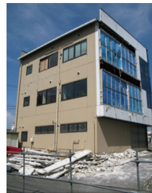
写真 5.3-10 ALC パネルの脱落（白河市）
