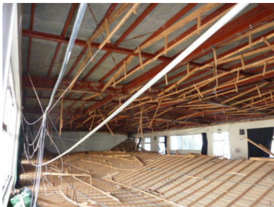
写真 5.3-42 天井材脱落（MIT-5）
