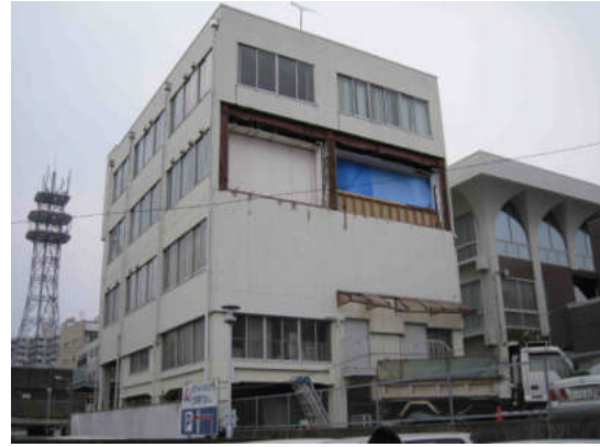
写真 5.3-12 事務所の外装材の脱落（水戸市）
