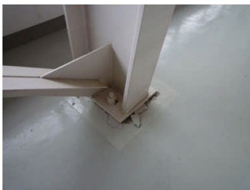
写真 5. 3-30 モルタルの損傷 (栗原市)
