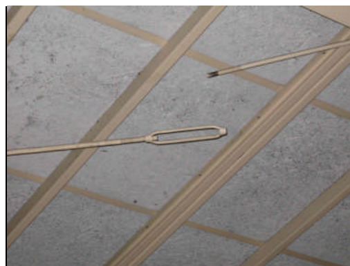
写真 5.3-28 ターンバックルの破断 (MIT-25)
