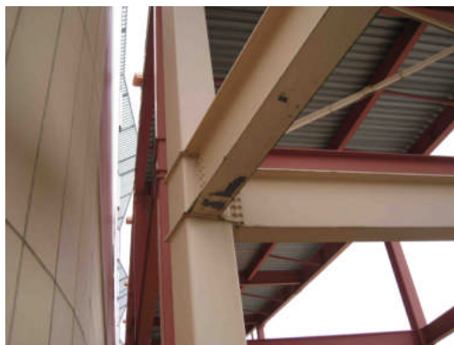
(b) 梁端部塗装の剥がれ
