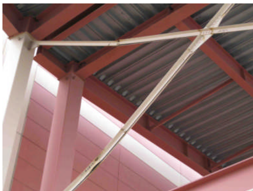
(a) ブレース（山形鋼ダブル）の座屈
