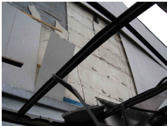
写真 5.3-47 外装仕上げの落下 (MIT-12)
