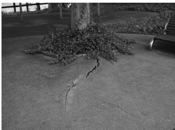
写真-6 舗装にできたひび割れ
