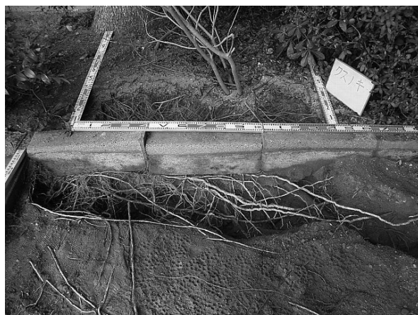
写真-4 縁石下の隙間に伸びた根
