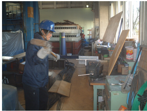
写真-2.2.10 切断状況⑤（低温脆性破壊）
