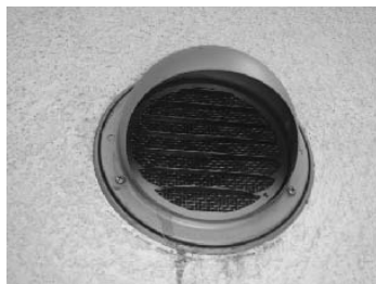
図2 手の届かなかった外部フード
