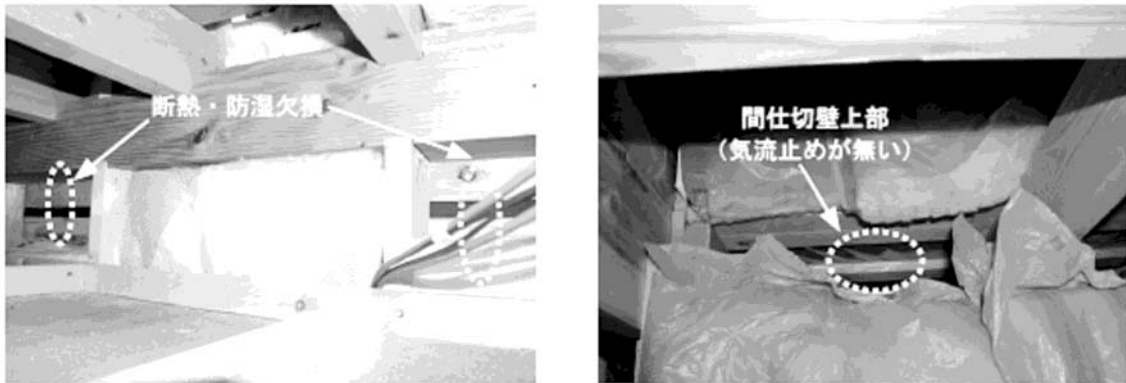
図3 壁の実況見分の事例
