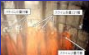
スライムにより詰まった集水管
