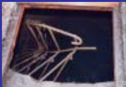
腐食したタラップ
