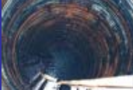
ライナープレートが腐食した井筒
