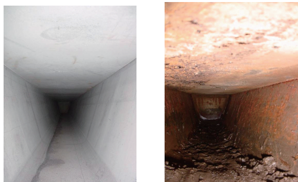
写真解 5.6-1 健全なトラフリブ内部（左）とデッキプレート貫通型き裂が発生したトラフリブ内部（右）
