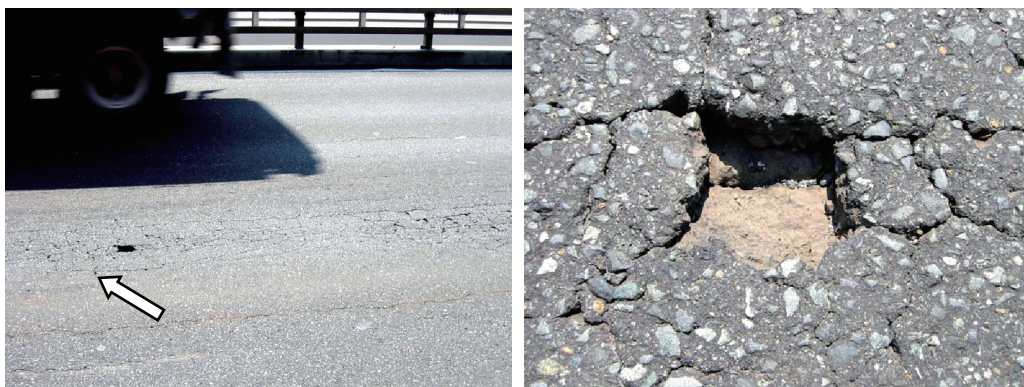
写真解 3. 3-5 舗装の剥離によるポットホール（右は矢印部分の拡大）
