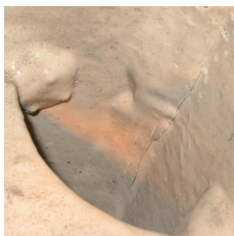
写真解 5. 4-1 塗膜割れの事例（非破壊検査の結果、疲労損傷なし）
