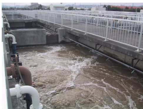
写真-26 浄化センター曝気槽
