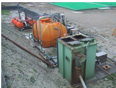
写真-29 流入下水混合槽
