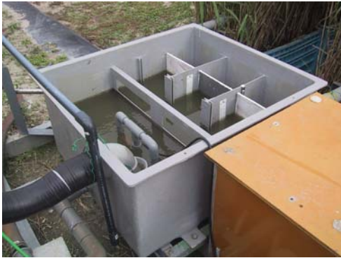
写真-33 植生帯流入タンク
