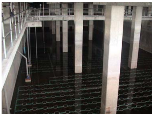
写真-23 反応槽の底の状態
