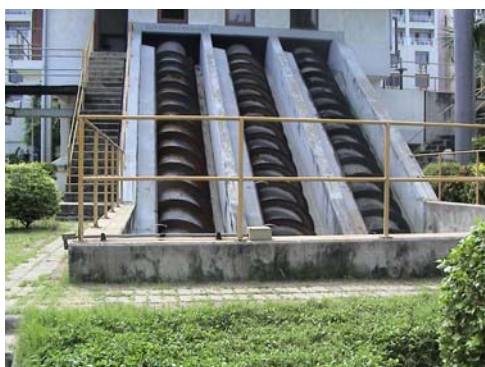
写真-17 スクリューポンプ
