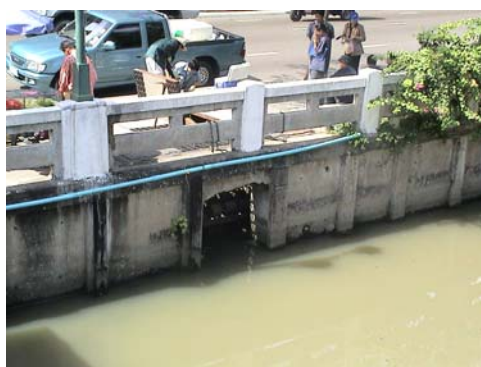
写真-8 洪水時の下水排出ゲート
