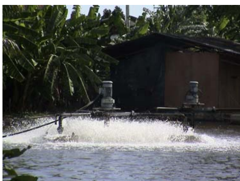
写真-15 水面攪拌式の曝気装置
