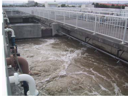
写真-26 浄化センター曝気槽
