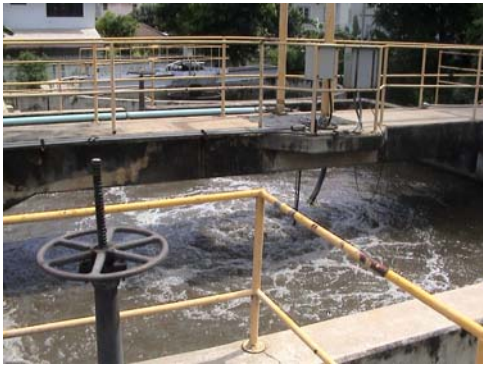
写真-19 ホイクアン処理場の曝気槽
