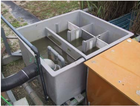
写真-33 植生帯流入タンク
