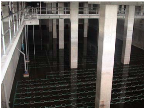
写真-23 反応槽の底の状態
