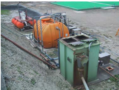
写真-29 流入下水混合槽
