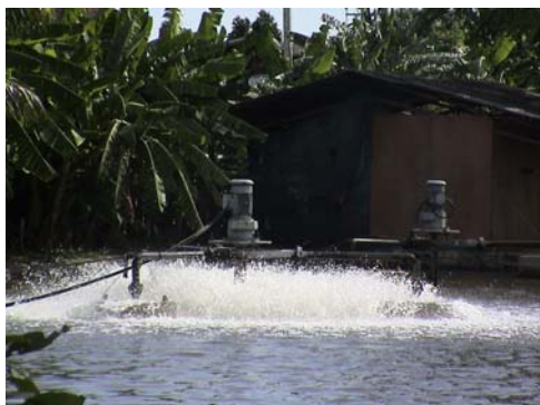
写真-15 水面攪拌式の曝気装置
