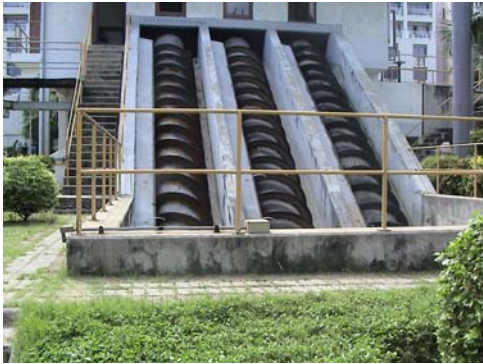
写真-17 スクリューポンプ
