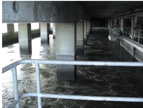
写真-22 曝気状態の反応槽
