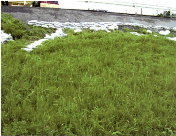
写真 2-6 一般国道 45 号のり面はらみ出し
