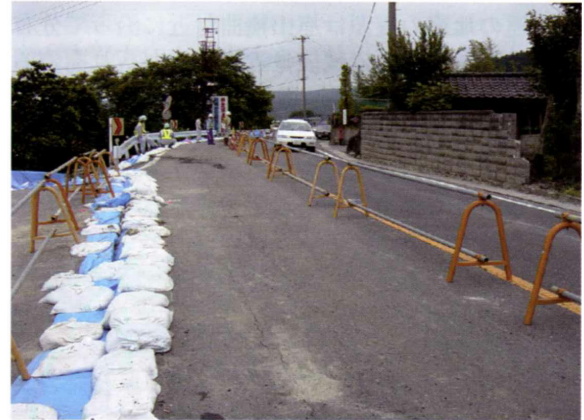
写真 2-7 一般国道 108 号路肩の陥没
