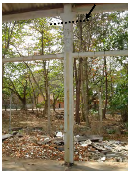
写真-3.22 ゴール港副港長事務所の浸水痕跡 (矢印)
