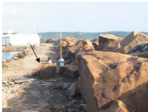
写真-3.15 被災直後の主防波堤の状況及び岩石の崩落状況（矢印）（左：港内側，右：港外側，撮影・日本港湾コンサルタント）
