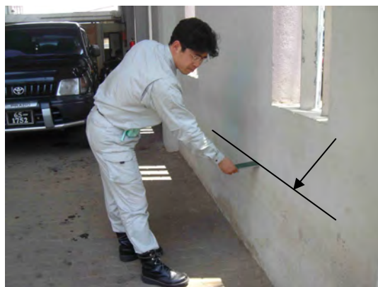
写真-3.23 ゴール地方行政庁舎の浸水痕跡 (矢印)
