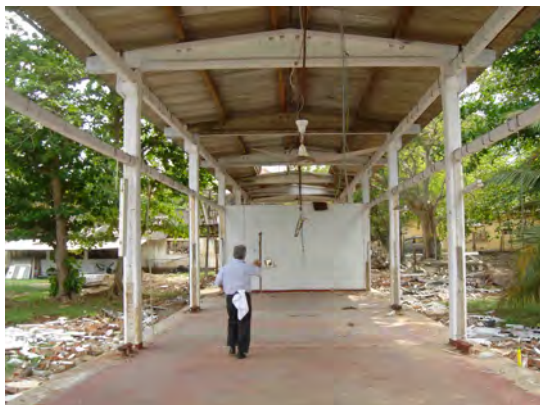
写真-3.21 ゴール港副港長事務所の被害状況
