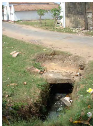
写真-3.20 フォート地区内北側のYMCA付近の排水口
