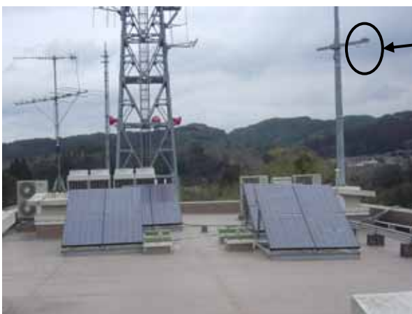
写真 18 亀山ダム管理事務所 日射計
