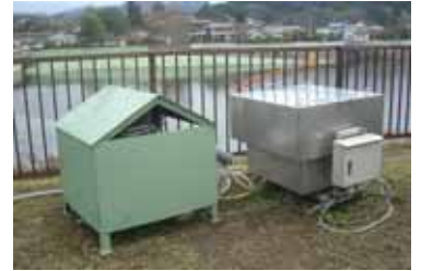
写真 17 左：空気圧縮機 右：計測装置
