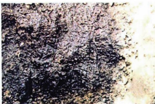
剥離面には水分が存在
