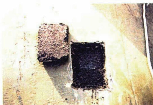
深さ6cmで板状に剥離
