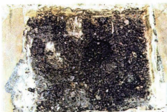
内部は湿潤状態でアスファルト剥離
