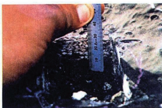
損傷の深さは 3cm 程度
