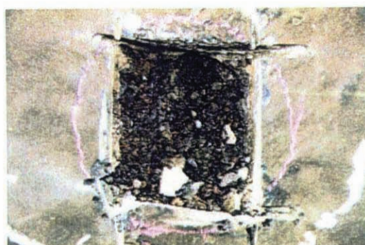
内部は湿潤状態
