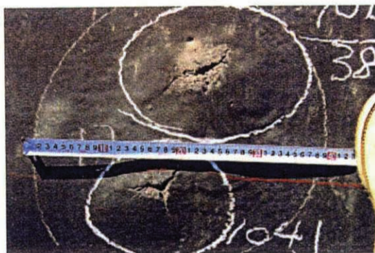
膨れの頂点にクラック有り
