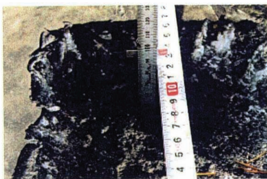
内部に空洞が存在深さ9cm程度
