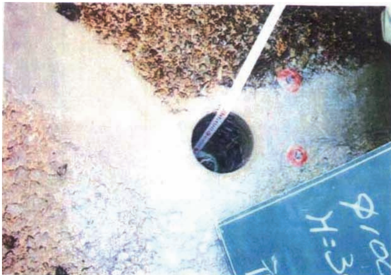
コアー抜き調査。CL0+1.5mコア採取孔内フェノールフタレイン塗布前。
