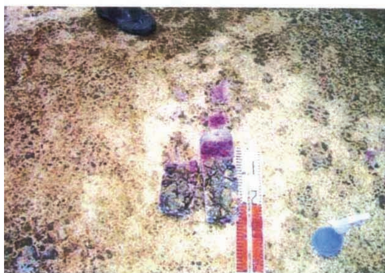
コアー抜き調査。同上コアの亀裂面へのフェノールフタレイン塗布後。発色程度弱い。
