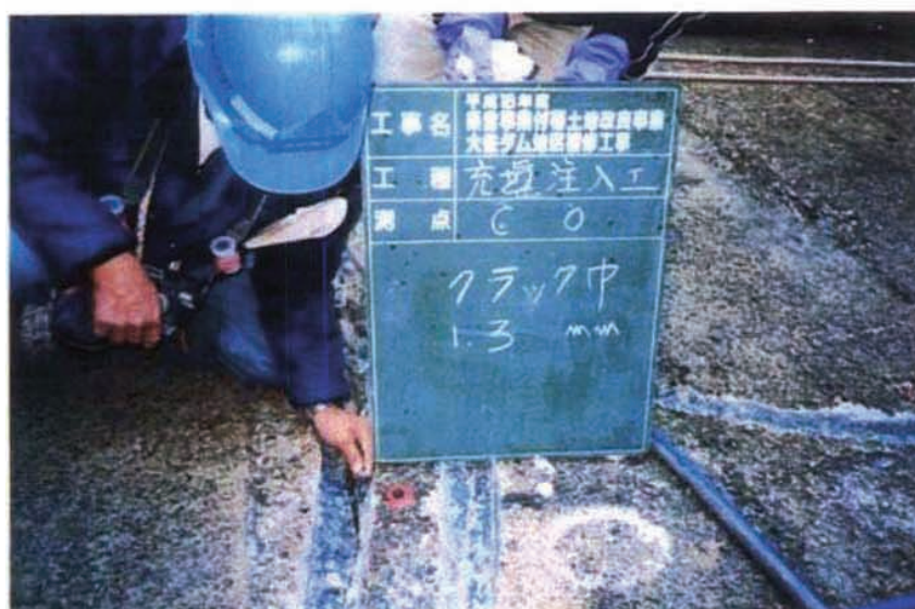
ハツリ後クラック調査(C0)。開口幅1.3mm。
