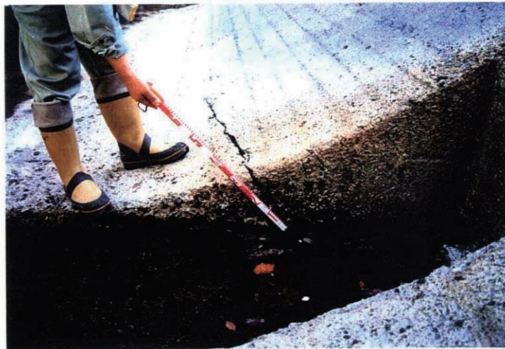
参考写真 副ダム 縦断クラック アバタ変状
