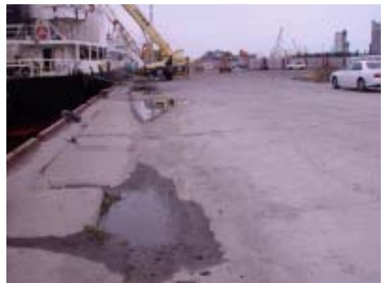
写真-4 エプロンのわだち掘れ (A4港)
