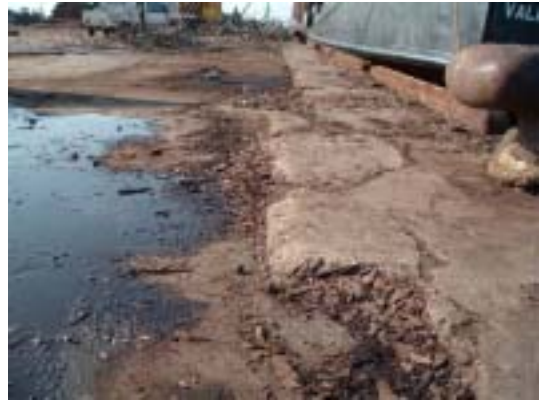
写真-3 エプロン舗装の段差,水溜り (A3港)
