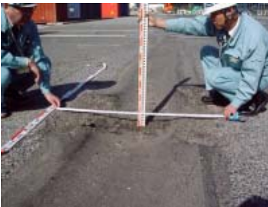
写真-2 RTG 走行路わだち掘れ(A2港)
