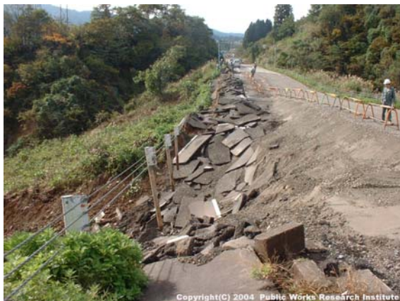
写真 9.2.5 崩壊部の路面状況
