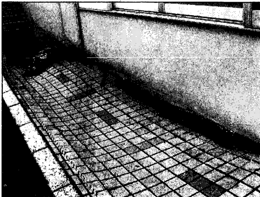
写真 10.41 Cビル周囲の沈下
