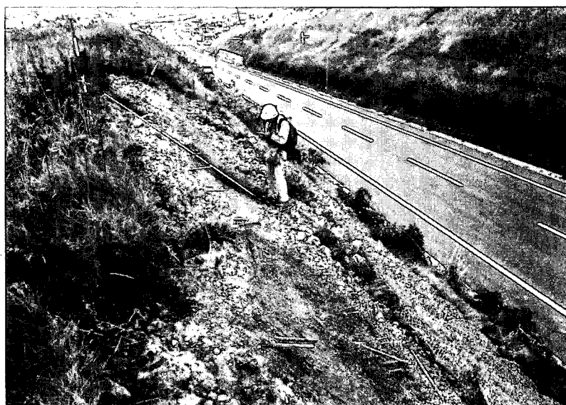
写真 9.3.9 海側切土のり面の崩壊 表層がずり落ち、挿し鉄筋が残留する。
