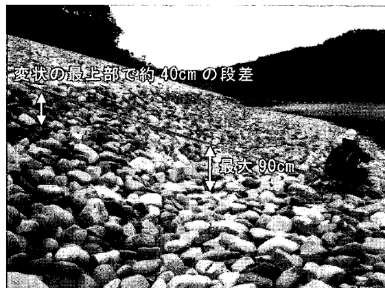
写真 8.2 幕別ダムの保護ロック層変状(拡大)
