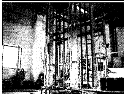
図 3-7 オゾン発生装置(上)と反応塔(下)
