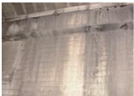
写真-19.7 コンクリート表面を伝う水によって発生した汚れの例
