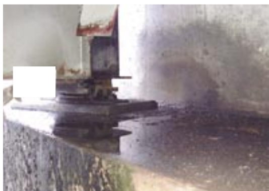
写真-20.4 橋壑に滞水した例
