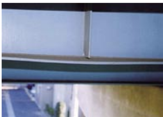
写真-23.7 縦桁の下フランジの変形と亀裂が生じた例
