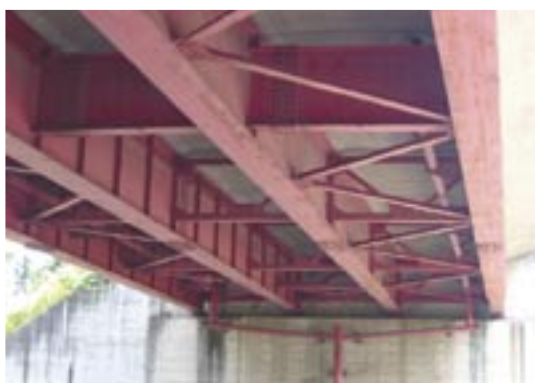
写真-19.5 鋼部材の塗装が変色した例
