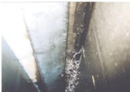
写真-20.1 伸縮装置から漏水が生じた例
