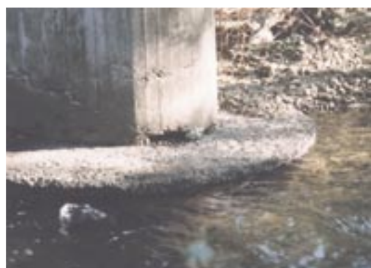
写真-26.3 基礎本体が流水により削られた例
