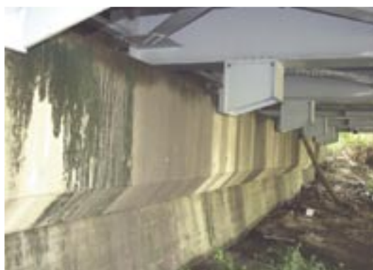
写真-19.8 コンクリート表面を伝う水によって発生した汚れの例
