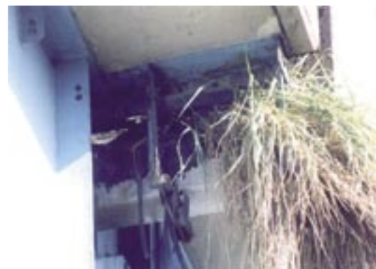
写真-24.6 排水樋に土砂詰りが生じた例
