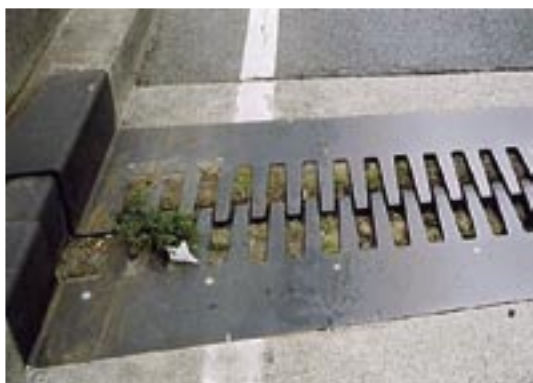
写真-24.5 伸縮装置の遊間に土砂詰りが生じた例
