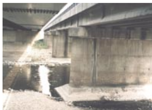
写真-26.2 基礎周辺の土が流水により消失した例
