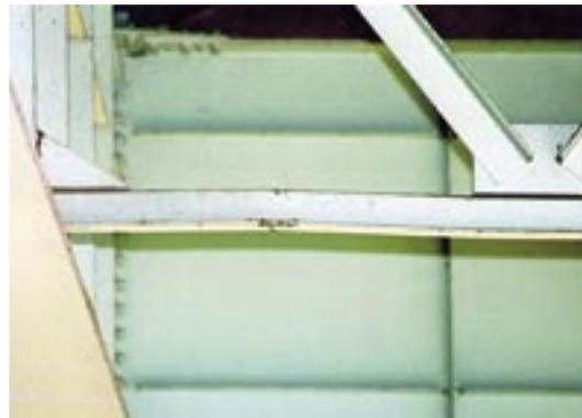
写真-23.2 対傾輻に局所的な変形が生じた例
