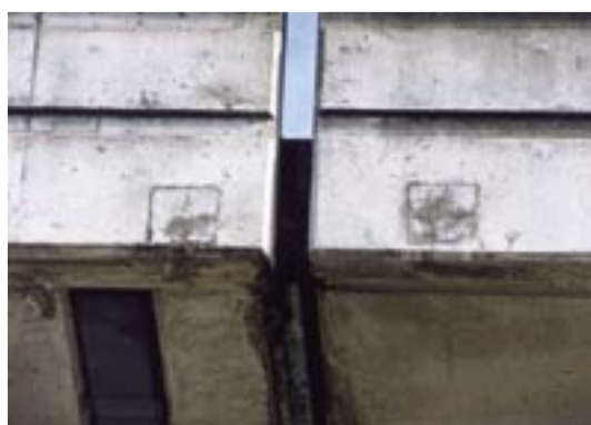
写真-18.1 定着部のコンクリートにひびわれが生じた例
