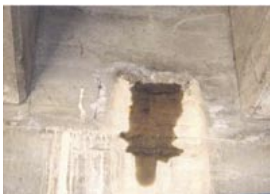
写真-20.6 橋台のコンクリート欠損部から漏水した例
