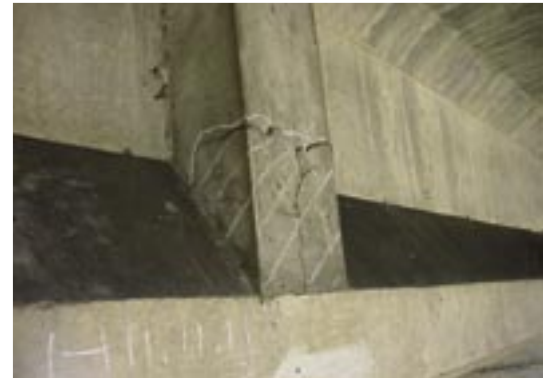
写真-18.8 コンクリートのひびわれ，うきの例 (横締めPC鋼材定着部)
