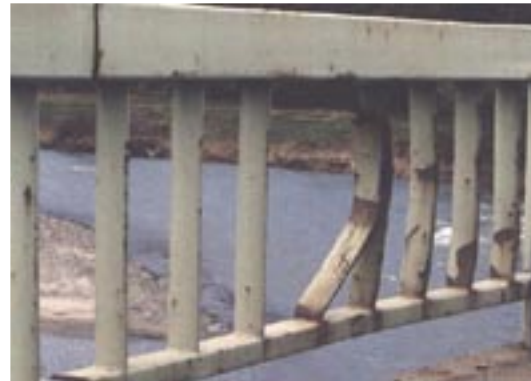
写真-23.10 車両用防護柵に変形と破断が生じた例
