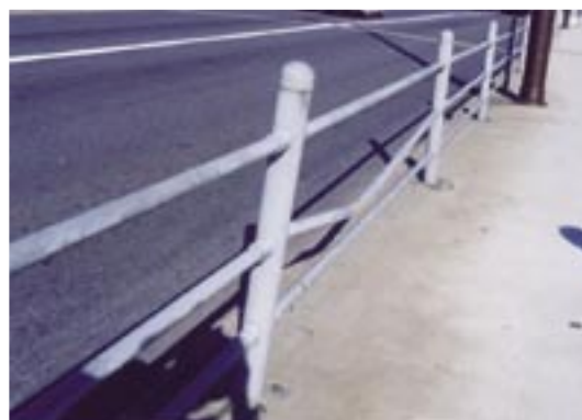
写真-23.4 車両用防衝突柵に変形が生じた例
