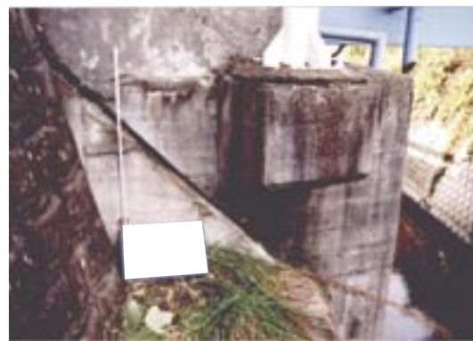
写真-25.4 橋台が移動した例
