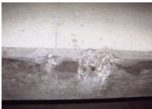
写真-23.3 主桁に欠損が生じた例
