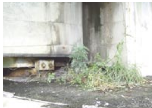
写真-24.4 支承周辺に土砂が堆積した例
