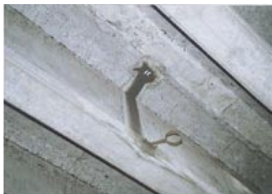
写真-20.10 排水管の脱落の例
