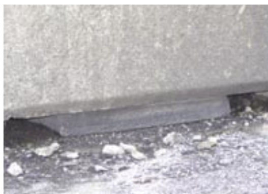
写真-19.4 ゴム支承にひびわれが生じた例
