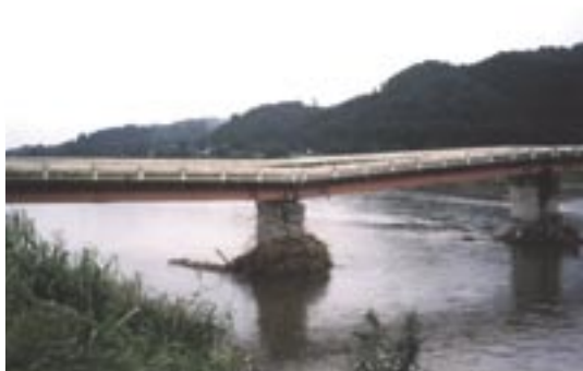
写真-25.3 橋脚が沈下した例
