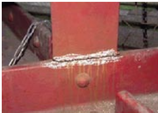
写真-21.5 横溝と吊り材との溶接合部の破損により、異常な音を発生した例
