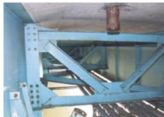
写真-20.11 排水管の脱落の例
