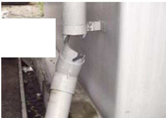
写真-20.8 排水管の破損の例
