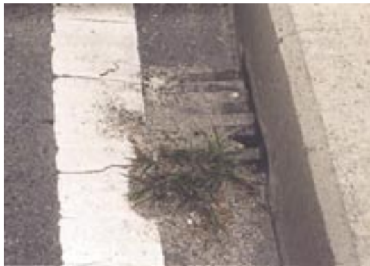
写真-24.1 排水柵に土砂詰りが生じた例
