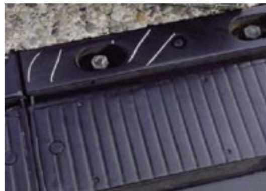
写真-21.6 伸縮装置のボルトのゆるみにより、異常な音を発生した例
