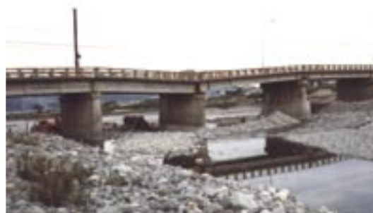
写真-22.2 下部工の異常によって、上部工に異常なたわみが生じた例
