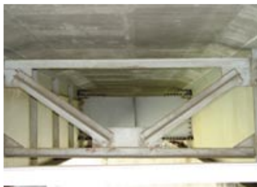
写真-19.6 鋼部材の塗装が変色した例
