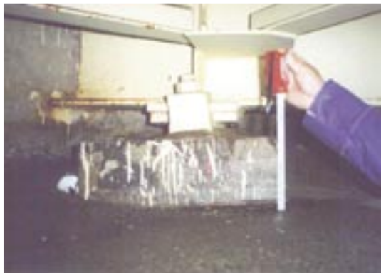
写真-25.1 支承に傾斜が生じた例
