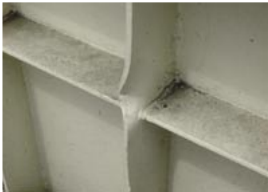
写真-23.1 垂直補剛材に局所的な変形が生じた例
