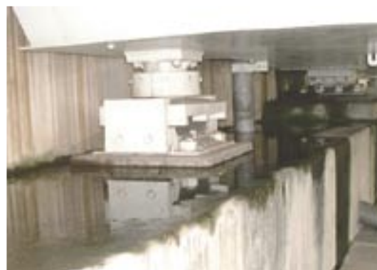
写真-20.5 橋壑に滞水した例
