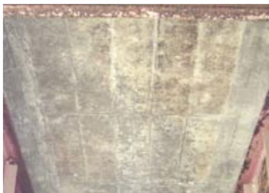
写真-19.1 コンクリート床版に変色が生じた例
