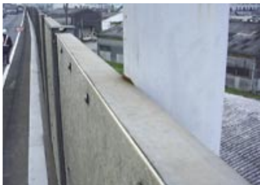
写真-21.1 遮音壁と照明柱が干渉して異常な音が生じた例
