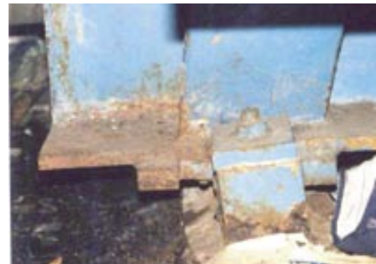
写真-25.9 支承に傾斜と同時に腐食が生じている例
