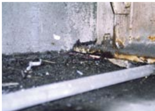
写真-24.3 支承周辺に土砂が堆積した例
