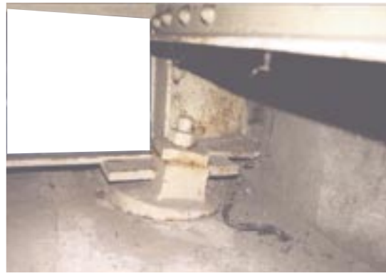
写真-25.2 支承に沈下・傾斜が生じた例
