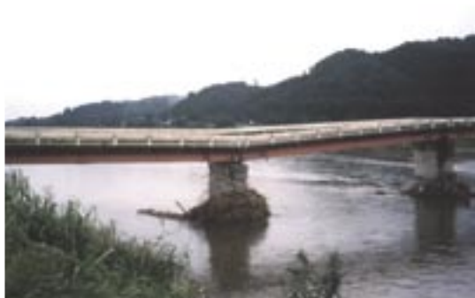
写真-22.1 下部工の異常によって、上部工に異常なたわみが生じた例
