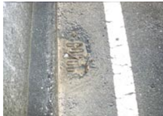
写真-24.2 排水柵に土砂詰りが生じた例
