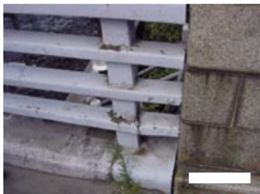
写真-13.11 遊間異常により高欄が損傷が生じた例
