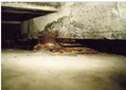
写真-16.3 荷重支持機能が損なわれている恐れがある状態の例
