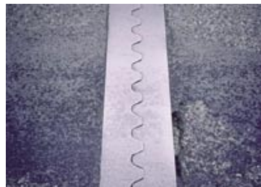
写真-13.4 伸縮装置の遊間が異常に狭い状態の例
