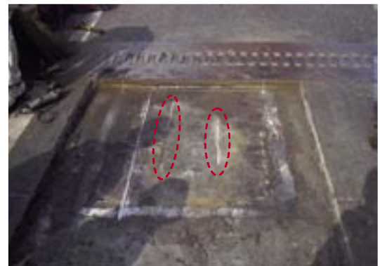
2) 舗装撤去後、鋼材版の亀裂
