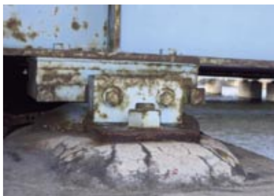
写真-16.9 沓座モルタルの損傷の例
