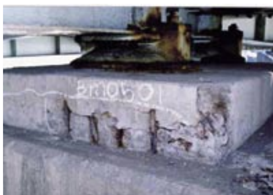
写真-16.11 台座コンクリートの損傷の例
