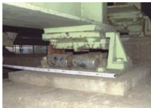
写真-16.6 支承ローラーの脱落の例
