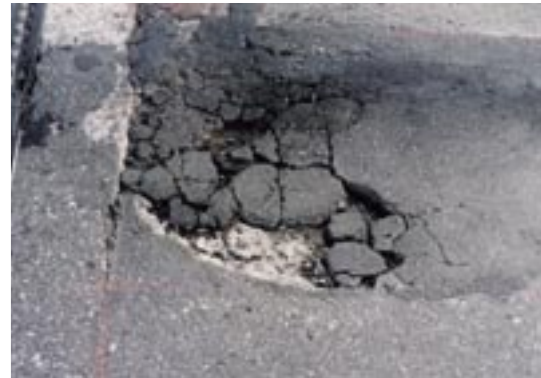
写真-15.2 舗装の陥没の例
