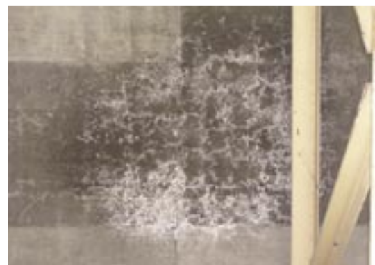
3) 床版下面のひびわれと遊離石灰の滲出
