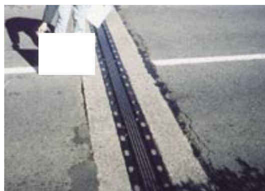
写真-14.9 伸縮装置の後打ち材と舗装との段差の例
