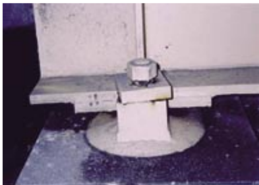
写真-16.7 支承アンカーボルトのゆるみの例
