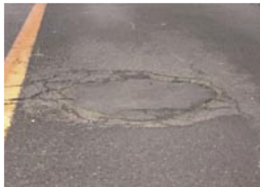
写真-14.6 舗装の陥没の例
