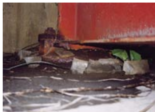
写真-16.10 沓座モルタルの損傷の例
