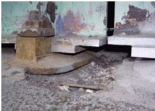
写真-16.1 荷重支持機能を損なわれている状態の例
