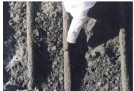
写真-15.4 床版上面のコンクリートの土砂化と同時に鉄筋の腐食、破断が生じた例 (注:舗装撤去している)
