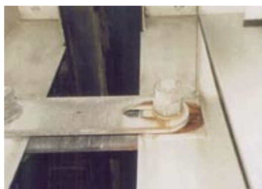
写真-13.10 耐震連結装置の移動状態に偏りが生じた例
