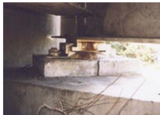
写真-16.12 台座コンクリートの損傷の例
