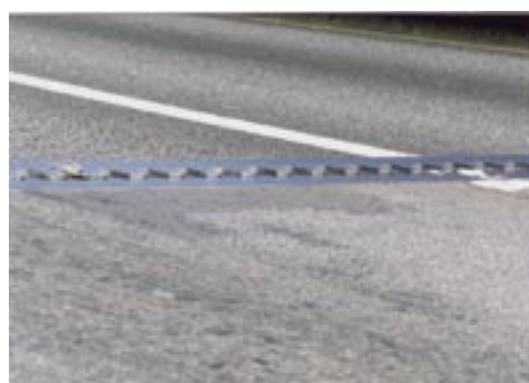
写真-13.8 伸縮装置部に段差が生じた例
