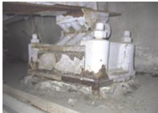
写真-16.2 荷重支持機能を損なわれている状態の例
