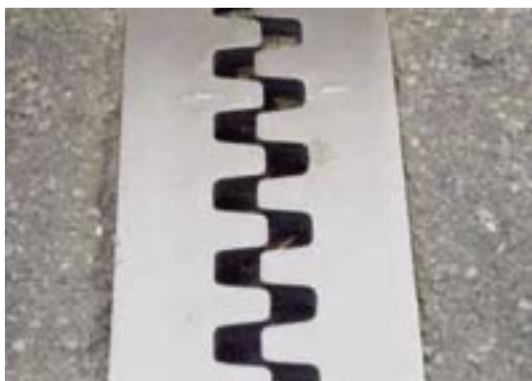
写真-13.3 伸縮装置の遊間が異常に広い状態の例
