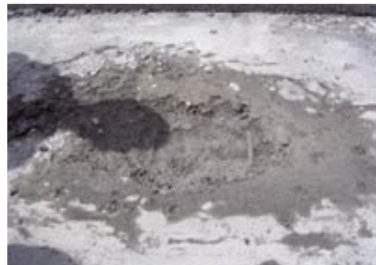
2) 床版上面の土砂化
