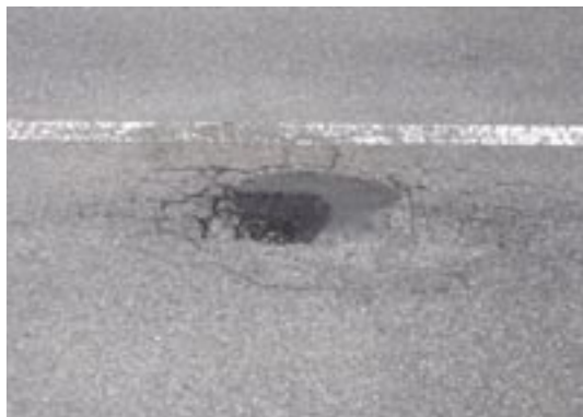
写真-14.5 舗装のポットホールの例
