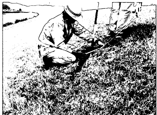
写真5.12 被災直後の釜谷地区、堤防法面にクラック(北上川左岸0.8k~1.4k)
