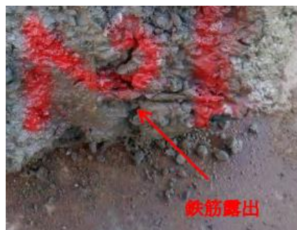
(c) 鉄筋露出状況
