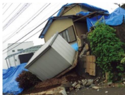
2016 年熊本地震での 建物が近接した擁壁の地震被害
