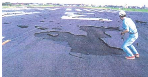
写真-1.1 2000年7月の名古屋空港滑走路の破損
