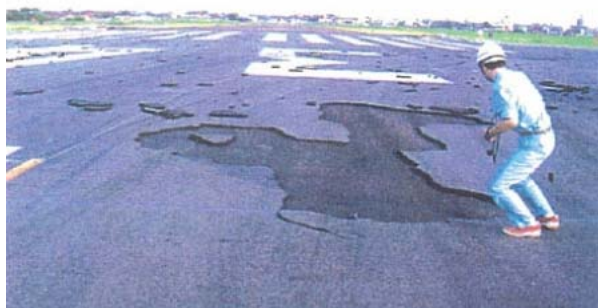
写真-3.1 2000年7月の名古屋空港滑走路の破損
