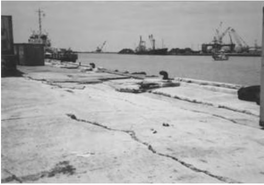
図 2-1 エプロンの沈下・ひび割れ
