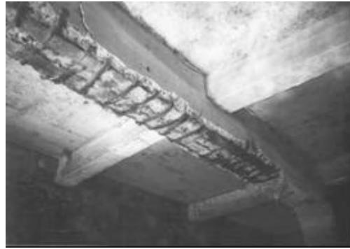
図 2-8② 上部工 梁下面の劣化状況
