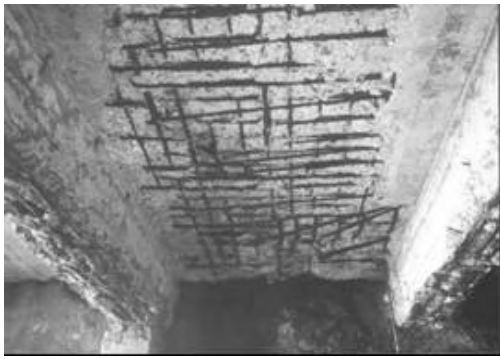
図 2-8① 上部工 床版下面の劣化状況
